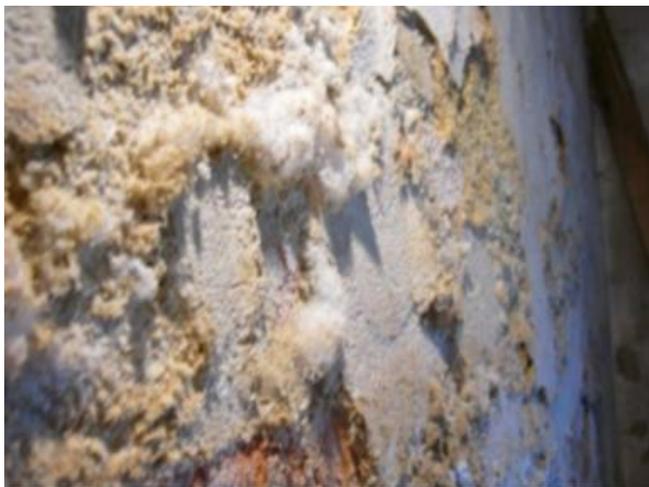
Figura 10: Criptoflorescência em parede de alvenaria (CONSTRUÇÃO CIVIL, 2018)
