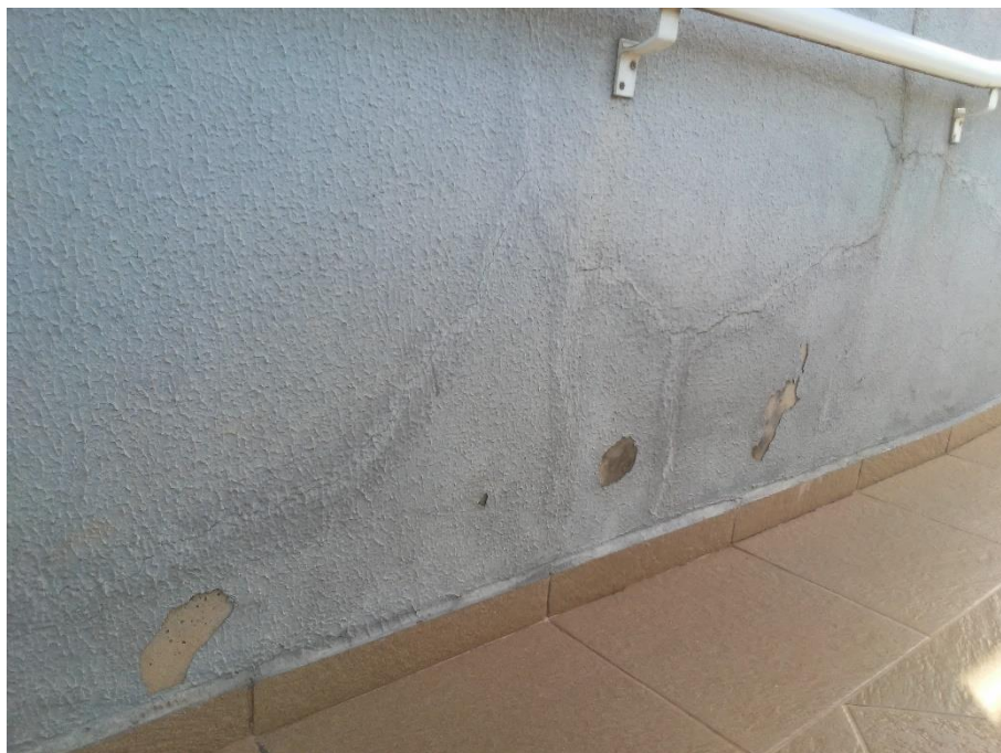
Figura 11: Parede de alvenaria com sinais de umidade ascendente (AUTORES, 2020)
