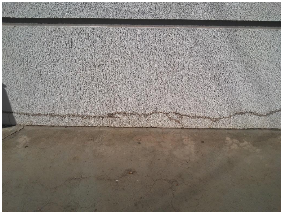
Figura 12: Trinca na base da alvenaria devido à movimentação higroscópica (AUTORES, 2020)
