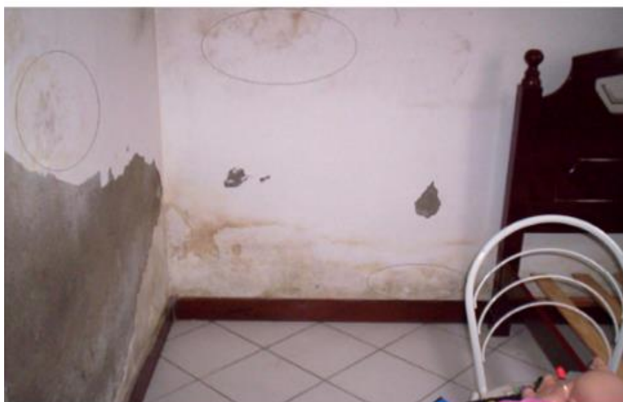
Figura 08: Presença de mofo na parede, devido à umidade ascendente. (MOREIRA, 2010)
