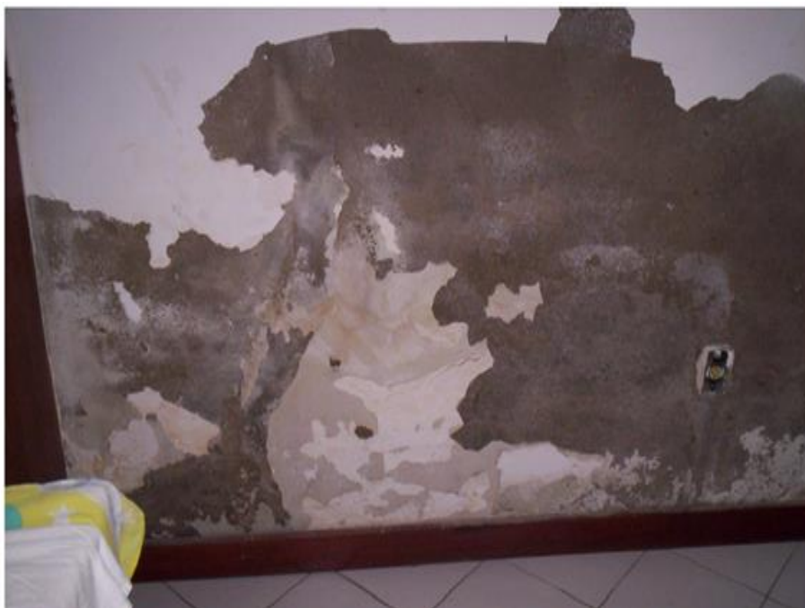
Figura 09: Descolamento da pintura provocado por umidade constante na parede. (MOREIRA, 2010)
