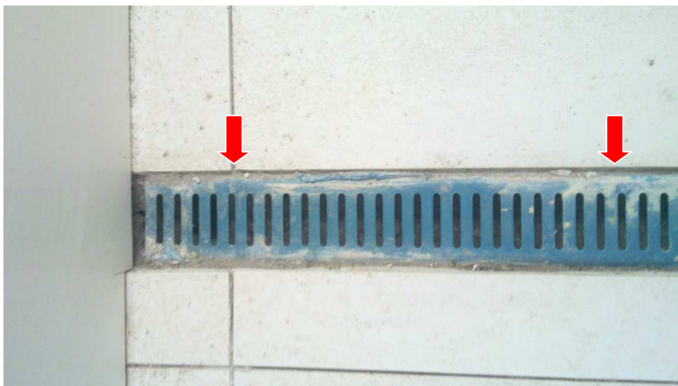
Figura 31 - Seca piso de um dos banheiros da Residência A.P. - os locais indicados serão rejuntados e deve haver cuidado adequado para limpeza do rejunte.
