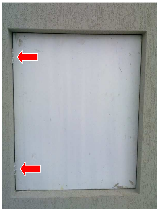
Figura 34 - Alçapão da Torre da Caixa d'água - lubrificar dobradiças periodicamente.
