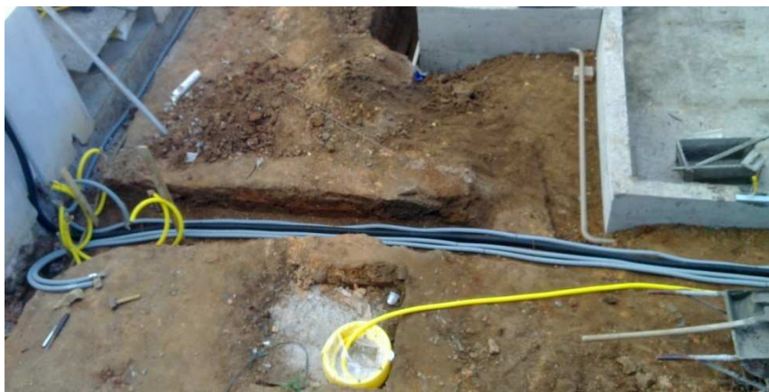
Figura 27 - Disposição das tubulações de instalações elétricas e hidráulicas: registro fotográfico que serve como ferramenta para elaboração do as built.
