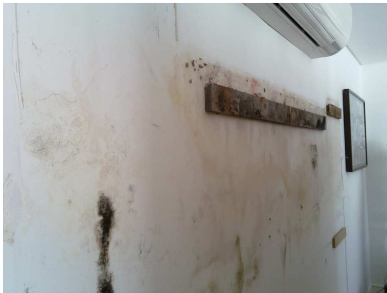
Figura 5 - Parede com manchas de umidade.
