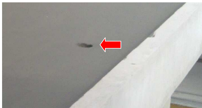
Figura 29 - Manta de resina acrílica da Residência A.P. que envolve o ralo
