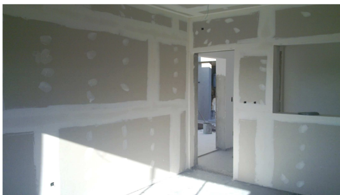
Figura 17 - Estúdio de música: drywall em gesso acartonado utilizado como um dos componentes do isolamento acústico.
