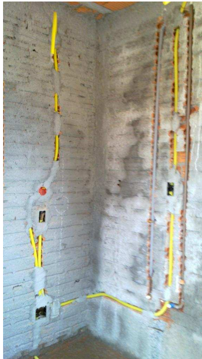
Figura 11 - Paredes do Dormitório de Hóspedes: tubulações de água quente e fria, e eletrodutos da instalação elétrica e hotfloor.
