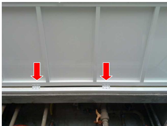
Figura 35 - Tampa da casa de bombas da piscina - lubrificar dobradiças periodicamente.
