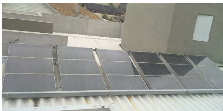
Figura 20 - Painéis para aquecimento solar de água: sobrecarga na cobertura.
