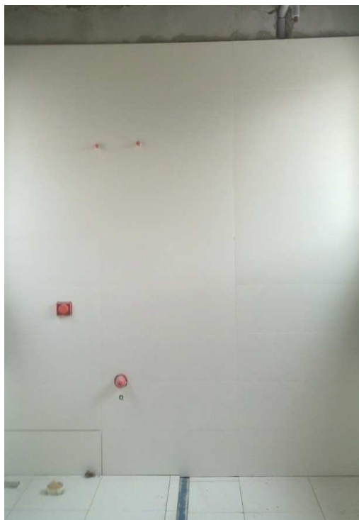
Figura 13 - Dispositivos de manobra aparentes e tubulações ocultas após o revestimento.
