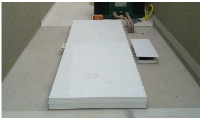
Figura 33 - Tampa da casa de bombas da piscina confeccionada em alumínio - restringir sobrecarga máxima.
