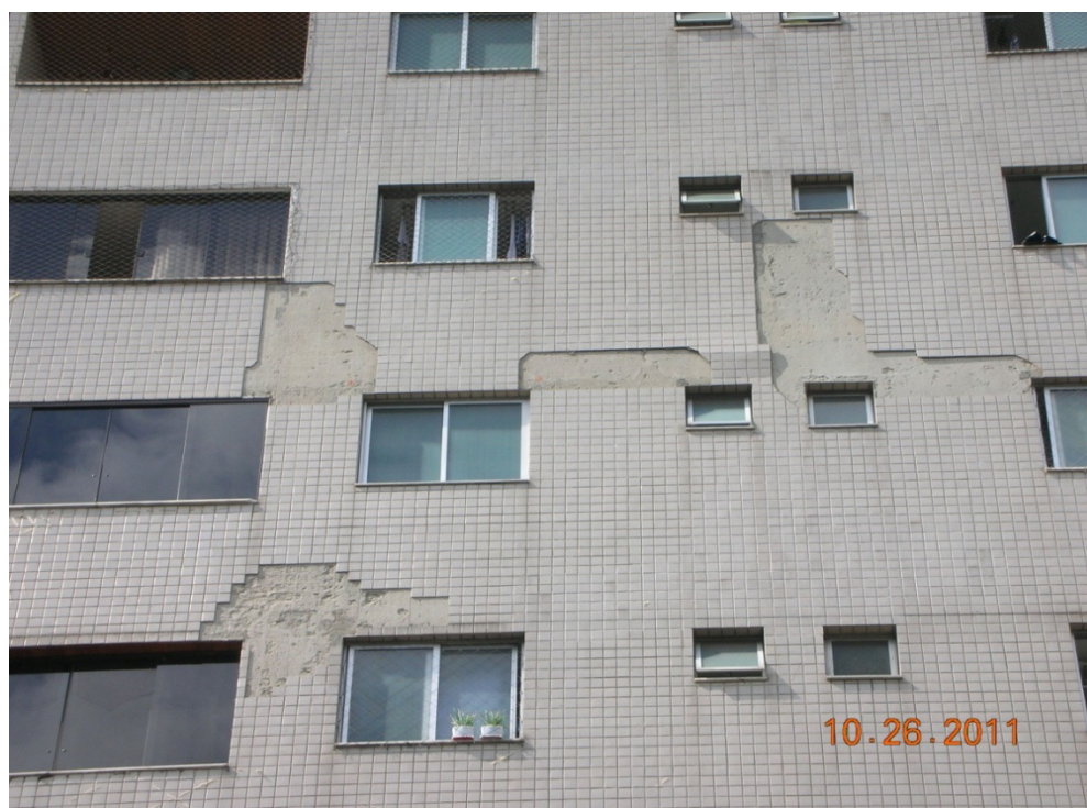
FIGURA 9 – Destacamento de cerâmica em fachada de um edifício em Belo Horizonte (arquivo do autor)
