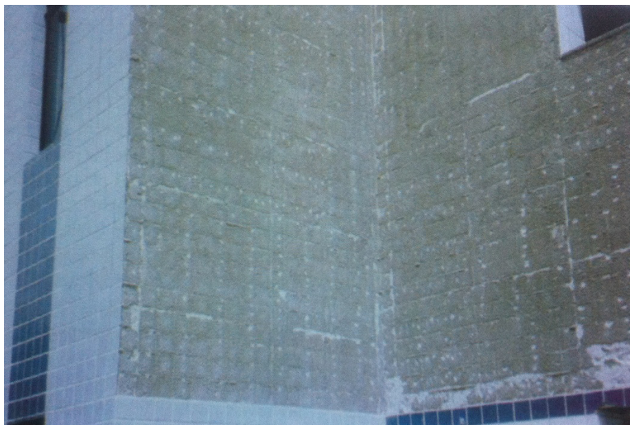
FIGURA 3 – Queda das placas cerâmicas de fachada de edifício em que a camada de fixação aderiu à superfície do emboço
