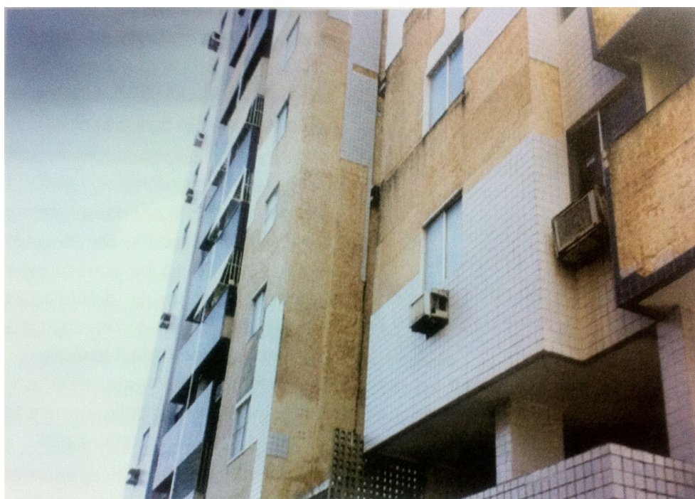
FIGURA 2 – Queda de placas cerâmicas e da camada de fixação da fachada de edifício por falha na interface da camada de fixação-superfície do emboço
