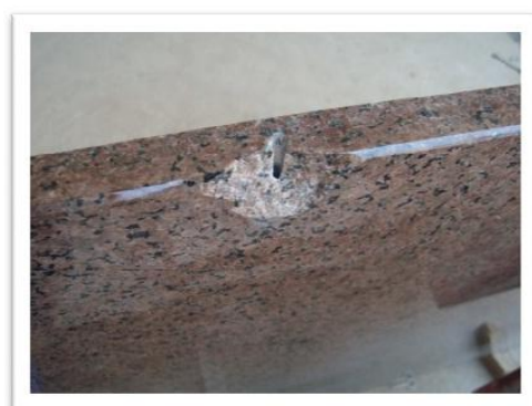
Foto nº 06 – Ruptura localizada da placa
