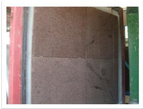
Foto nº 02 – Revestimento não aderido
