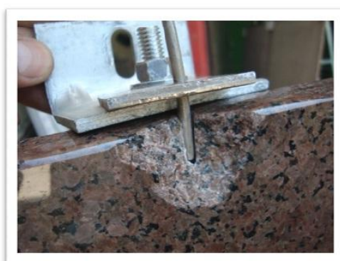
Foto nº 07 – Detalhe da ruptura
