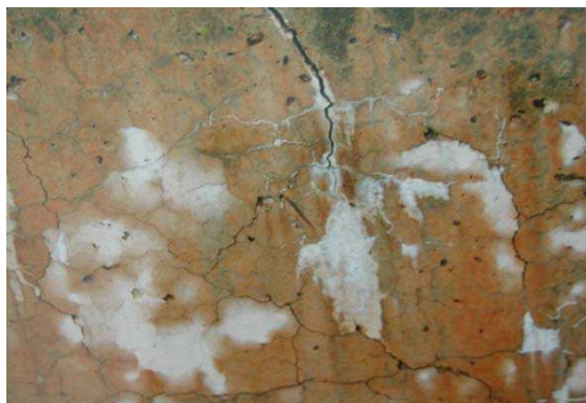
Figura 2.5. Aspecto de concreto deteriorado por ataque de sulfetos. FONTE: Takagi (2008)
