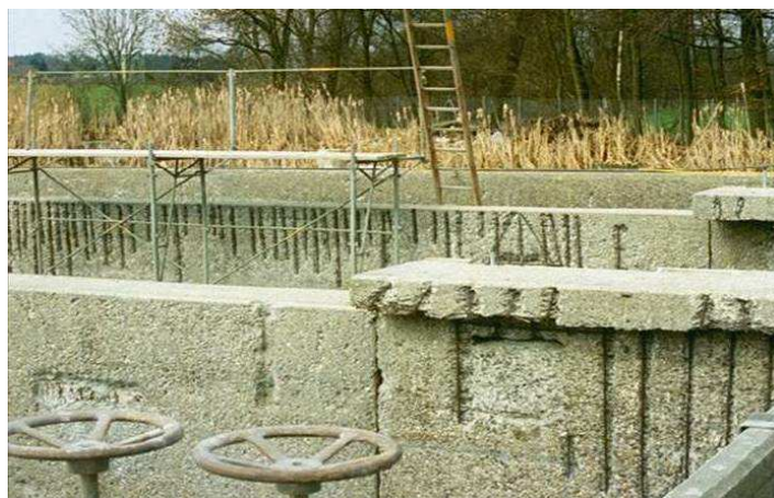
Figura 2.4. Aspecto de ataque por ácido sulfúrico biogênico FONTE: Takagi (2008)
