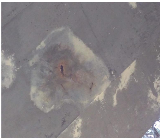
Figura 22. Corrosão de armadura branda (Os Autores, 2020)
