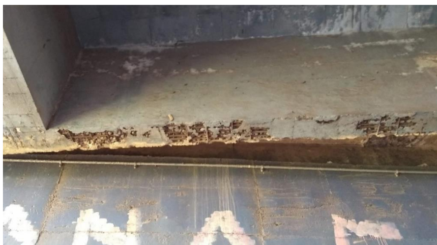
Figura 29. Vazios de concretagem observados no viaduto nº13 - Av. Pres. Affonso Camargo x Linha Verde (Os Autores, 2020)
