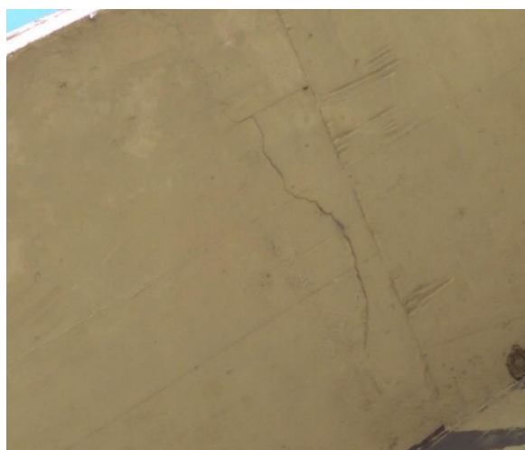
Figura 27. Fissura observada na laje do viaduto nº4 - Rua Deputado Heitor Alencar Furtado X Rua Luiza Mazetto Baggio
