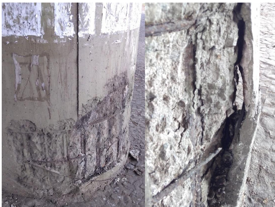
Figura 21. Grave processo de corrosão de armadura e deslocamento do concreto nos pilares do viaduto nº12 - Av. Vitor Ferreira do Amaral X Linha Verde (Os Autores, 2020)
