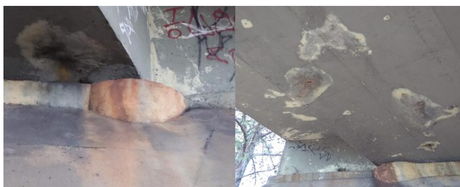
Figura 25. Infiltrações e eflorescências observadas nas lajes do viaduto nº 1 - Rua Deputado Heitor Alencar Furtado x Rua João Falarz (Os Autores, 2020).
