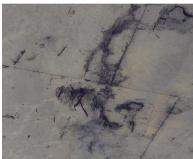
Figura 20. Detalhe do rompimento de armadura na laje do Viaduto nº11 - Av. Vitor Ferreira do Amaral x Av. Nossa Senhora da Luz (Os Autores, 2020)
