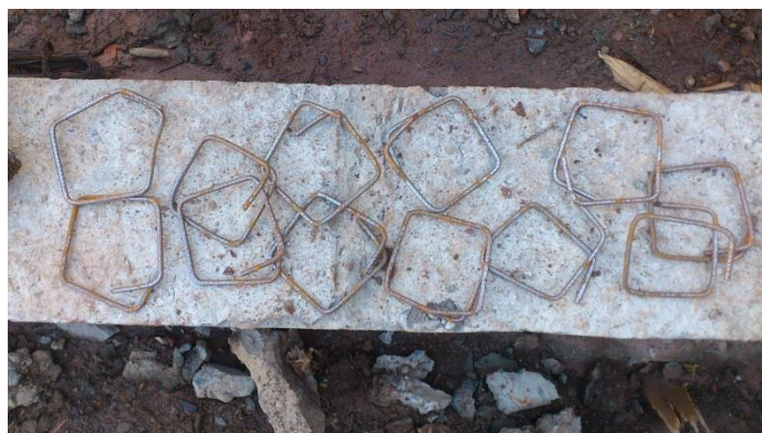
Figura 15: Aço cortado e dobrado industrialmente fora de especificação (Fonte: O autor)
