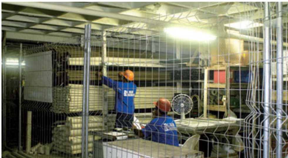
Figura 18 – Divisão de ambientes com estrutura em tela
