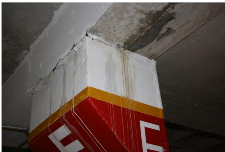
Figura 25- Falha na impermeabilização em junta de dilatação. Fonte: Autores, 2012.
