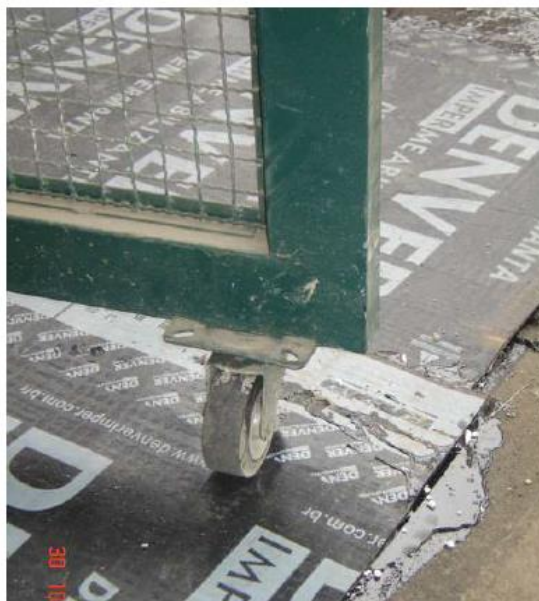
Figura 27. Uso inadequado em lajes com manta asfáltica.
