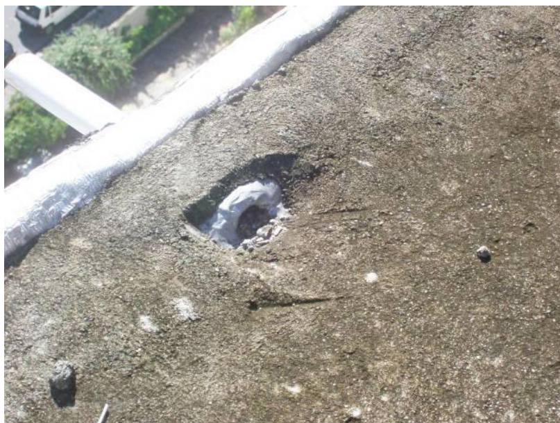
Figura 2. Falha no detalhamento. Fonte: CINPAR, 2010.
