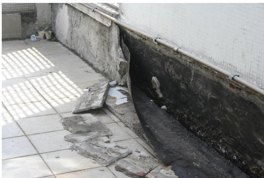
Figura 29. Deslocamento da manta asfáltica na altura do rodapé. Fonte: Autores, 2012.
