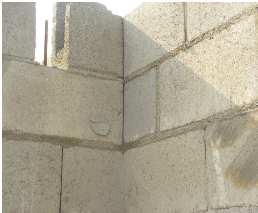
Figura 2 - Evidenciando a falta de pilares e vigas.
