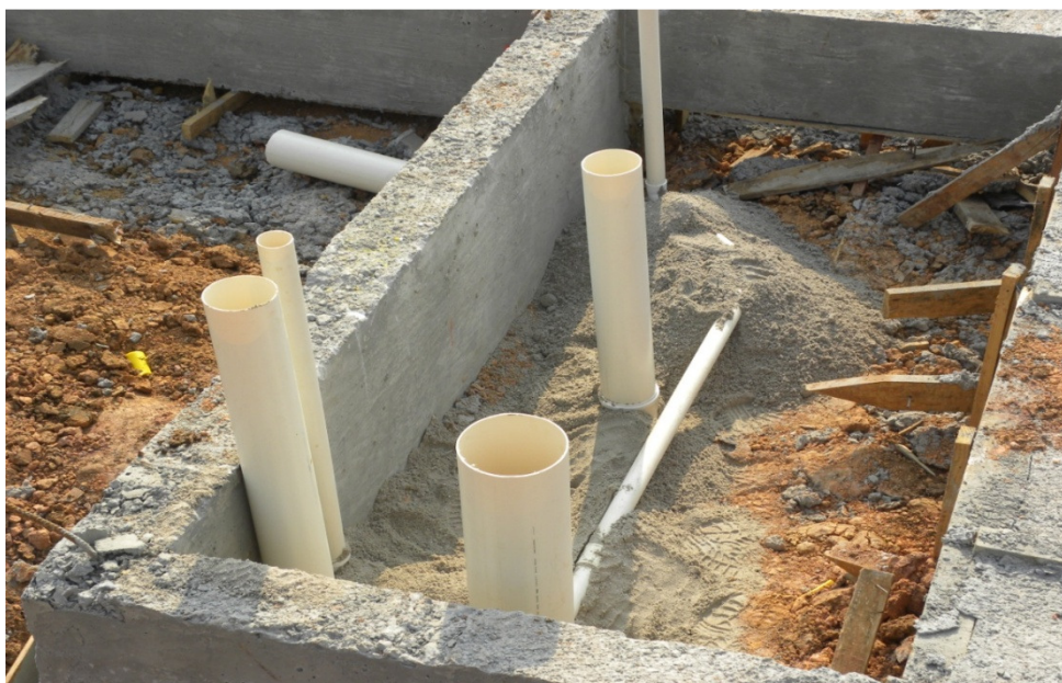
Figura 17 – Instalação hidráulica enterrada.
