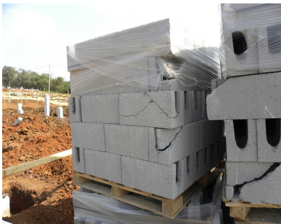
Figura 13 – Blocos trincados, fissurados ou quebrados.
