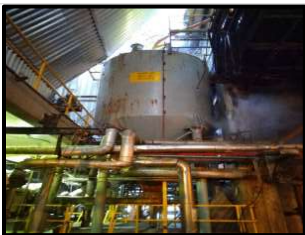
FIGURA 40. Vista do silo de armazenagem de sulfato utilizada no processo
