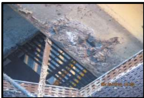
FIGURA 62. Desplacamento e processo de corrosão do aço
