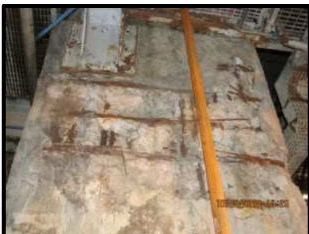
FIGURA 54. Deslocamento do concreto causado pela expansão do aço
