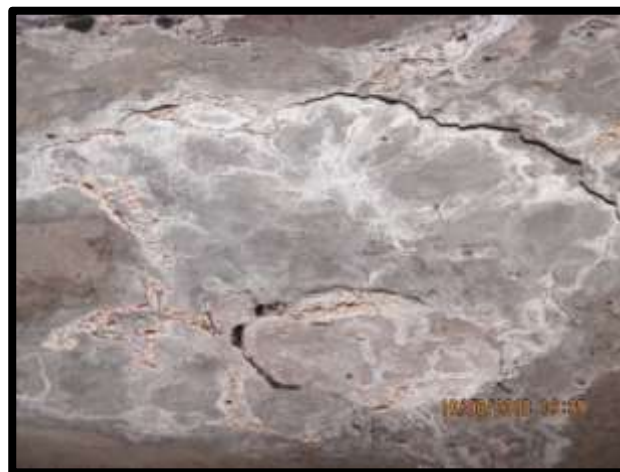
FIGURA 51. Eflorescência e contaminação do concreto com características de ataques por sulfatos
