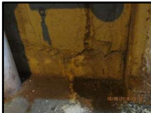
FIGURA 53. Degradação concreto possivelmente por agentes químicos.
