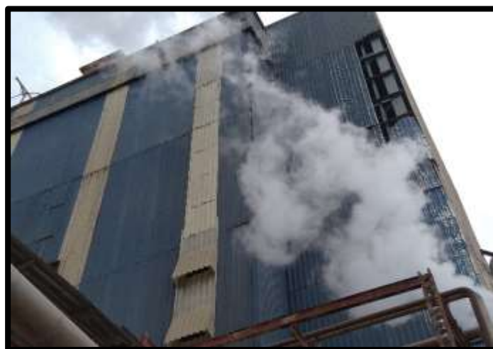
FIGURA 39. Vista frontal da Caldeira B
