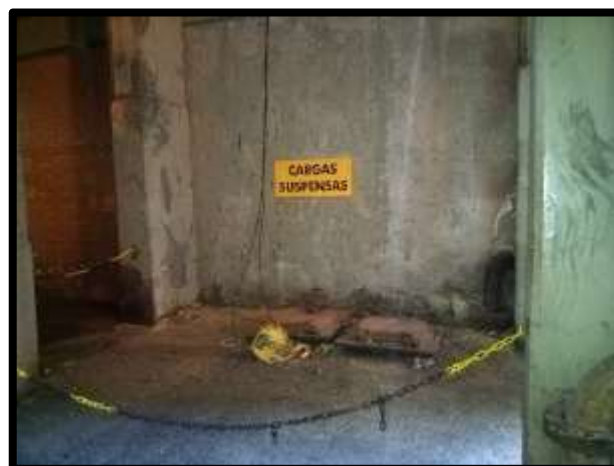
FIGURA 43. Deslocamento do concreto.
