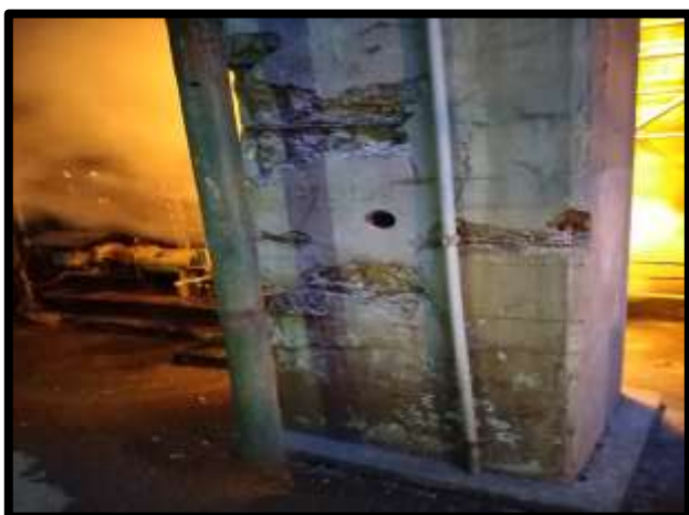
FIGURA 42. Deslocamento do concreto e perda seção de aço
