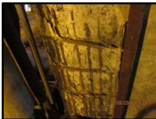
FIGURA 59. Desplacamento do concreto com exposição das amaduras
