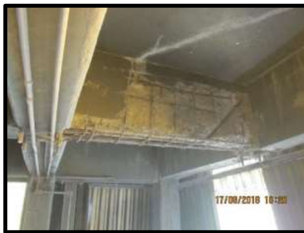
FIGURA 45. Deslocamento do concreto causado pela expansão do aço
