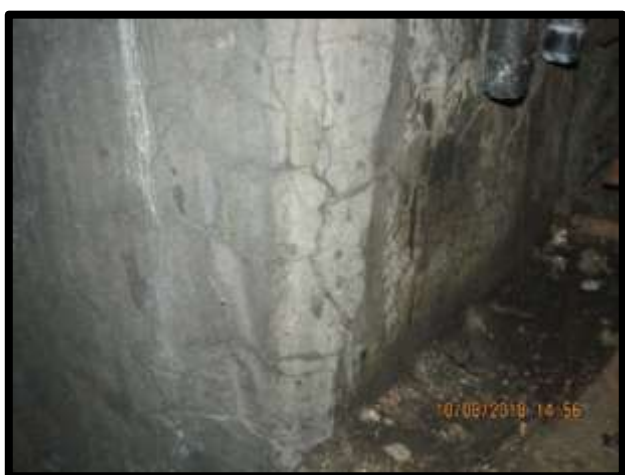
FIGURA 56. Diversas fissuras e impregnação de produtos químicos
