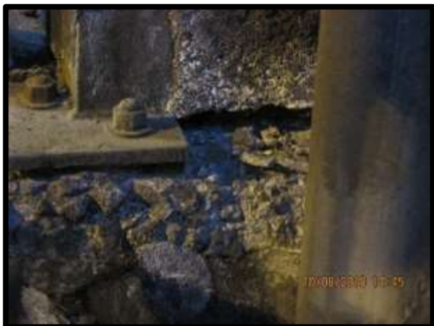
FIGURA 48. Concreto com características de ataques por sulfatos
