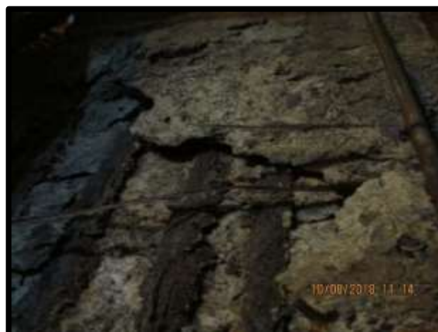
FIGURA 55. Verifica-se visualmente concreto contaminado por sulfatos.
