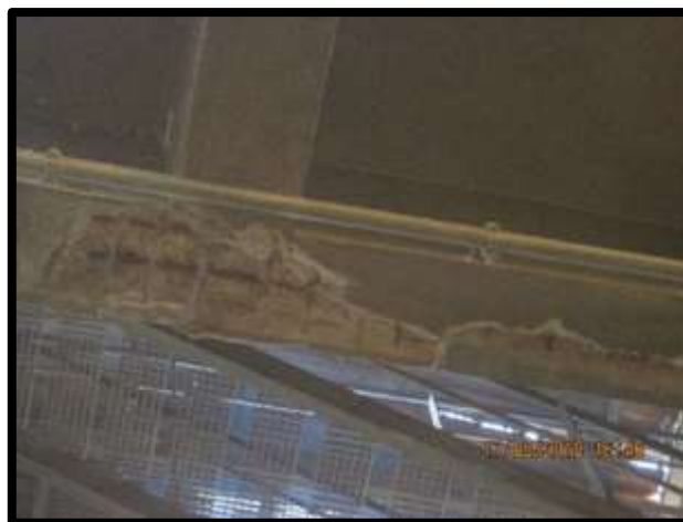
FIGURA 47. Deslocamento do concreto.
