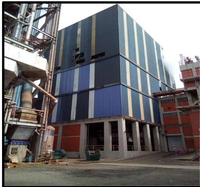
FIGURA 38. Vista frontal da Caldeira A.
