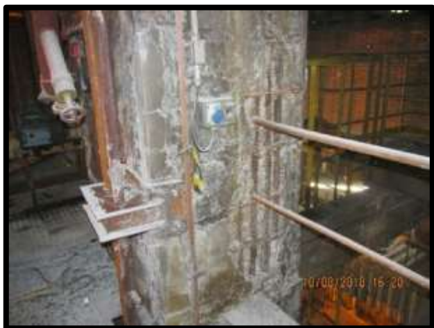
FIGURA 50. Deslocamento do concreto causado pela expansão do aço
