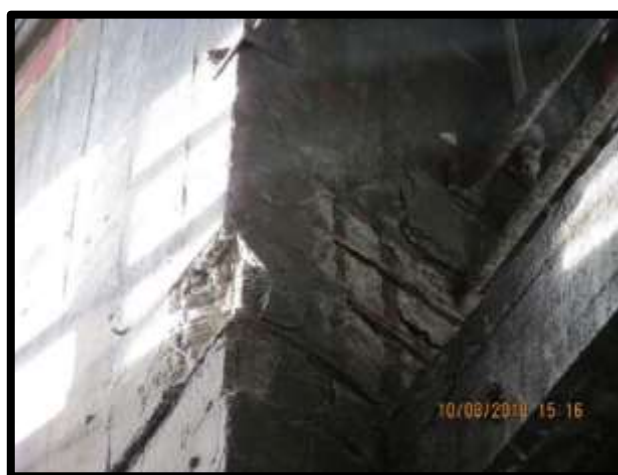
FIGURA 57. Degradação do concreto com perda de seção de armadura.
