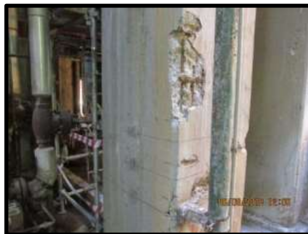
FIGURA 61. Desplacamento do concreto causado pela expansão do aço,
