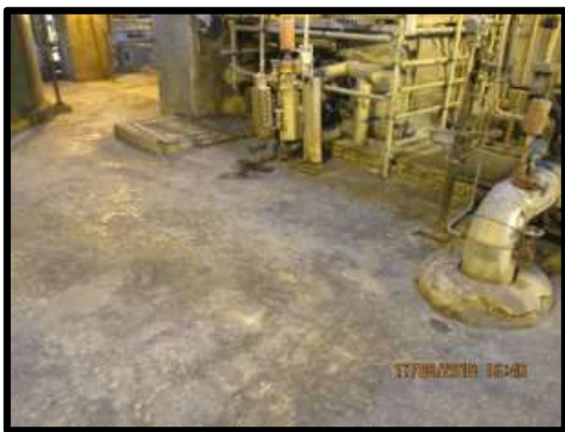
FIGURA 44. Degradação do piso da laje
