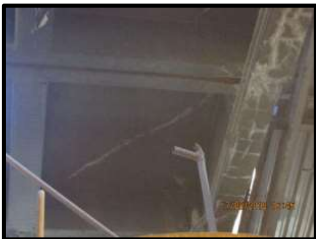
FIGURA 46. Fissura e Lixiviação de laje e vigas
