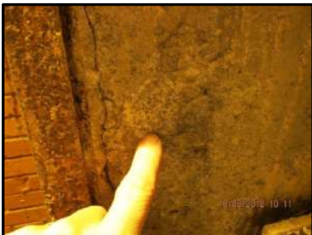
FIGURA 52. Deslocamento e degradação superficial
