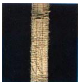
Superfície apresentando desgaste excessivo.
