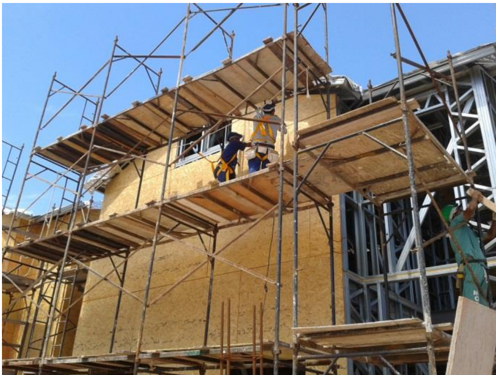
Foto 48 – Ausência de proteção periférica nos andaimes fachadeiros.
