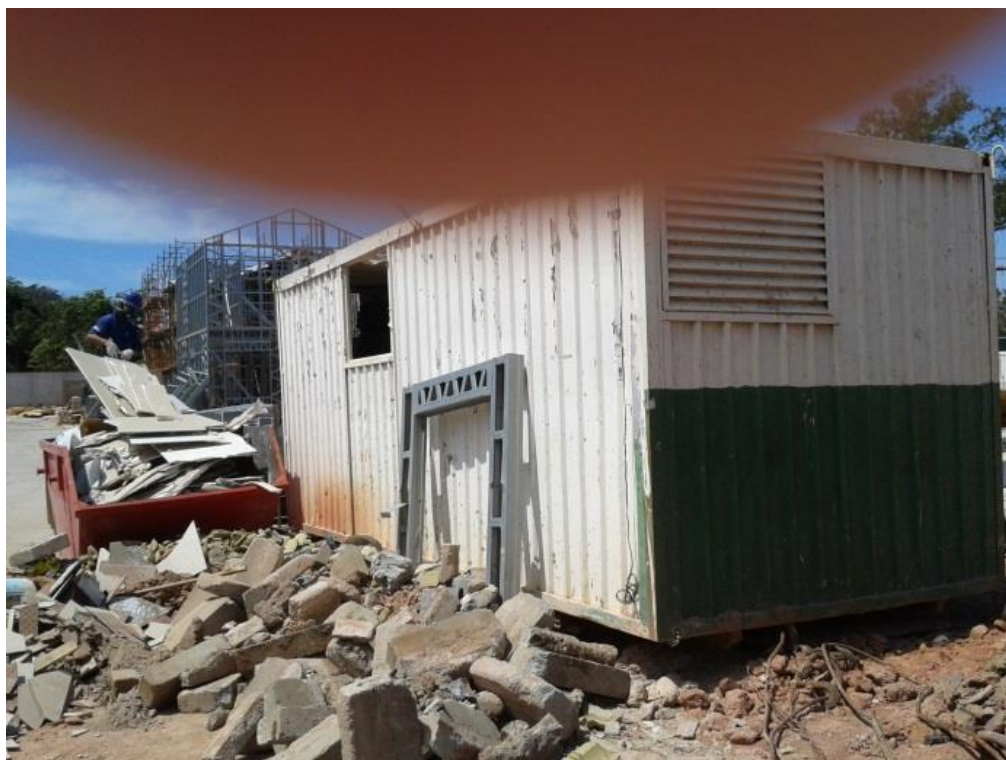
Foto 55 – Entulho fora de caçambas.
