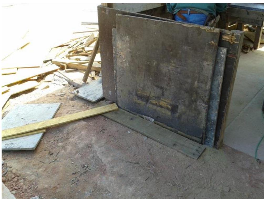
Foto 58 – Carpintaria madeira espalhada pelo chão e uma grande quantidade de pregos pelo chão.
