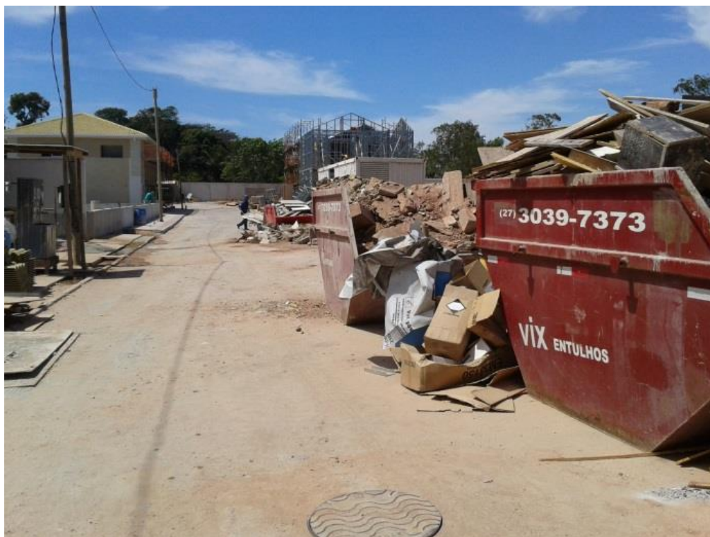
Foto 57 – Entulho fora de caçambas e abarrotadas.
