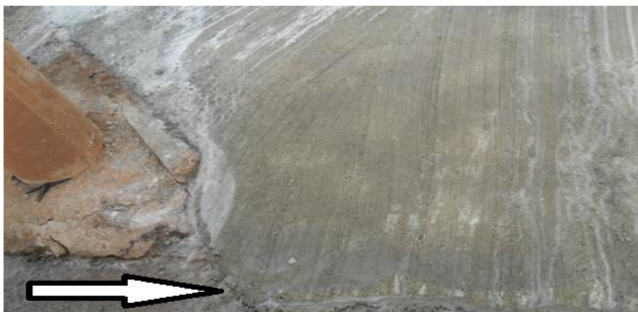
Figura 13 – Início do descolamento no terceiro dia após a concretagem
