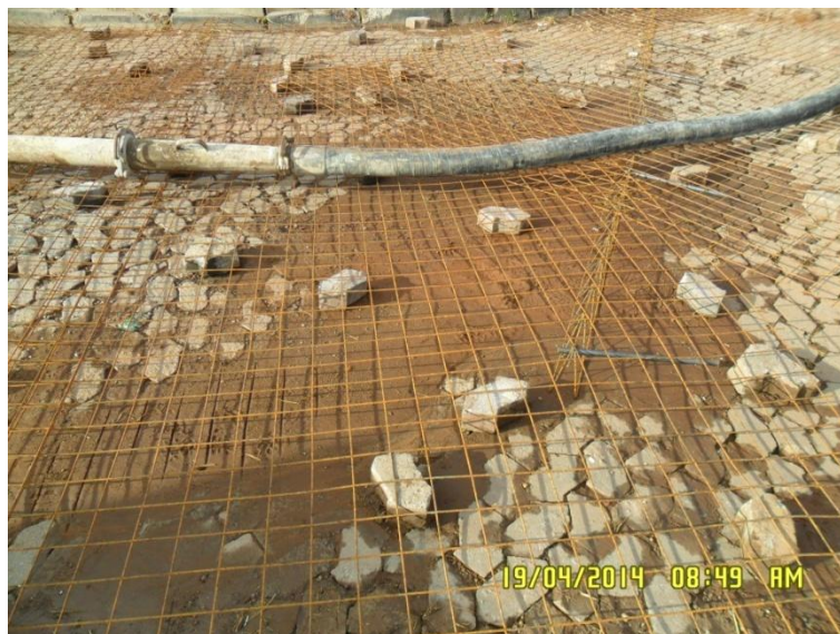
Figura 5 – Superfície com armadura
