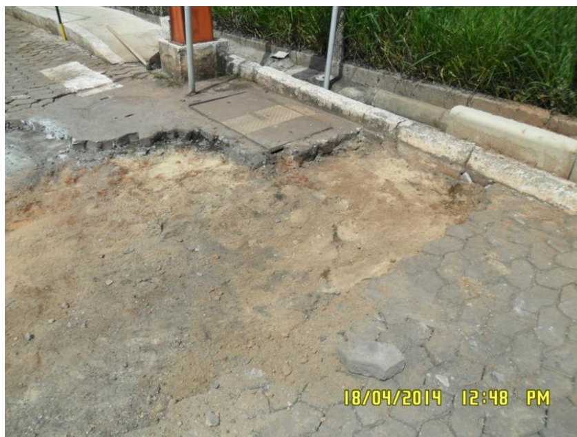
Figura 3 – Pavimento com deformidades
