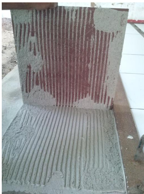
Figura 34 – Argamassa colante aplicada apenas no contrapiso sem cruzamento dos cordões após arrancamento (amostra 3).
