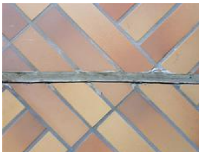
Figura 4 – Deterioração das juntas.
