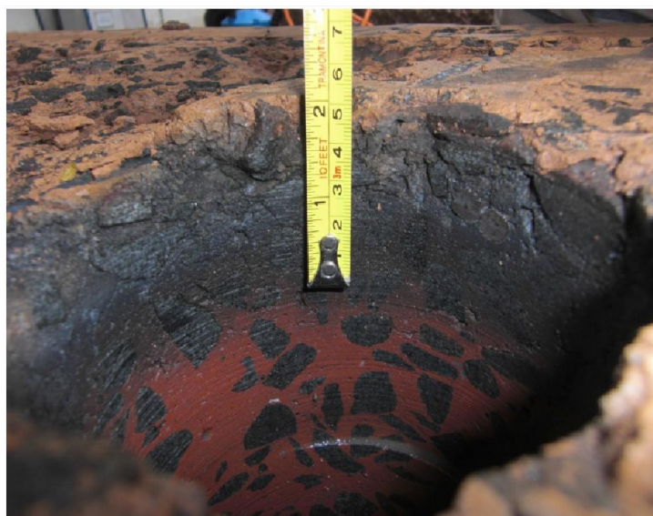
Figura 14 – Detalhe da alteração de cor promovida pela reação química de redução do óxido de ferro nos primeiros 55 mm de profundidade do elemento de concreto (BRITEZ, 2011)
