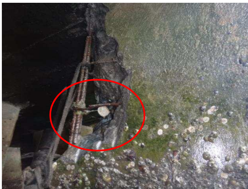
Figura 26 – Detalhe do ânodo que foi removido presente na estaca E-324 (Acervo pessoal, 2014).
