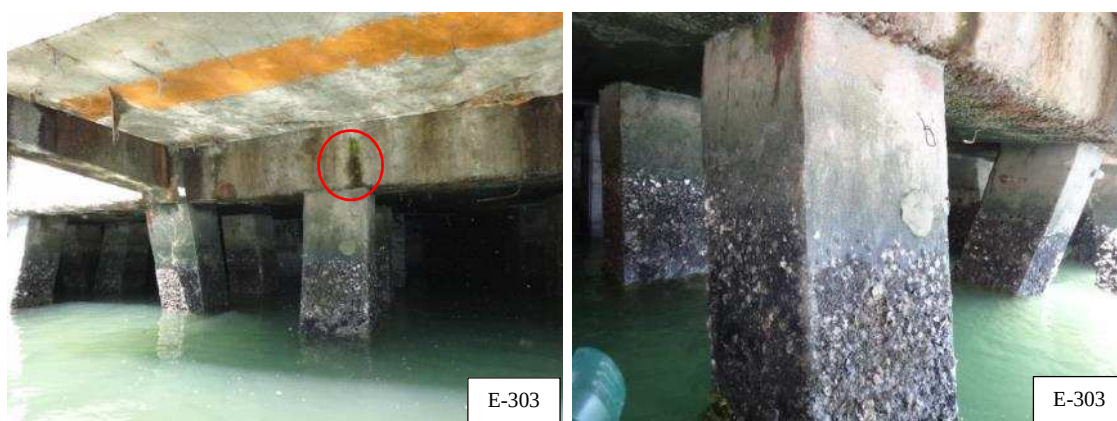
Figura 31 – Vista geral da estaca E-303, sem anomalias aparentes, porém com infiltração na parte superior, com presença de limo e fungos (Acervo pessoal, 2014).
