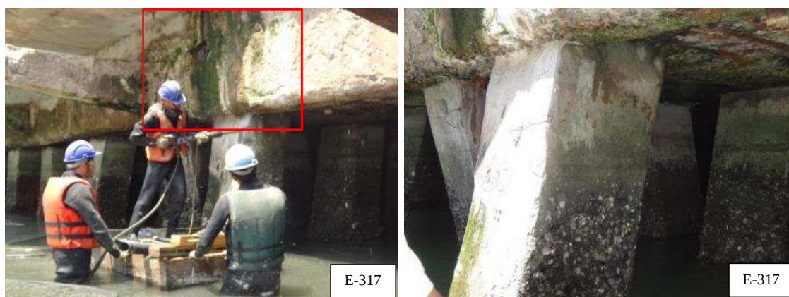
Figura 29 – Estaca E-317, sem anomalias aparentes na estaca, porém com infiltração na parte superior, com presença de microrganismo (fungos e limo) (Acervo pessoal, 2014).
