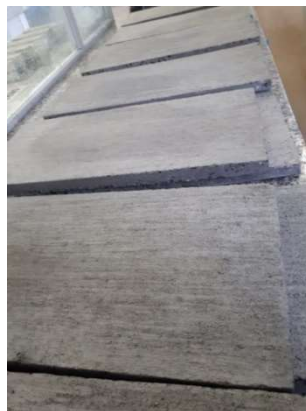
Figura 10: Placas padrão regularizada
