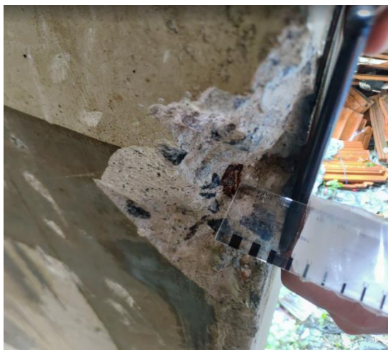
Figura 24 – Fotos ensaio de carbonatação nº 01 – Avaliação da frente carbonatada. Fonte: Autores
