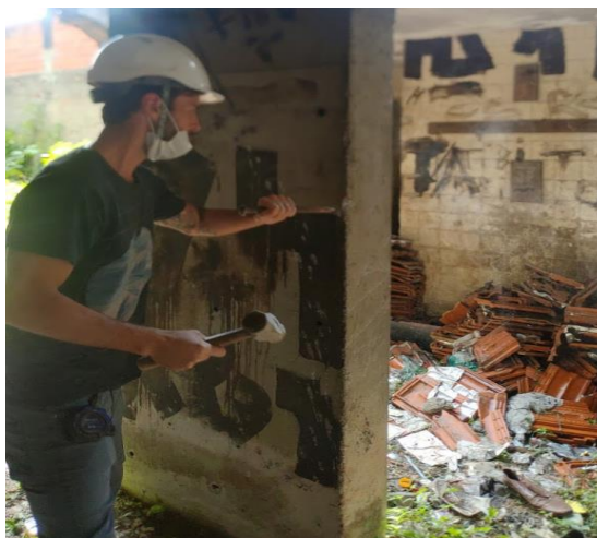
Figura 22 – Fotos ensaio de carbonatação n° 01 – Abertura da quina para se chegar à parte interna do elemento.
