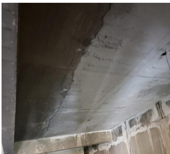
Figura 41 – laje do 1º sobressolo (2º pavimento em relação ao nível da rua) com fissuração contínua em larga escala e sinais de lixiviação. Fonte: Autores
