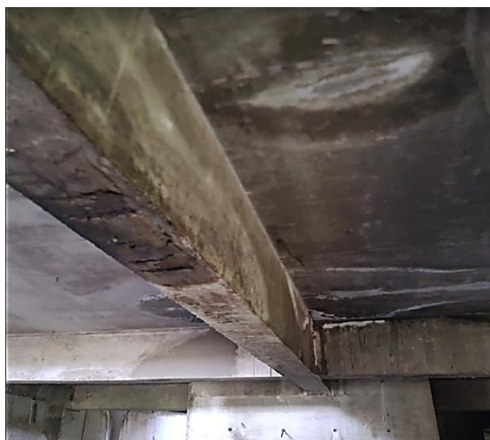
Figura 35 – Viga do pavimento do 2º sobressolo com presença de micro-organismos e deslocamento do concreto.
