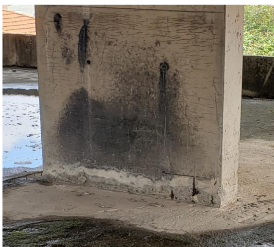
Figura 32 – Imagem do pilar localizado no pavimento 2 pavimento tipo (5º pavimento em relação ao nível da rua) com manchas de fuligem além da corrosão das armaduras e deslocamentos do concreto. Fonte: Autores
