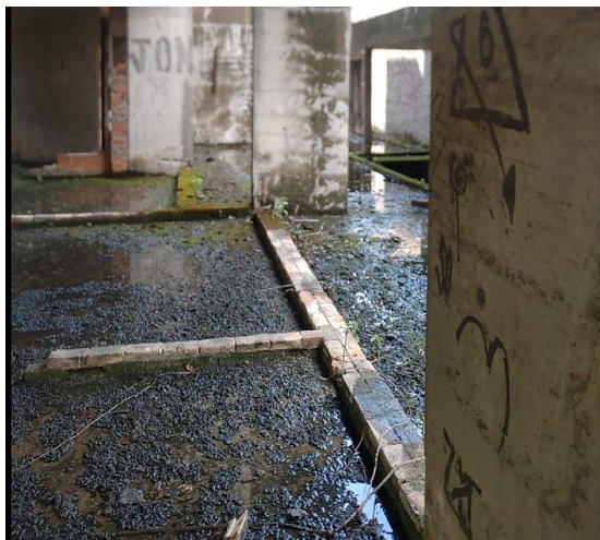
Figura 40 – Piso do pavimento térreo (3º pavimento em relação ao nível da rua) com a formação de poças de água, crescimento de vegetação e acúmulo de lodo. Fonte: Autores
