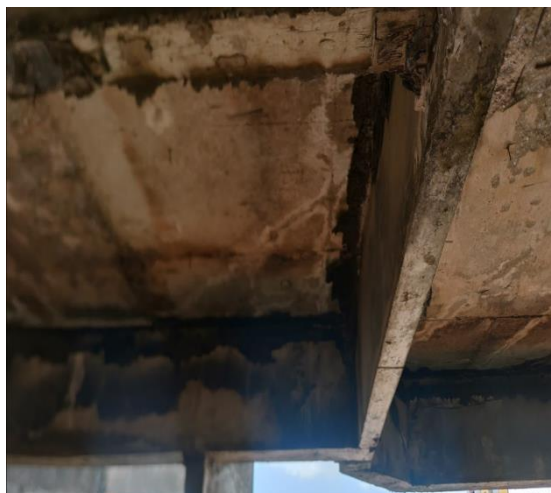
Figura 37 – Viga do 6º pavimento em relação ao nível da rua (4º pavimento tipo) com restos de forma. Fonte: Autores
