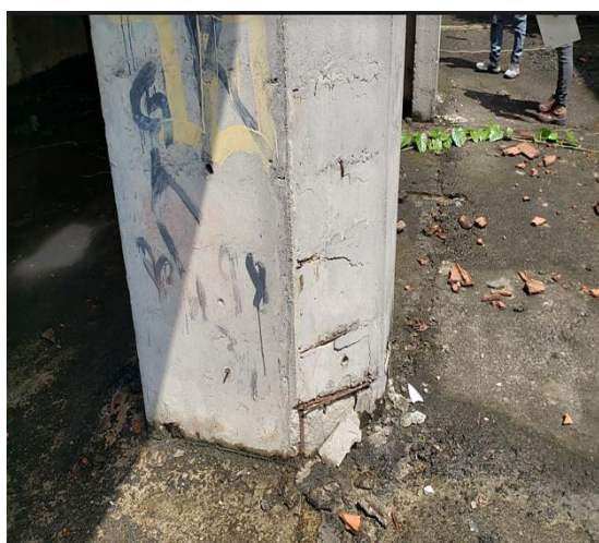
Figura 30 – Armadura exposta no pé do pilar localizado no pavimento térreo (3º pavimento em relação ao nível da rua. Fonte: Autores
