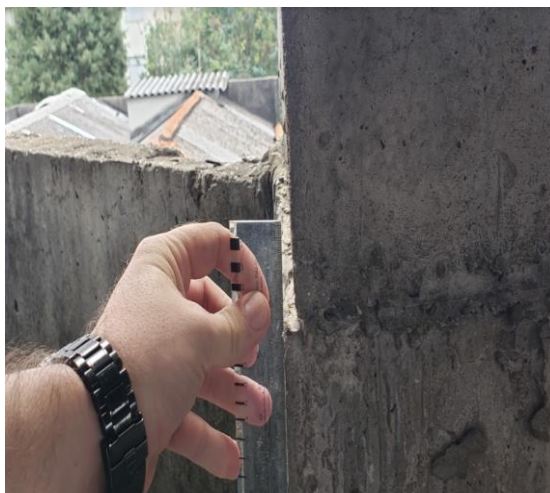
Figura 33 – Imagem do pilar localizado no pavimento 2 pavimento tipo (5º pavimento em relação ao nível da rua) com excentricidade no engaste com a viga invertida da sacada. Fonte: Autores
