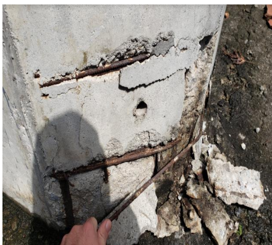
Figura 31 – Armadura exposta com perda de seção e deslocamento do concreto no pé do pilar localizado no pavimento térreo (3º pavimento em relação ao nível da rua. Fonte: Autores
