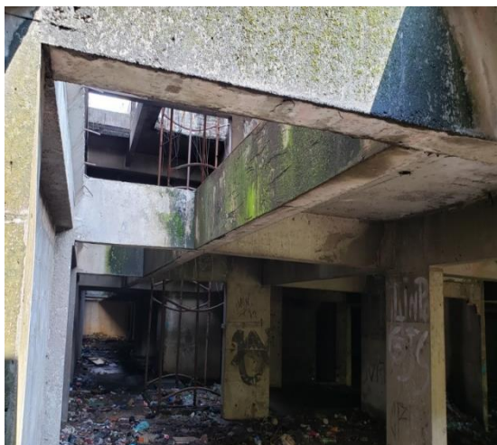
Figura 34 – Viga do pavimento do 2º sobressolo com presença de microrganismos. Fonte: Autores
