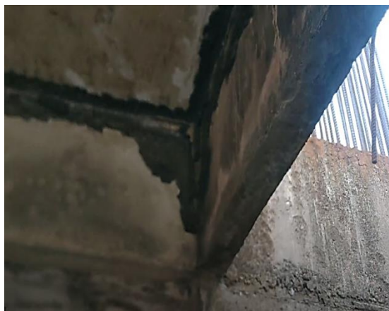
Figura 36 – Viga do 6º pavimento em relação ao nível da rua (4º pavimento tipo) com restos de forma. Fonte: Autores
