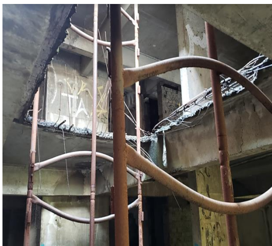
Figura 39 – Laje do 2º sobressolo (1º pavimento em relação ao nível da rua) com as armaduras retorcidas e rompidas e a grua em detalhe. Fonte: Autores
