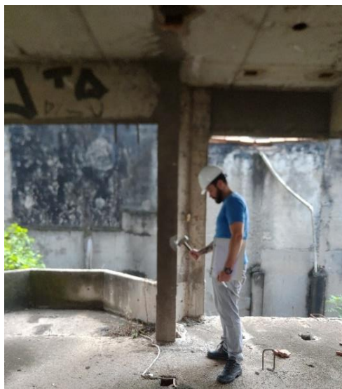
Figura 28 – Fotos ensaio de carbonatação n° 03 – Abertura da quina para se chegar à parte interna do elemento. Fonte: Autores
