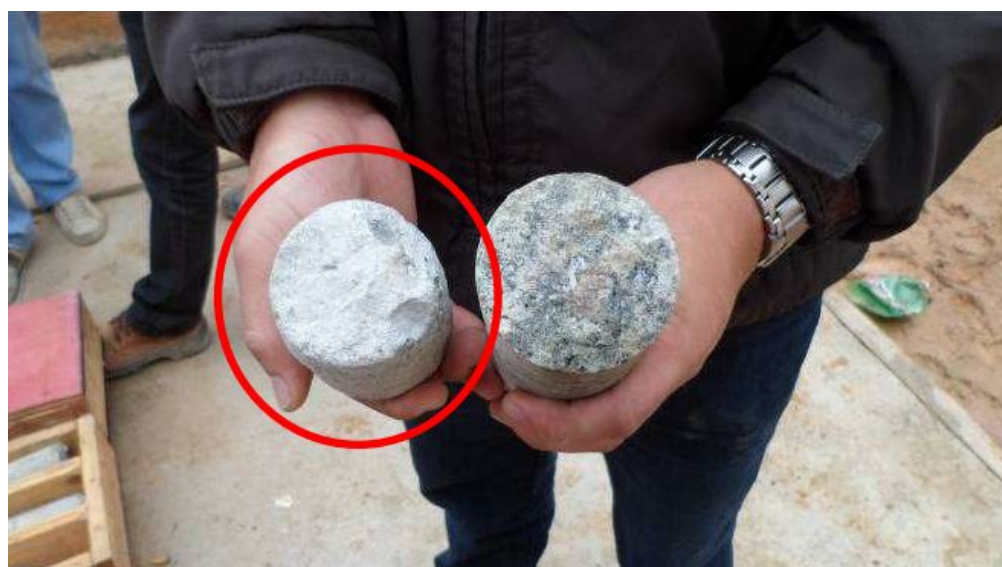
Figura 15 - Material Esbranquiçado no Concreto da Estaca P-80
