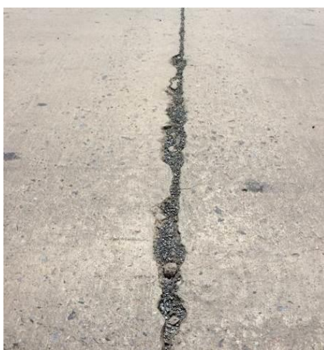
Foto 4 – Esborcinamento das juntas
