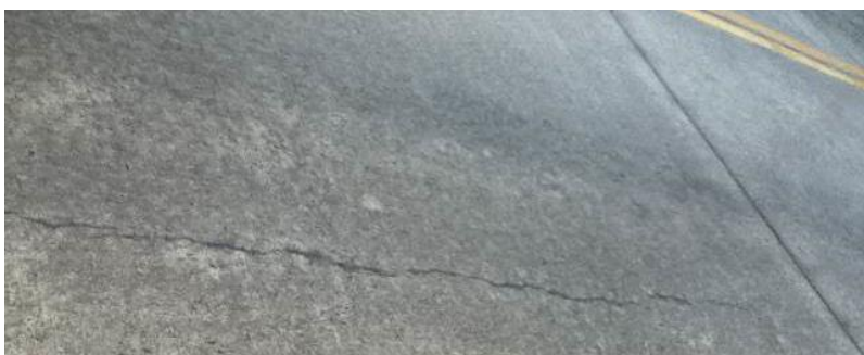
Foto 18 – Fissura linear de severidade média na placa 4A (2012)
