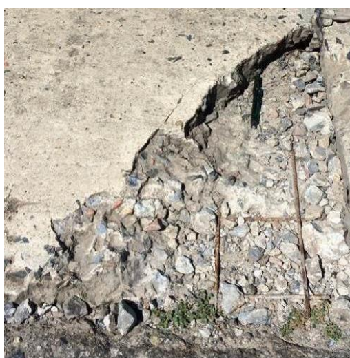
Foto 14 – Quebra de canto da placa 28B
