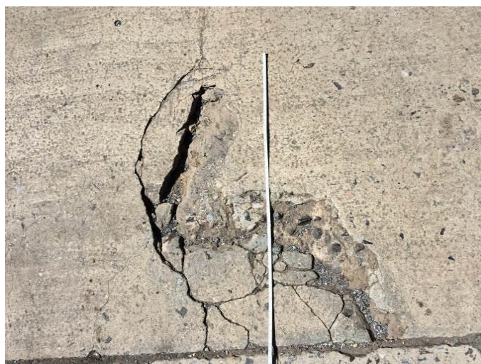
Foto 11 – Buraco de severidade alta no pano 11B
