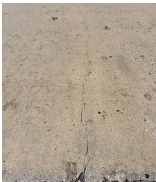
Foto 6 – Fissura linear da placa 5B
