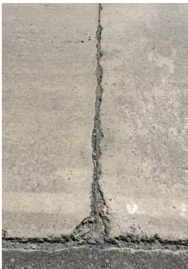
Foto 9 – Esborcinamento da junta
