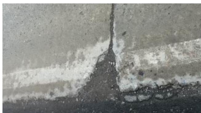
Foto 22 – Quebra de canto da placa 28B (2012)
