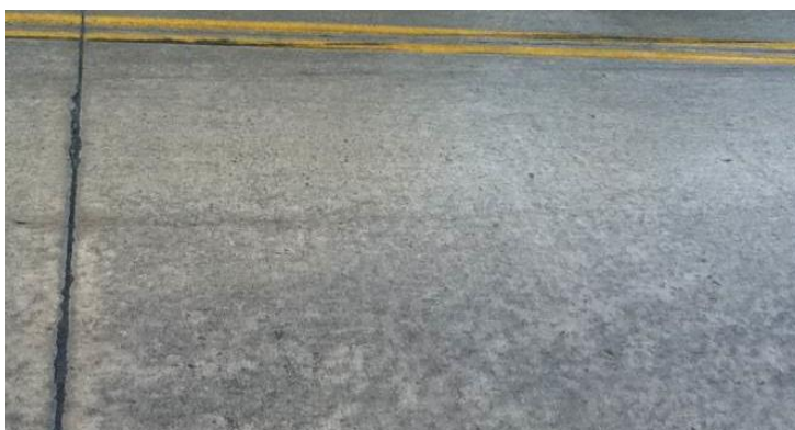
Foto 19 – Defeito na selagem das juntas e esborcinamento (2012)
