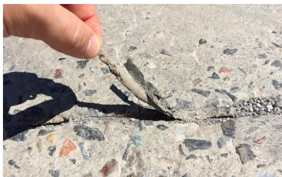
Foto 3 – Falta de manutenção na selagem das juntas
