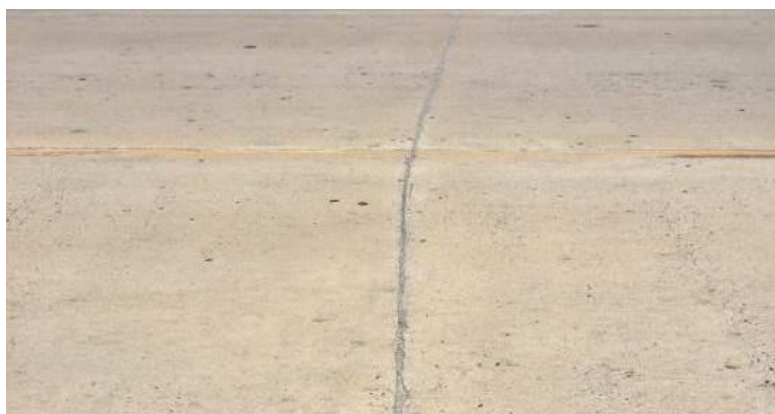
Foto 16 – Corte desalinhado da junta de movimentação
