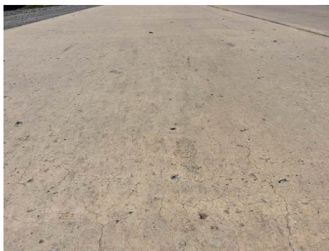
Foto 7 – Fissuras de retração plástica presente na placa 4A
