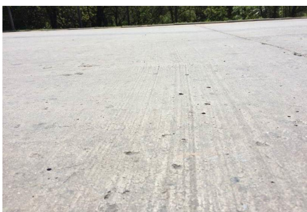
Foto 15 – Texturização do pavimento desgastada
