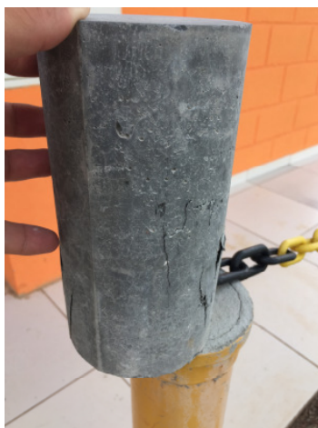
Figura 34- Aspecto de ruptura REFC
