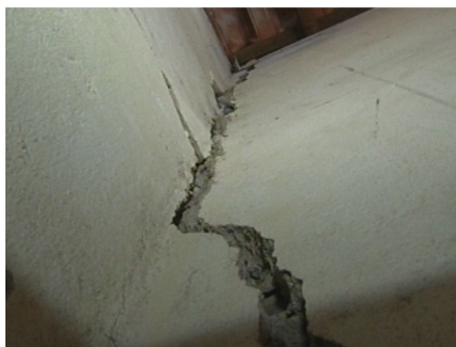
Figura 3. Trincas no encontro de paredes (PET UFJF, 2014)
