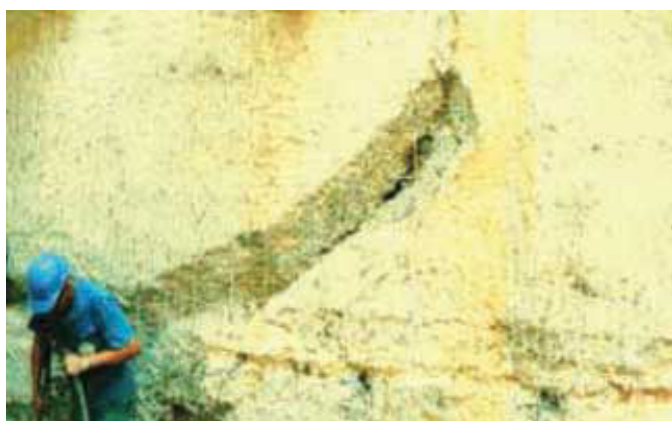
Figura 8. Falhas de concretagem (STORTE, 2013)
