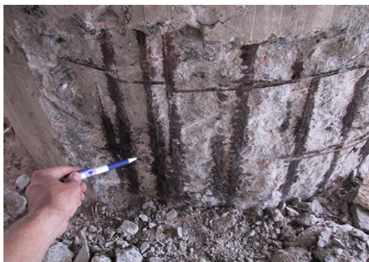
Figura 4. Corrosão de armadura no pilar (MEDEIROS, 2008)
