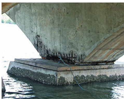
Figura 5. Corrosão de armadura na orla marítima (TECHNE, JUL 2010)
