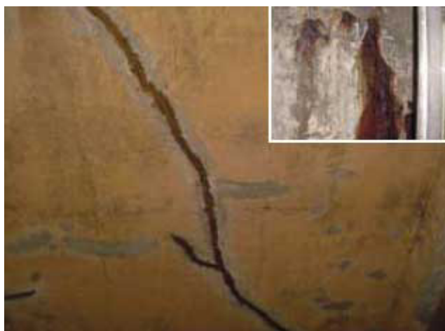
Figura 7. Trincas em paredes de reservatórios (IBDA, MAI 2015)
