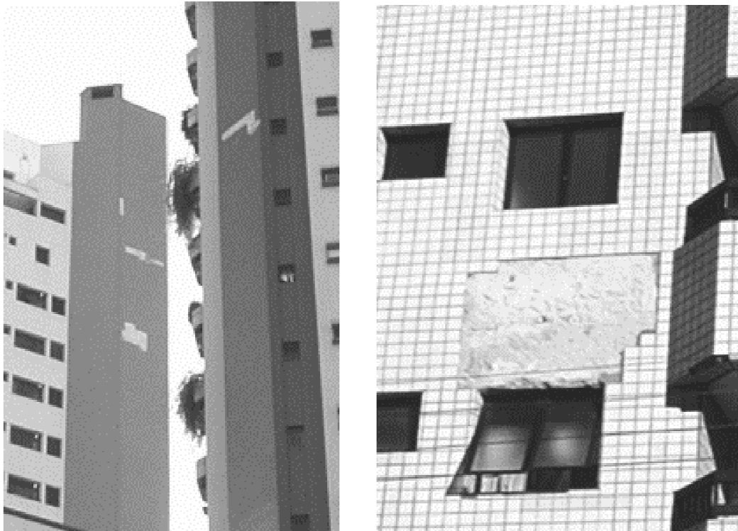
Figura 7. Edifícios com destacamento de placas cerâmicas de fachada.
