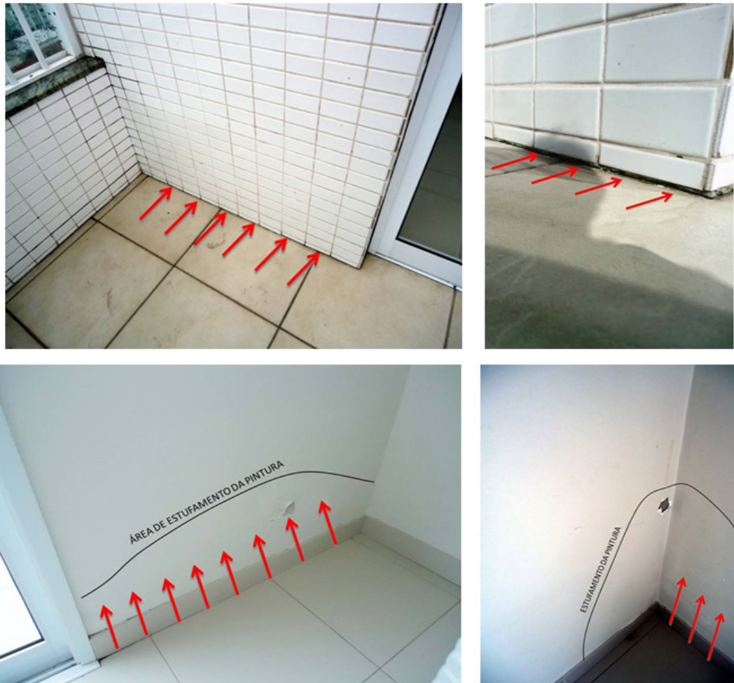
Figura 13 - Deterioração do rejunte seguido de infiltração na parte interna do ambiente.
