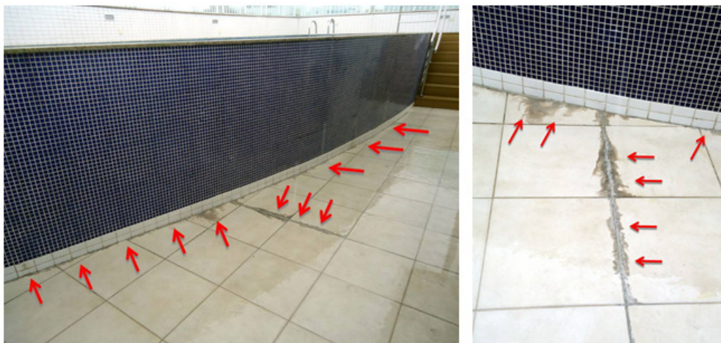
Figura 12 - Eflorescência entre o revestimento cerâmico de piso e a parede externa da piscina.
