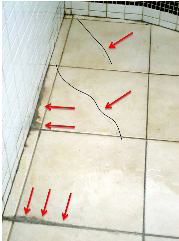
Figura 10 - Ruptura no corpo da placa cerâmica provocada por variações de temperatura.
