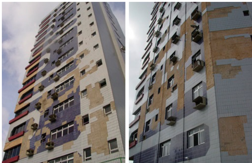
Figura 1. Fachada com deslocamento generalizado de placas cerâmicas.
