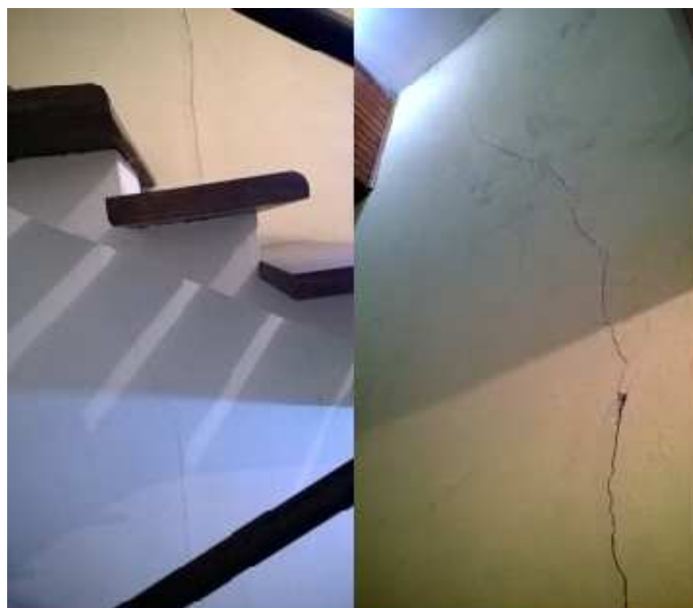
Figura 68– Fissuras na região da escada principal
