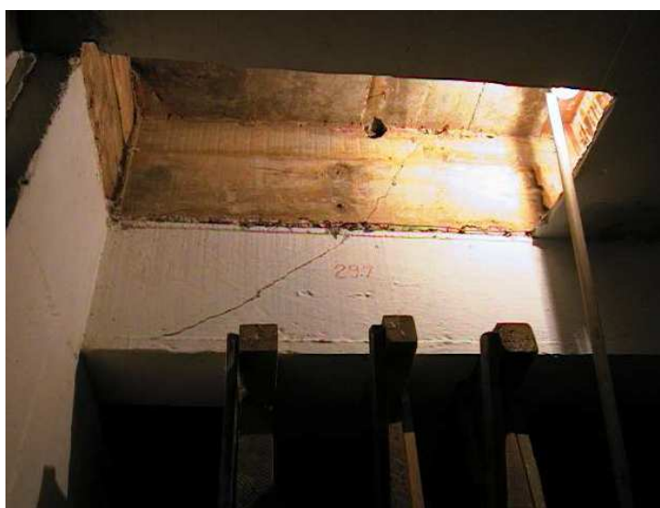
Figura 21–Fissuração típica de viga subarmada ao cisalhamento (TUTIKIAN, 2013)
