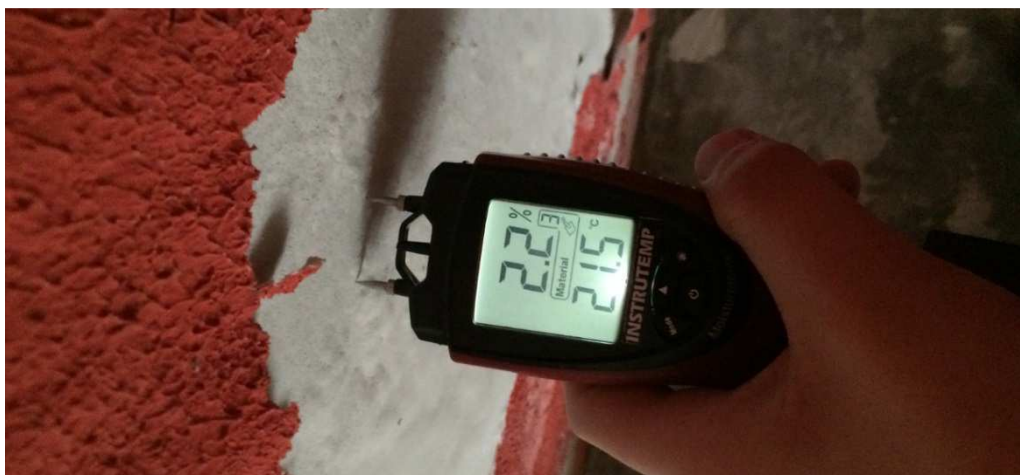
Figura 87– Medidor de umidade indicando 2,2% - superior ao mínimo de 0,9%. Valor medido na parede entre a Sala 02 e a garagem a uma altura de 40cm.
