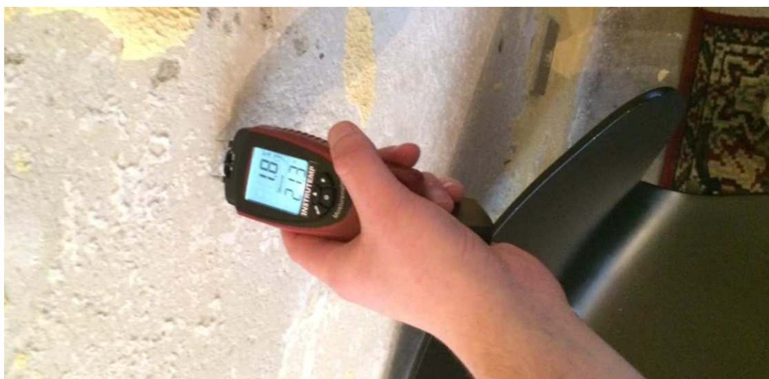
Figura 88– Medidor de umidade indicando 1,8%, medido na parede da “Sala 01” que faz divisa com o terreno vizinho.
