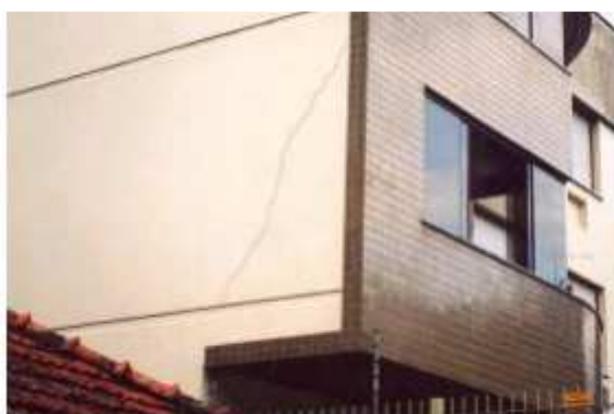
Figura 32–Trinca por deformação excessiva do balanço (MAGALHÃES, 2004)
