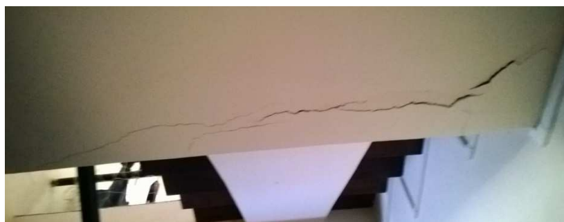
Figura 74– Vista inferior da fissura sob a escada entre o Quarto 04 e a Sala 05.
