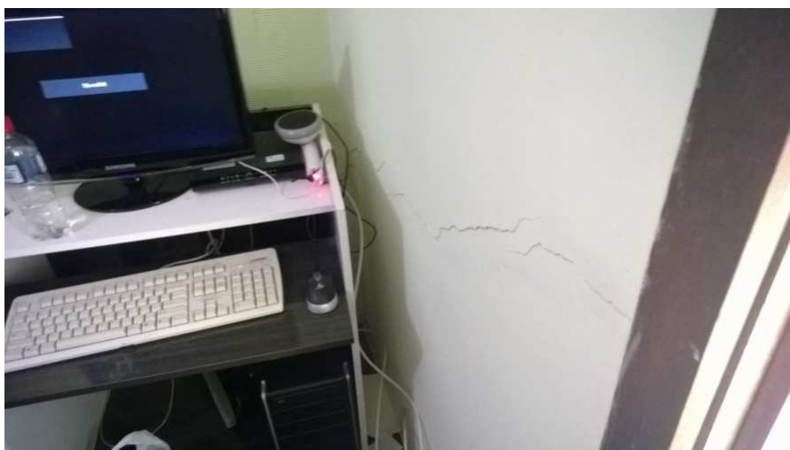
Figura 71– Vista interna da fissura na alvenaria sobre o balanço
