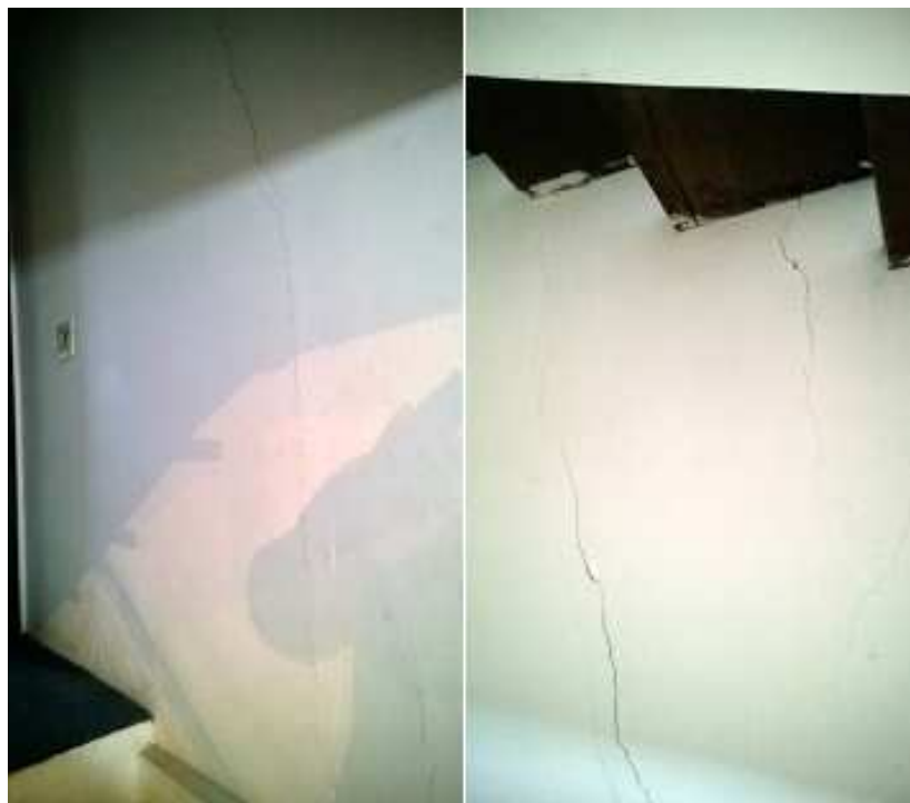
Figura 67– Fissuras na região da escada principal
