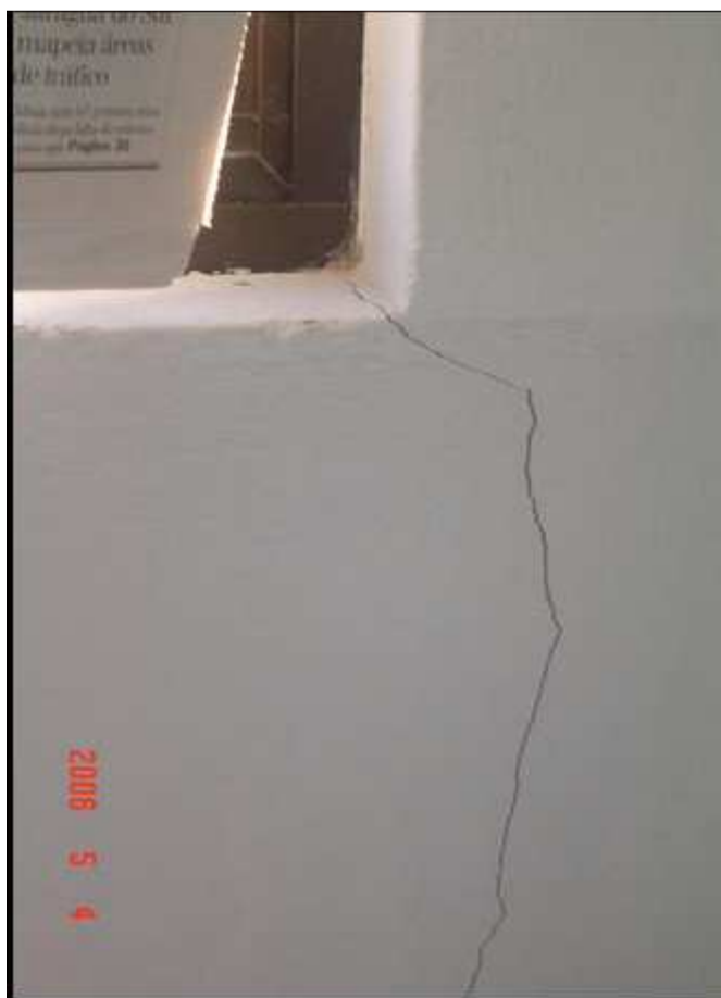
Figura 36–Fissura em canto de aberturas (CISLAGHI,2006 )
