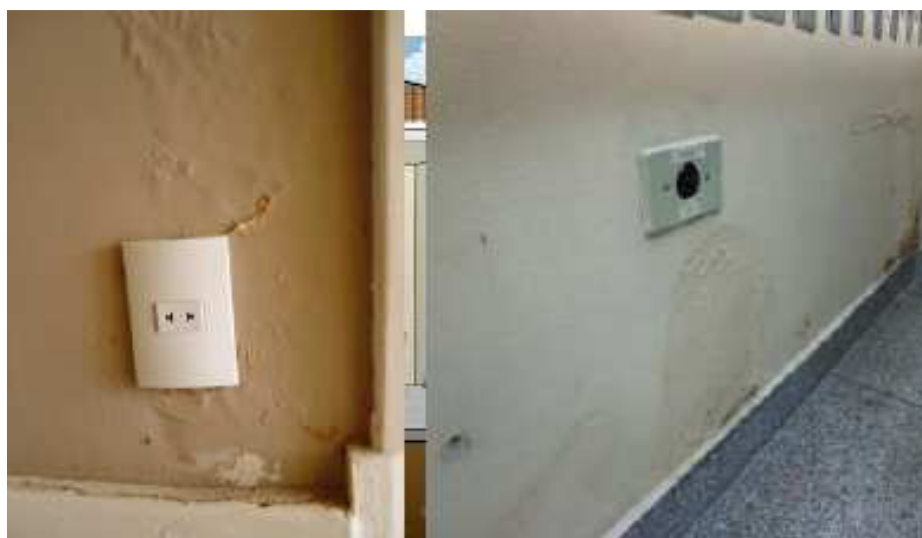
Figura 52– Bolhas de umidade (MOREIRA, 2014)
