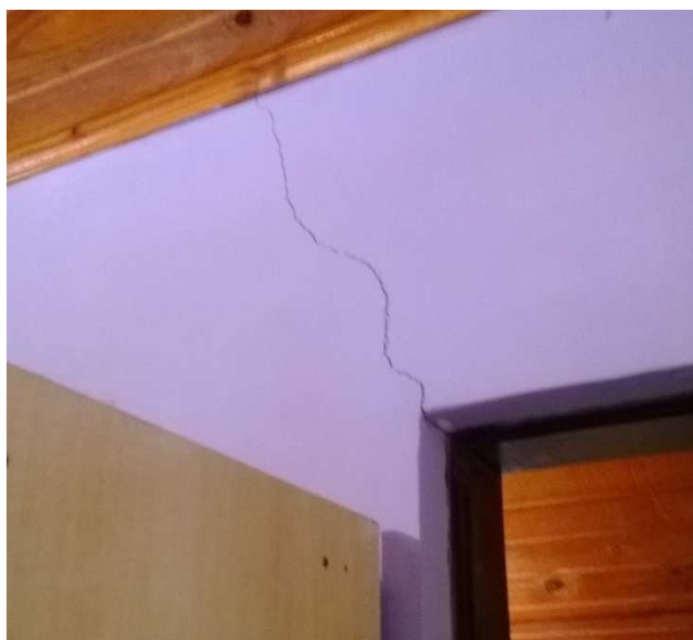
Figura 69– Fissura sobre a porta do Quarto 04 com o BWC 04
