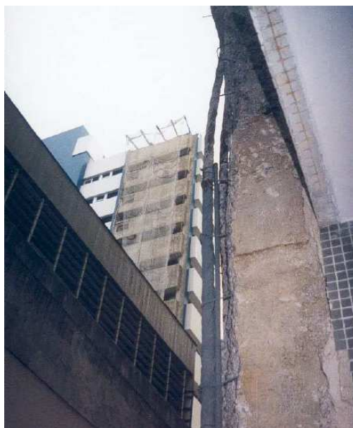
Figura 28– Fissuração de pilar deficiente de estribo (TUTIKIAN, 2013)
