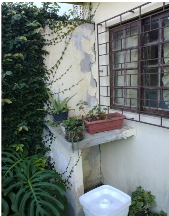
Figura 64– Fissura na ligação Muro/Residência
