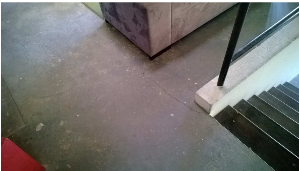
Figura 65– Fissura no piso da Sala 01
