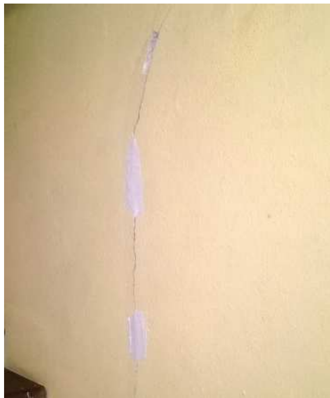
Figura 76– Espia de gesso colocada em fissura da escada central
