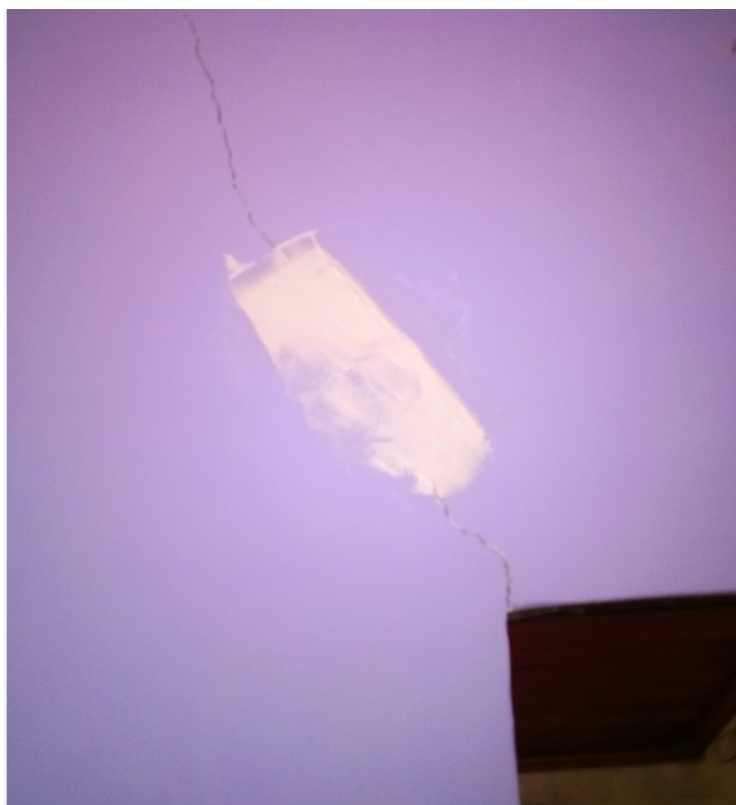
Figura 78– Espia de gesso colocada em fissura sobre a porta do Quarto 04 com o BWC 04
