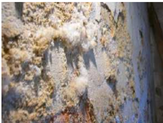
Figura 48– Eflorescência em alvenaria (MOREIRA, 2014)
