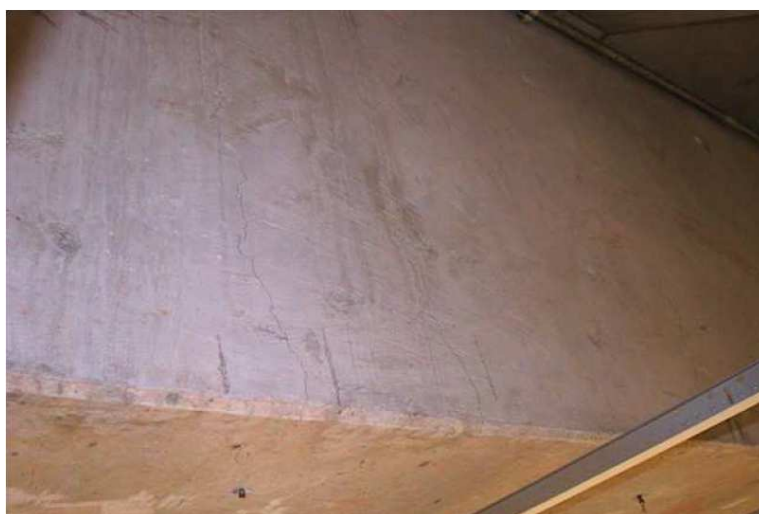
Figura 19–Fissuração típica de viga subarmada à flexão (TUTIKIAN, 2013)
