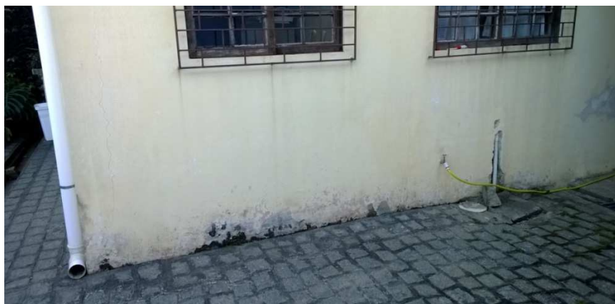
Figura 58– Infiltração de água pelo baldrame (região externa a cozinha e depósito)
