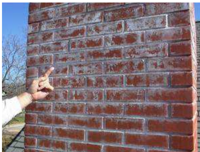
Figura 41– Eflorescência em Alvenaria (BRANDÃO, 2013)
