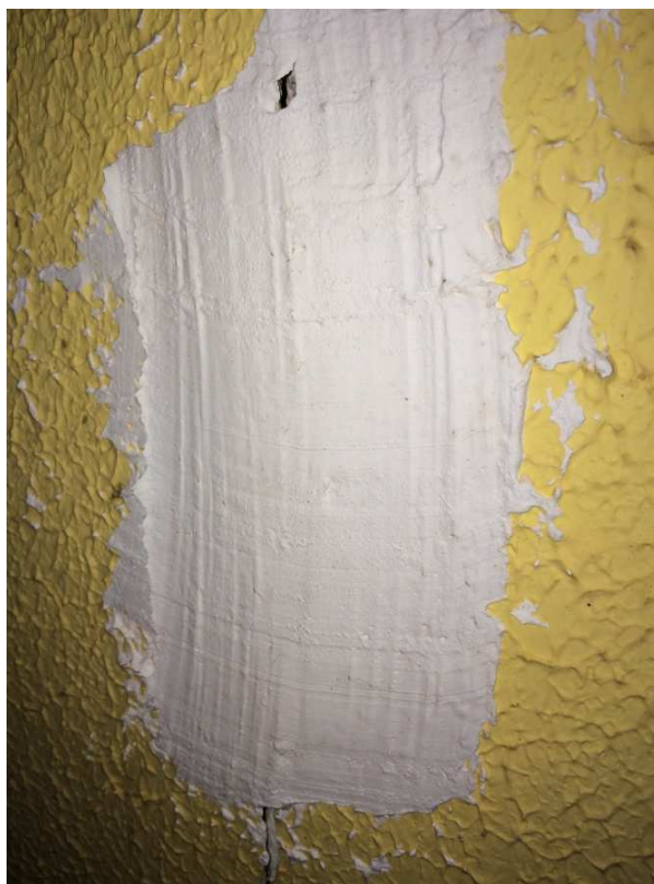
Figura 83– Espia de Gesso na região da escada sem qualquer indicio de fissuração
