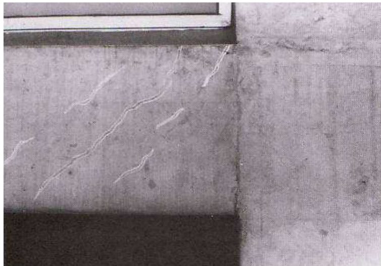
Figura 23–Fissuração típica de viga subarmada à torção (THOMAZ, 2003)
