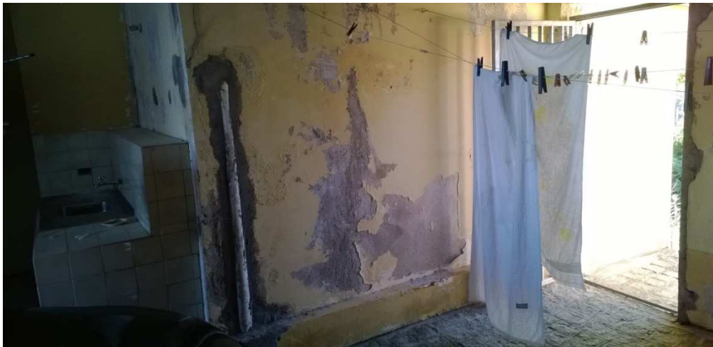
Figura 61– Infiltração de água (parede da Sala 02 com a Garagem)
