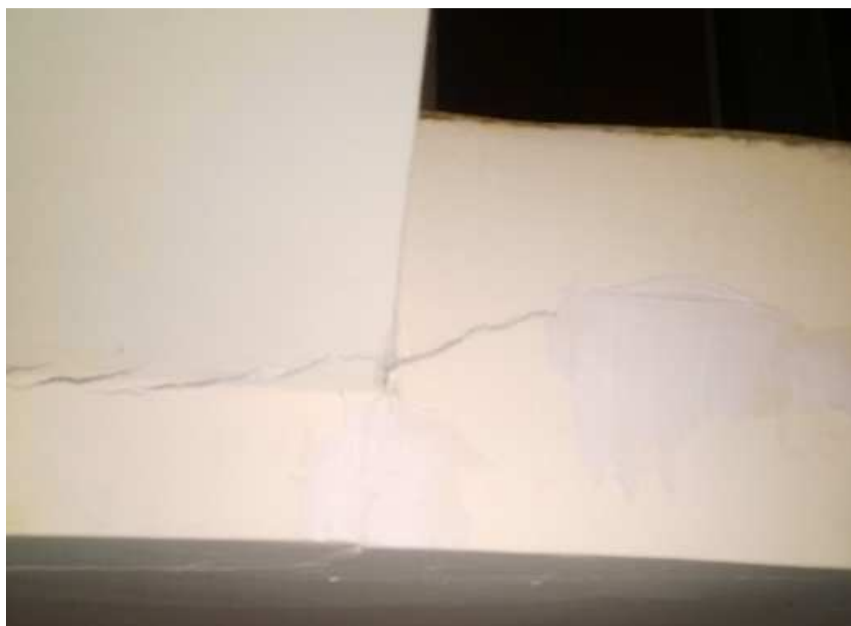
Figura 77– Espia de gesso colocada em fissura na escada entre o Quarto 04 e Sala 05
