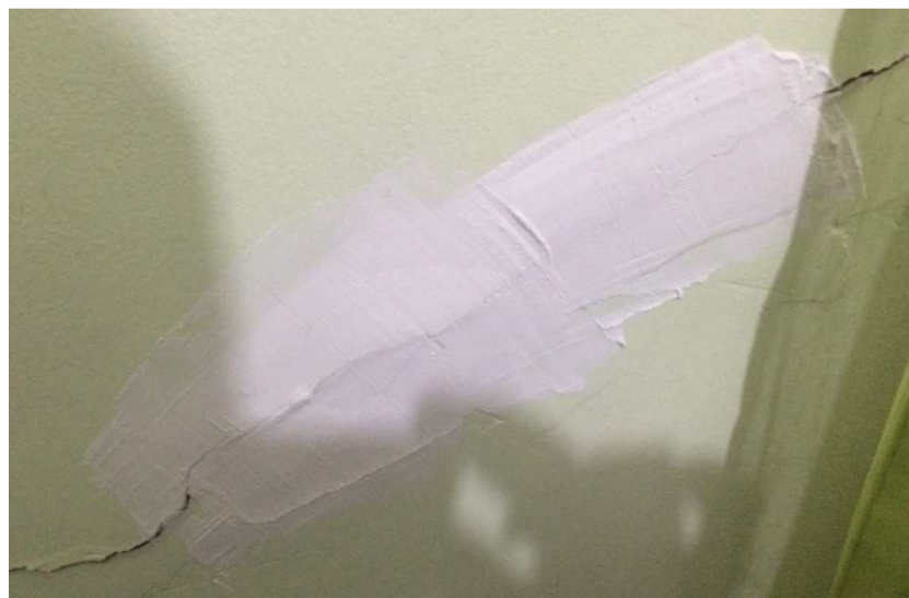
Figura 82– Espia de gesso na região do balanço do Quarto 01 com abertura de fissura
