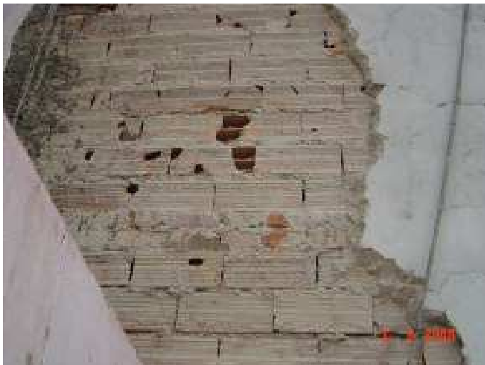
Figura 44– Deslocamento de argamassa com cal. (CAVANI, 2014)
