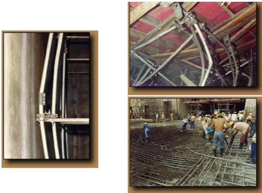
Figura 11–Deformação excessiva das formas (MARQUES, 2013)
