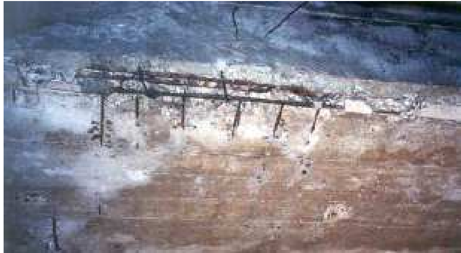
Figura 49– Corrosão de armaduras (MOREIRA, 2014)
