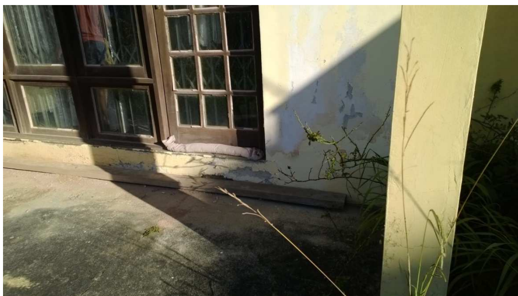
Figura 57–Infiltração de água pelo baldrame (região externa a Sala 02)
