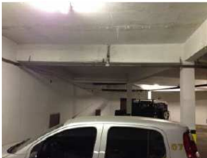
Figura 51– Estalactite causada pelo gotejamento (MOREIRA, 2014)
