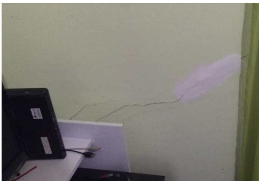
Figura 80– Espia de Gesso colocada em fissura na alvenaria sobre o balanço do Quarto 01
