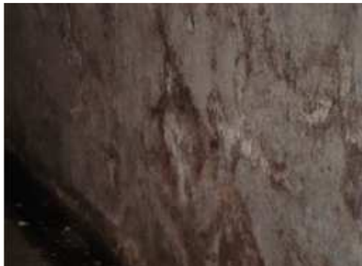
Figura 50– Parede degradada pela umidade (MOREIRA, 2014)
