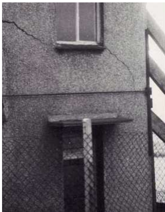
Figura 39– Fissuração típica de recalque diferencial de pilares dos cantos (MAGALHÃES, 2004)
