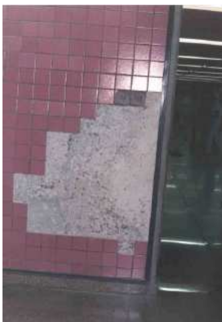
Figura 45– Deslocamento de placas cerâmicas (CAVANI, 2014)
