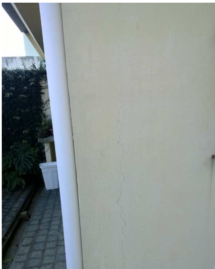
Figura 63– Fissura em ligação pilar / alvenaria
