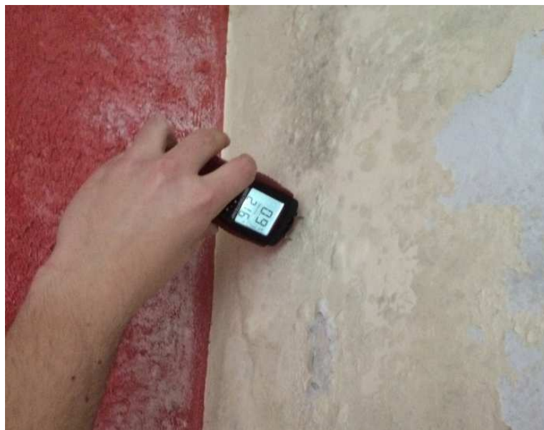
Figura 86– Medidor de umidade indicando 0,9% de umidade (valor mínimo do aparelho) – medido a 2,0 de altura na parede entre a Sala 02 e a garagem.
