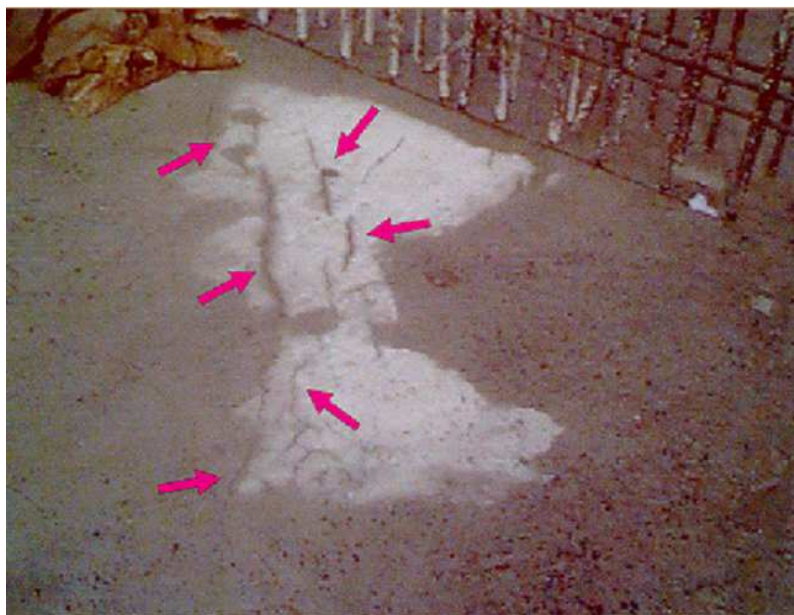
Figura 9– Trinca típica de retração plástica (MARQUES, 2013)
