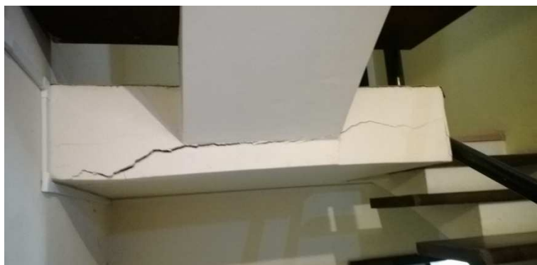
Figura 73– Vista frontal da fissura sob a escada entre o Quarto 04 e a Sala 05.
