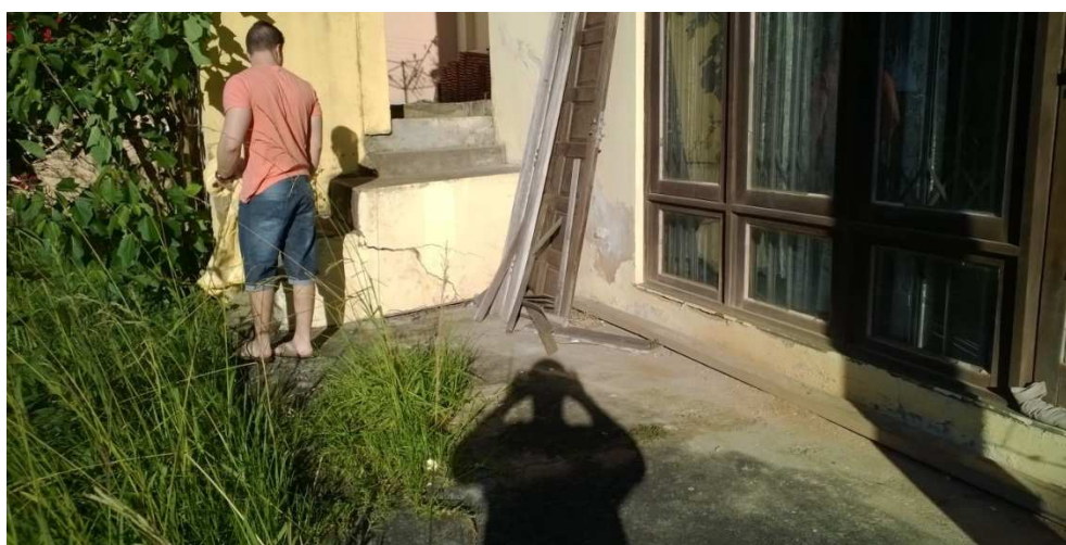
Figura 59– Fissura na escada externa (região posterior da casa)
