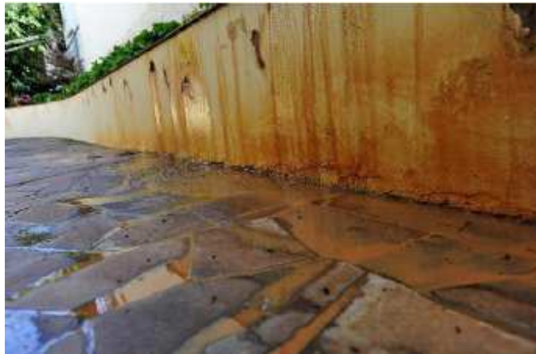
Figura 53– Manchas em alvenaria (MOREIRA, 2014)
