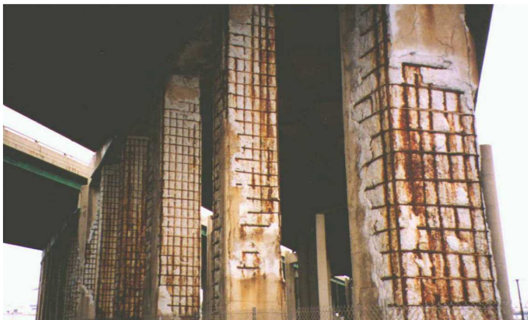
Figura 3– Corrosão de armadura em pilares de ponte no Canadá (FIGUEIREDO, 2013)
