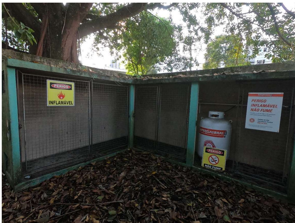
Foto 11 - Central de GLP
