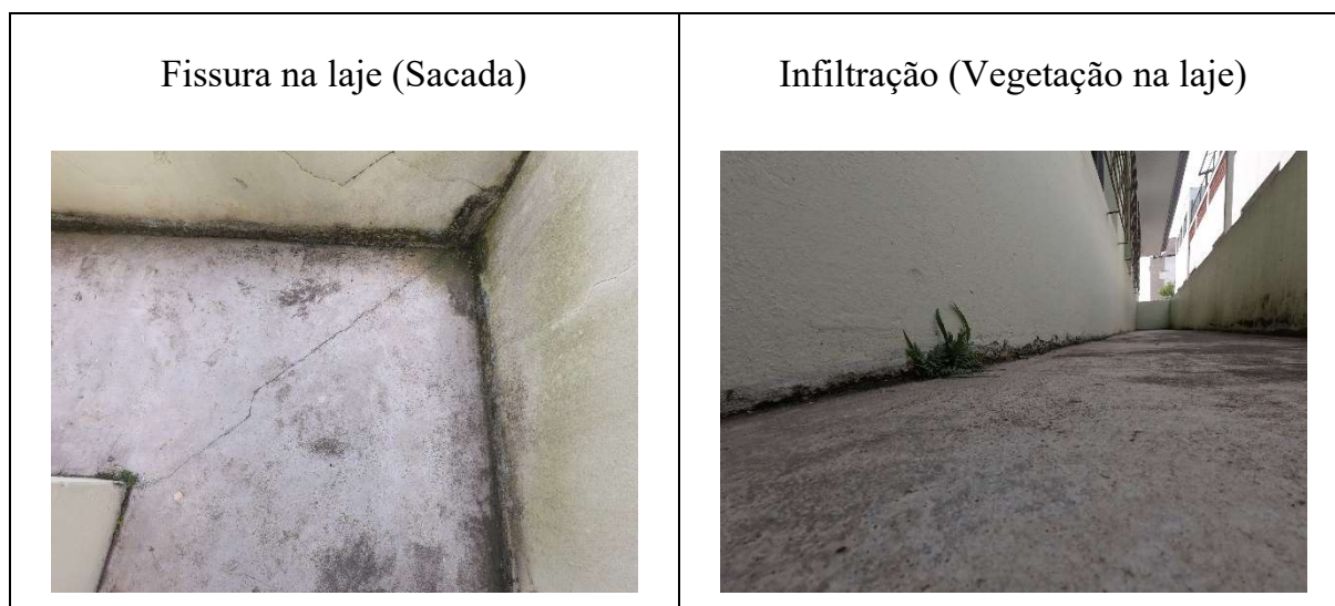
Quadro 5 - Registro fotográfico de Manifestações Patológicas no Bloco 04
