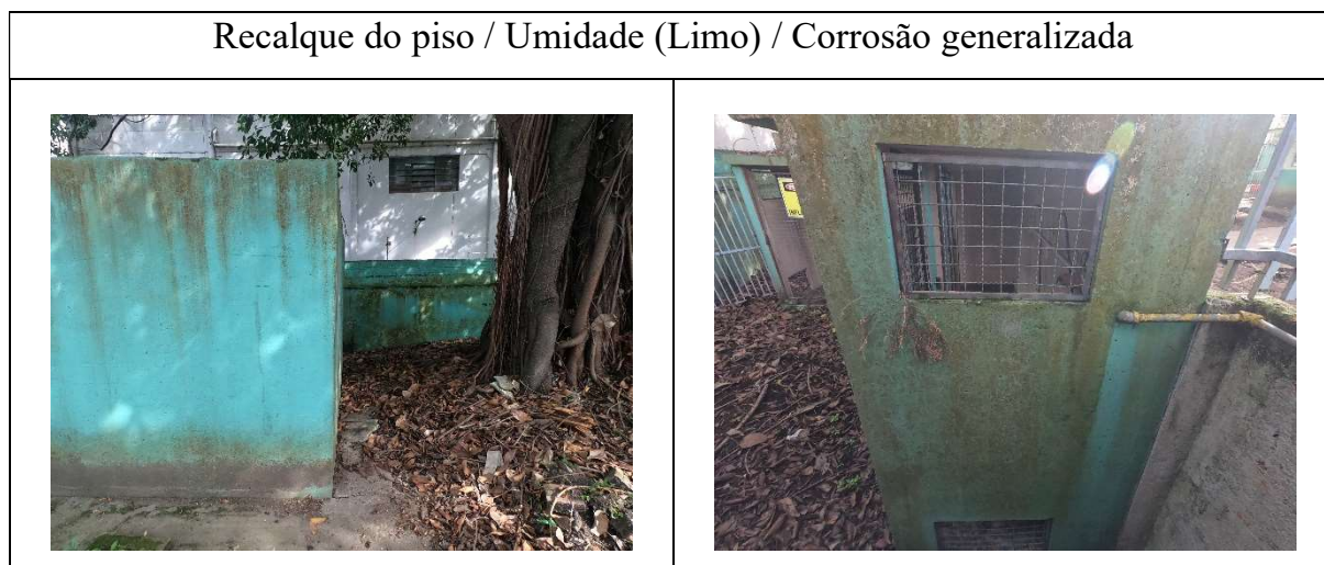
Quadro 10 - Registro fotográfico de Manifestações Patológicas da Central de GLP
