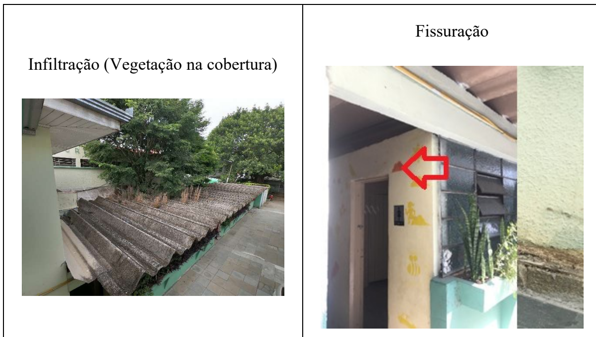
Quadro 6 - Registro fotográfico de Manifestações Patológicas no Bloco 05
