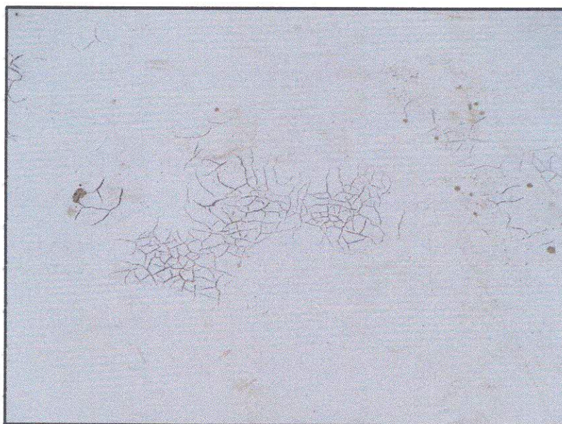
Figura 17. Fissuras superficiais de retração
