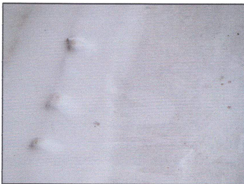
Figura 22. Irregularidade na superfície de aplicação
