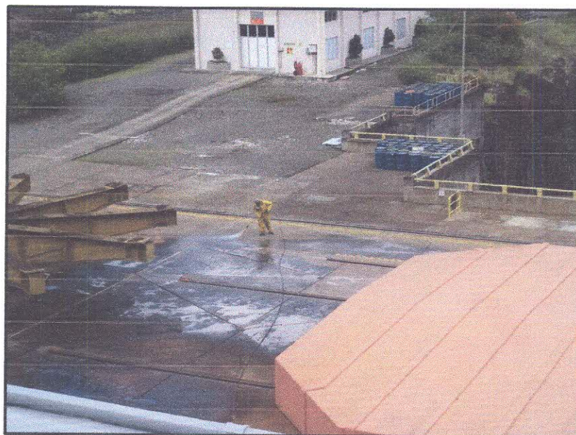
Figura 06. Vista da Lavagem Superficial
