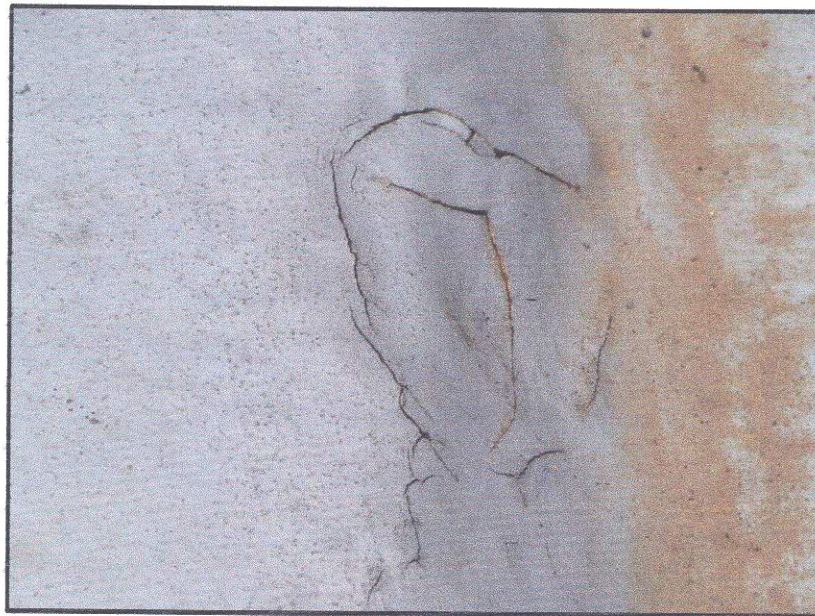
Figura 18. Fissuras após formação de bolha
