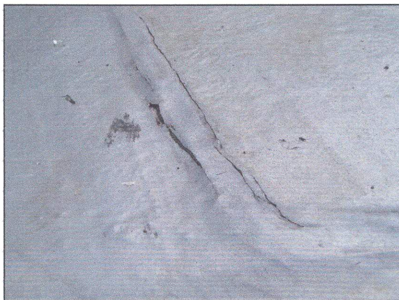
Figura 25. Fissuras nas juntas de movimentação
