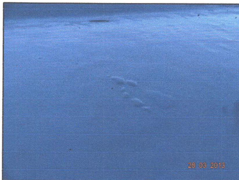
Figura 16. Bolhas na impermeabilização
