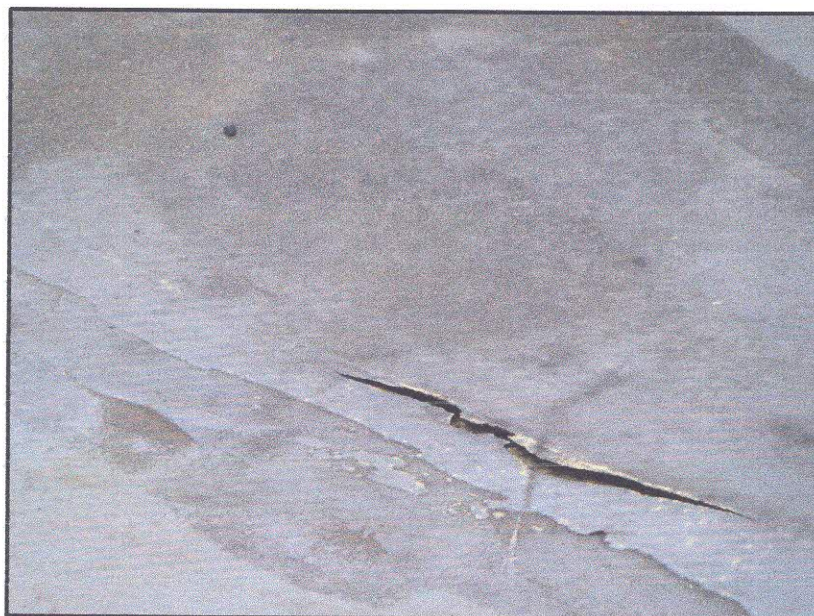
Figura 19. Detalhe de fissuras após formação de bolha
