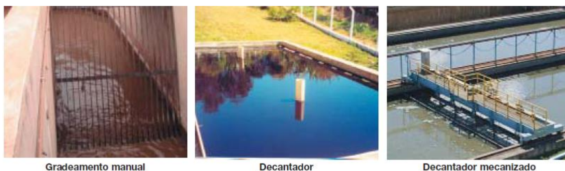
Foto 2 i Tratamento preliminar e tratamento primário (Fonte: FEAM, 2006)
