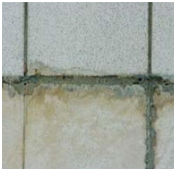
Figura 34 - Exemplo de Argamassa de preenchimento das juntas deteriorada
