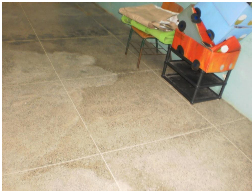
Figura 33 - Exemplo de Piso manchado por água
