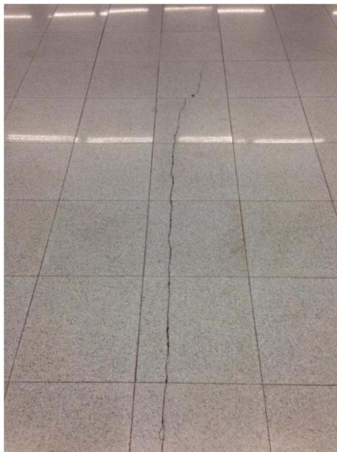
Figura 26 – Exemplo de Piso com fissuras fora do rejunte Fonte: http://www.microreve.com.br/fich/userfiles/image/fotografia%20(7).JPG
