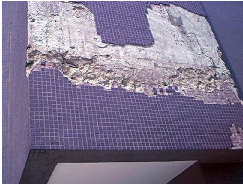
Figura 27 – Exemplo de Desplacamento de fachadas
