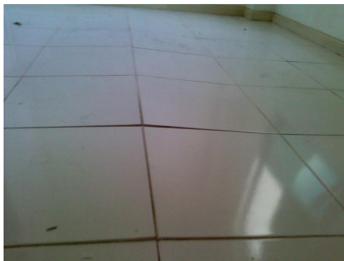
Figura 29 – Exemplo de Descolamento de piso residencial
