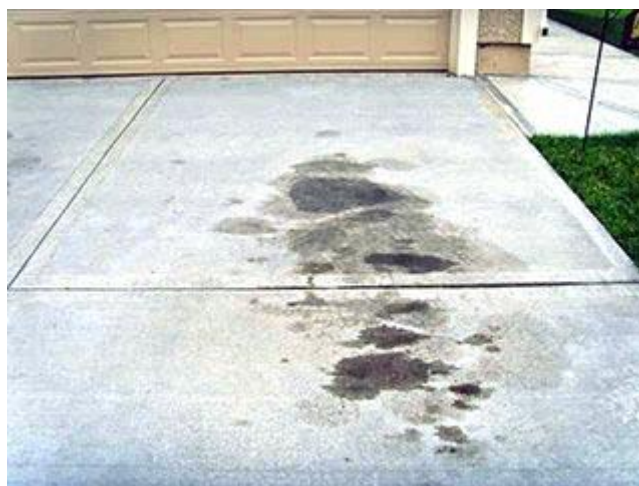
Figura 32 – Exemplo de Piso manchado por vazamento de óleo de veículo Fonte: http://limcamar.files.wordpress.com/2013/02/manchas-aceite.jpg
