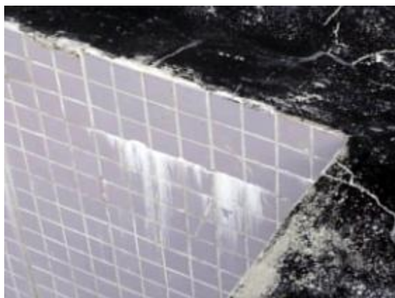
Figura 30 - Exemplo de Eflorescência em fachada por ausência de mureta perimetral
