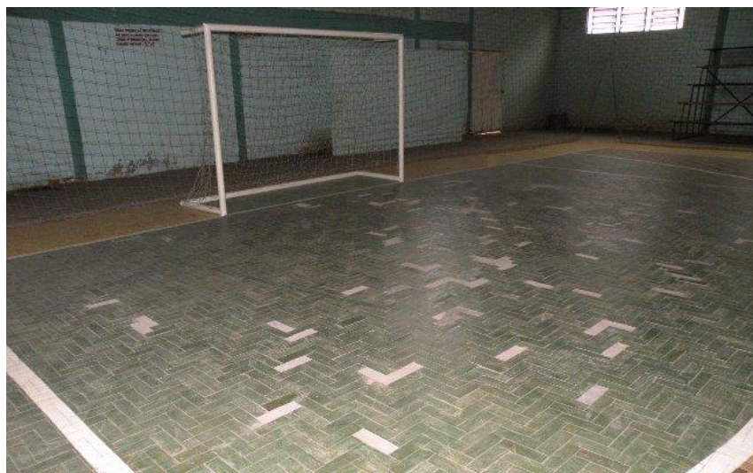
Figura 28 - Piso descolado no Ginásio Municipal do Parque do Trabalhador Fonte: Prefeitura Municipal de Taquara-RS
