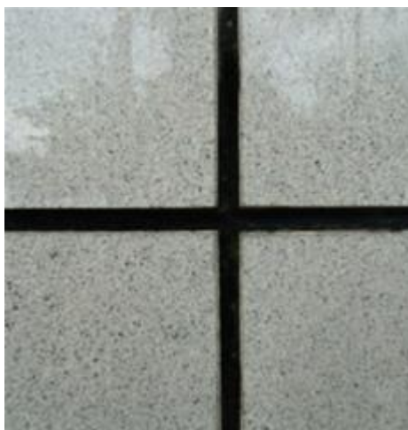
Figura 31 – Exemplo de proliferação de fungo em argamassa de rejunte com cor original cinza
