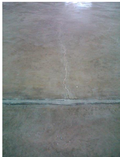
Figura 54 – Fissura transversal à junta serrada
