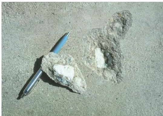
Figura 35: Ruptura de pequenas porções do pavimento industrial de concreto Fonte: www.mundodoconcreto.com.br
