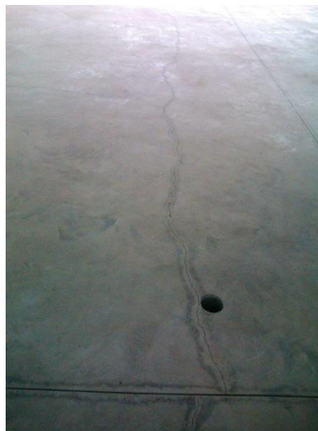
Figura 60 – Fissura ao longo do pavimento industrial de concreto Fonte: Acervo do grupo
