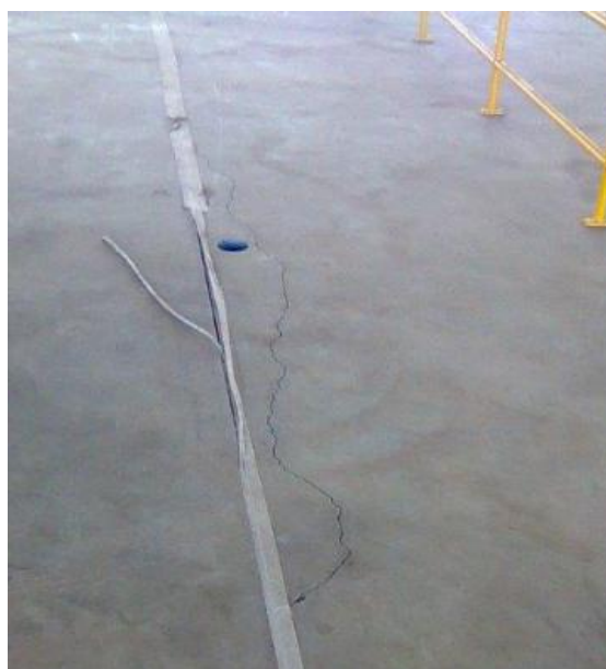
Figura 62 – Fissura acompanhando a junta Fonte: Acervo do grupo
