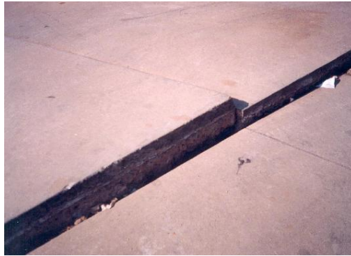
Figura 38: Empenamento diferencial das placas de concreto
