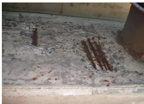
Figura 37: Desplacamento superficial do concreto por corrosão de armadura
