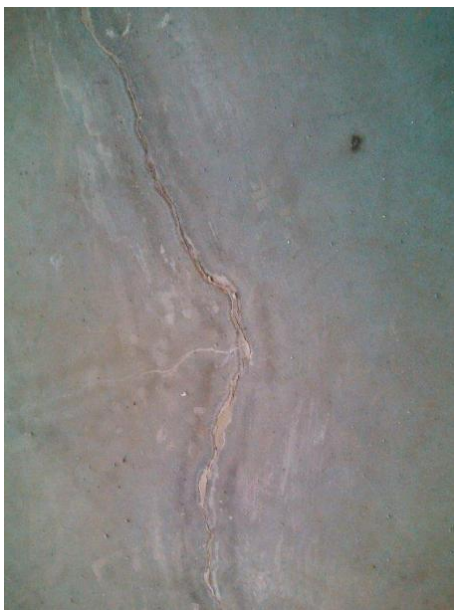
Figura 59 – Fissura ao longo do pavimento industrial de concreto Fonte: Acervo do grupo
