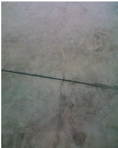
Figura 55 – Fissura transversal à junta serrada Fonte: Acervo do grupo
