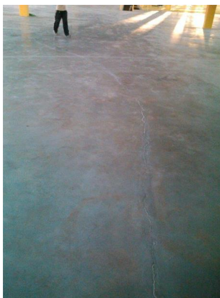
Figura 57 – Fissura ao longo do pavimento industrial de concreto Fonte: Acervo do grupo
