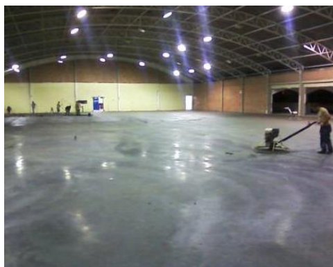
Figura 34: Variações na textura superficial do pavimento industrial de concreto Fonte: www.mundodoconcreto.com.br
