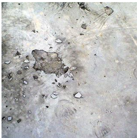
Figura 30 – Delaminação do concreto Fonte: www.cimentoitambe.com.br
