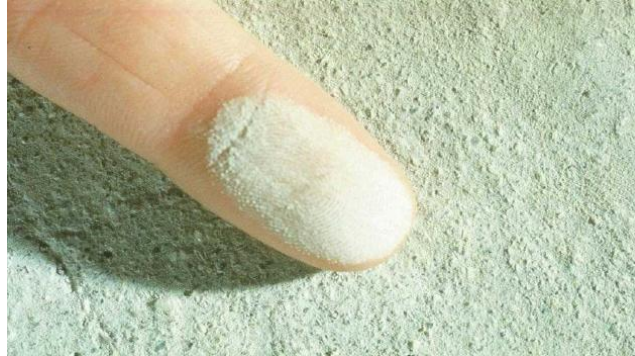
Figura 32: Esfarelamento superficial do pavimento industrial de concreto Fonte: Material aula - José Eduardo Granato
