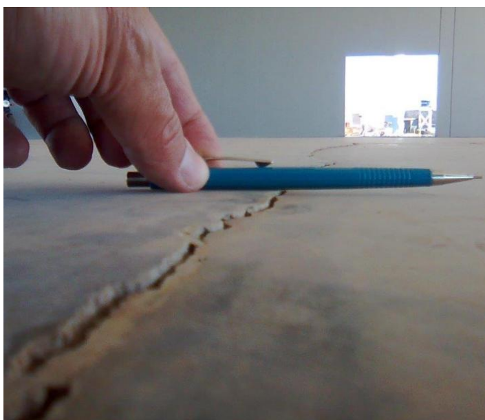
Figura 61 – Fissura e desnível ao longo do pavimento industrial de concreto Fonte: Acervo do grupo
