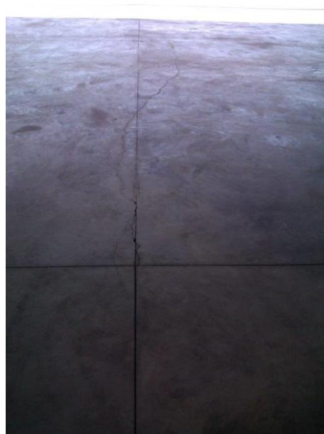
Figura 56 – Fissura acompanhando a junta Fonte: Acervo do grupo
