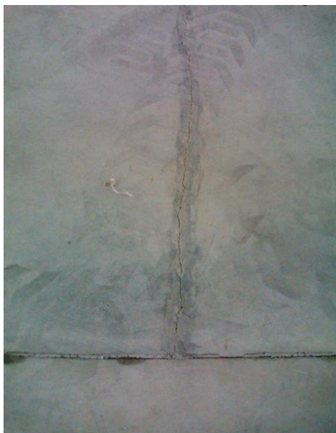
Figura 53 – Fissura transversal à junta serrada
