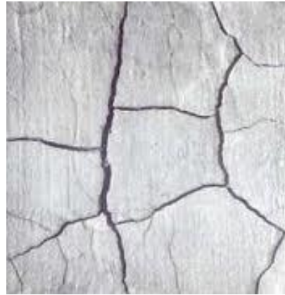
Figura 27 – Fissuras ao longo do pavimento industrial de concreto Fonte: www.google.com.br/images
