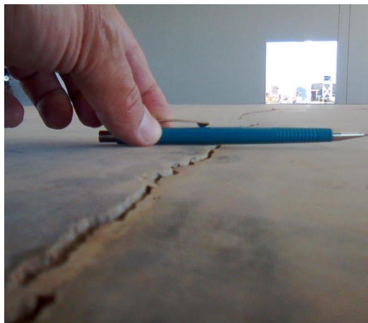
Figura 26 – Fissura ao longo do pavimento industrial de concreto Fonte: Acervo do grupo
