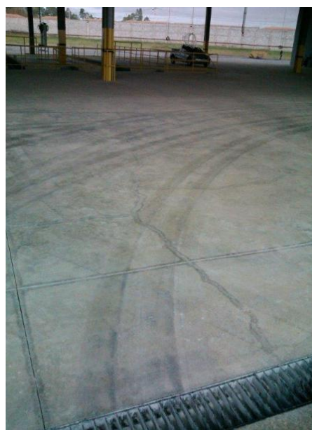
Figura 58 – Fissura próxima à canaleta Fonte: Acervo do grupo
