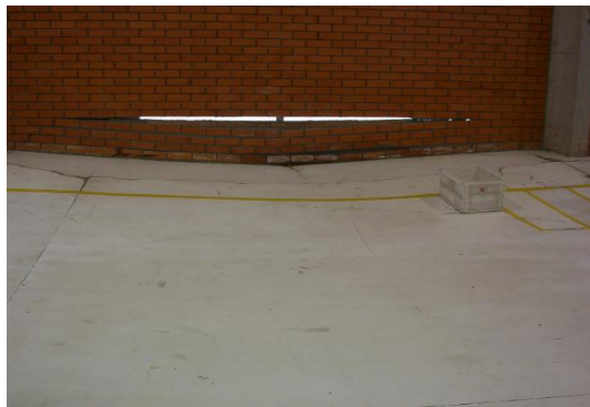
Figura 39: Recalque e rebaixamento das placas no pavimento industrial de concreto
