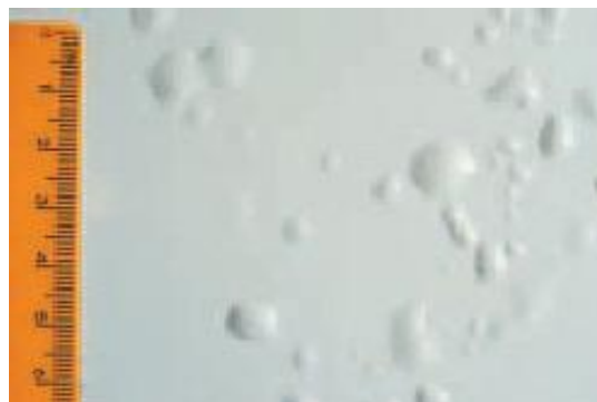
Figura 33: Bolhas no revestimento superficial do pavimento industrial de concreto Fonte: www.mundodoconcreto.com.br
