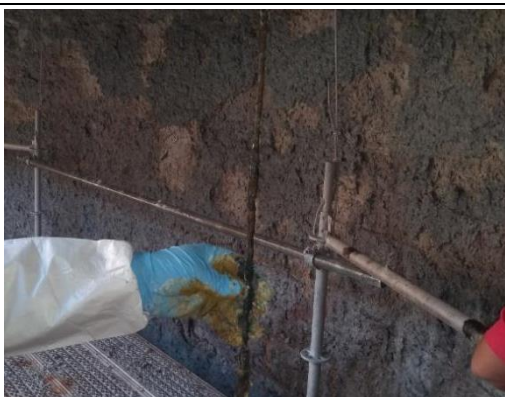
Foto 3 – Condição da barra de aço da estrutura
