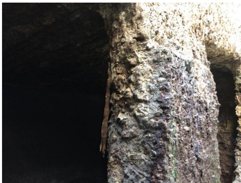
Figura 11 – Parede do vertedouro com concreto deteriorado e armadura corroída
