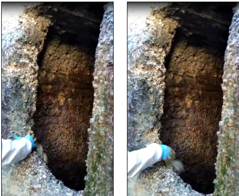
Figura 10 – Arrancamento do concreto com a mão em um dos pilares da estrutura
