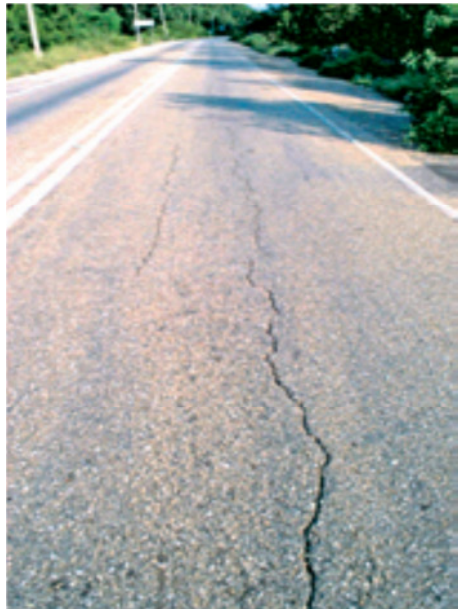
Figura 02 – Trinca Longitudinal (BERNUCCI, et al , 2010)
