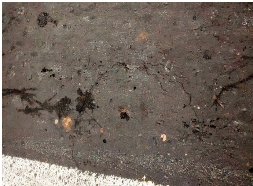
Figura 27 – Trincas em série.
