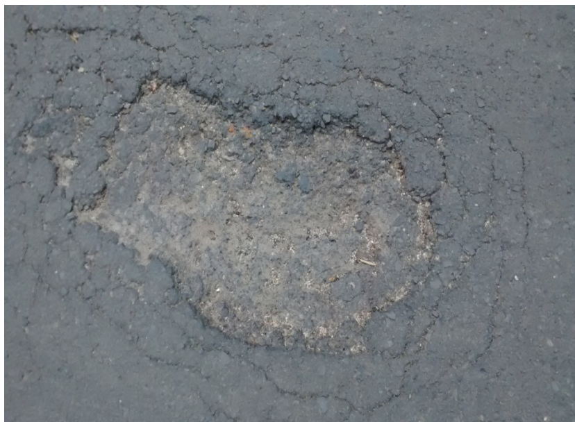
Figura 25 – Panela já consolidada, com trincas de expansão.
