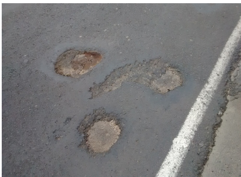
Figura 28 – Painéis próximas em trecho de 20 metros.
