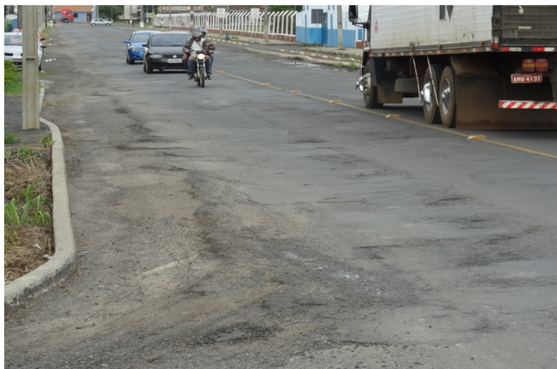
Figura 18– Desgaste da capa por falta de manutenção (PMPU, 2012)
