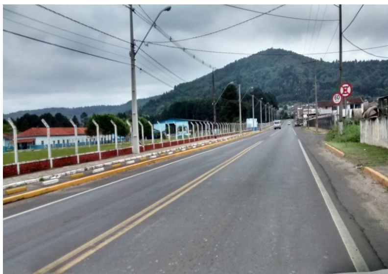
Figura 21 – Avenida Ferroviários com marcas na trilha de roda (PMPU, 2014)
