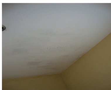
Foto 7: Manchas de umidade
