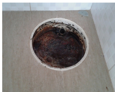
Foto 8: Restos de alimento em caixa de gordura
