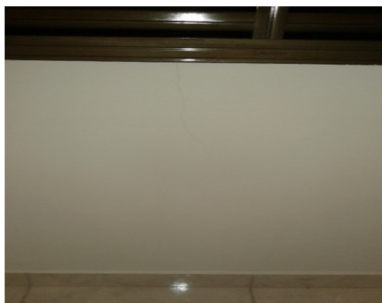
Foto 3: Fissura embaixo da janela de um quarto
