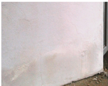
Foto 4: Manchas de umidade
