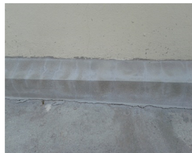
Foto 5: Destacamento de reboco
