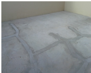
Foto 10: Fissuras e destacamento em piso de concreto
