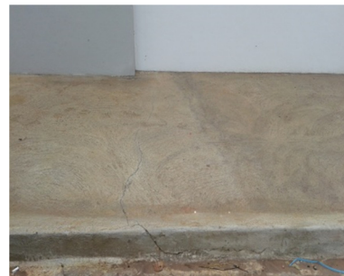
Foto 12: Fissuras em piso de concreto
