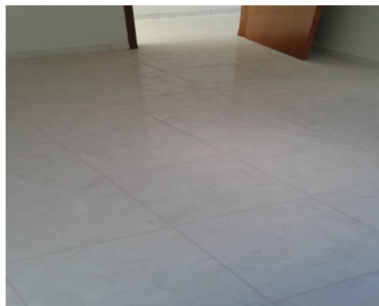
Foto 11: Perda de brilho dos pisos cerâmicos
