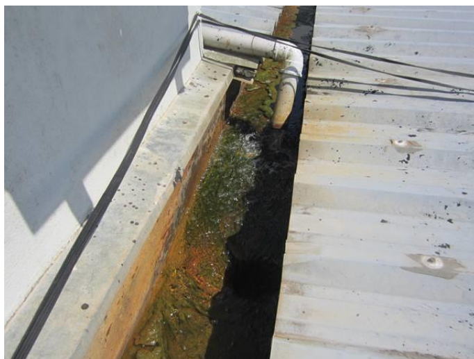
Foto 1. Vazão de água da cisterna na cobertura
