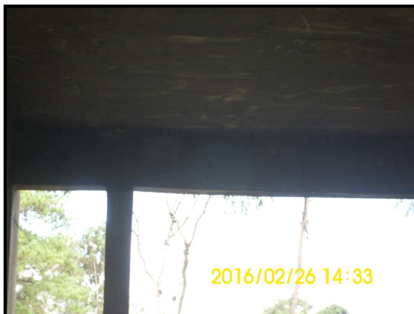
Foto 41 - 1º PAVIMENTO - Desaprumo em viga devido erro durante concretagem.
