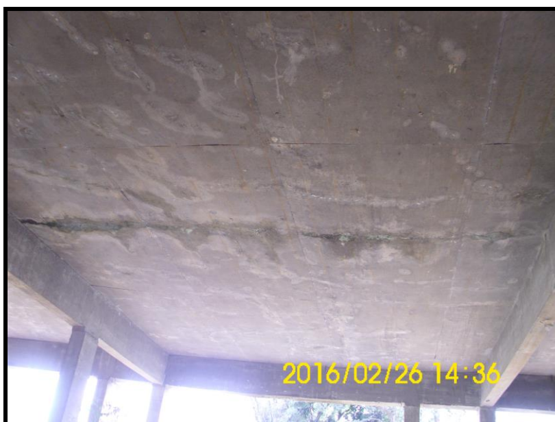
Foto 44 - 1º PAVIMENTO - Mapeamento de armadura e trinca longitudinal com manchas de infiltração.
