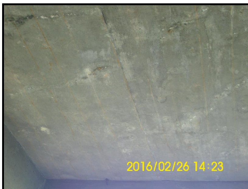
Foto 32 - 1º PAVIMENTO - Mapeamento de armadura devido pequeno cobrimento.
