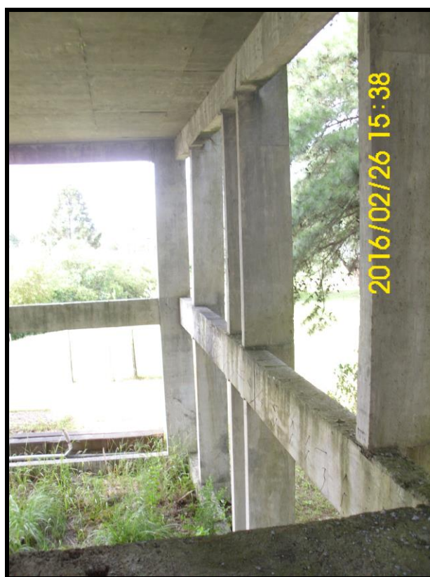
Foto 96 - 2º PAVIMENTO - Mapeamento de armadura devido pequeno cobrimento e peças fora de esquadro.
