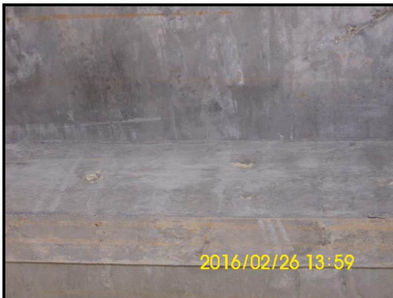
Foto 15 - 1º PAVIMENTO - Fissura transversal em viga.
