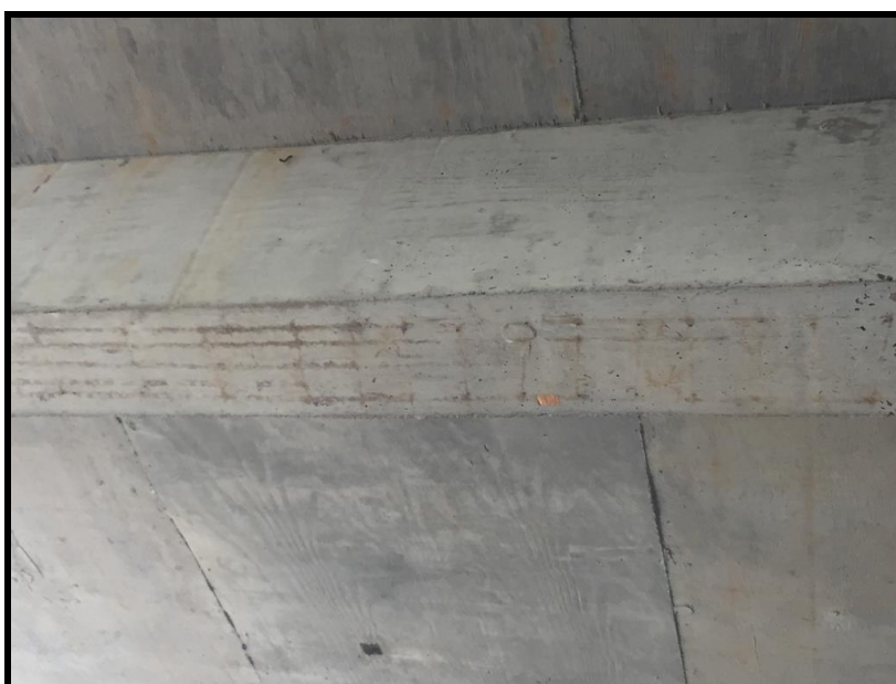
Foto 124 - 2º PAVIMENTO - Mapeamento de armadura devido pequeno cobrimento.
