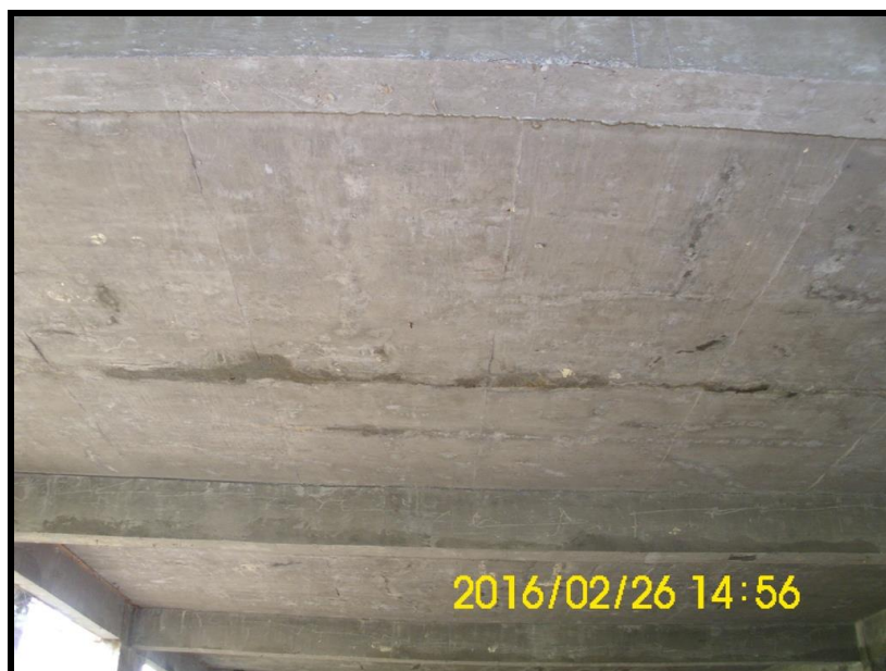
Foto 65 - 1º PAVIMENTO - Trinca transversal em laje e manchas de infiltração.
