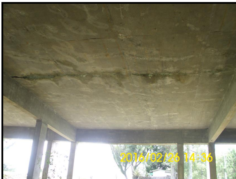
Foto 43 - 1º PAVIMENTO - Desaprumo em viga devido erro durante concretagem.
