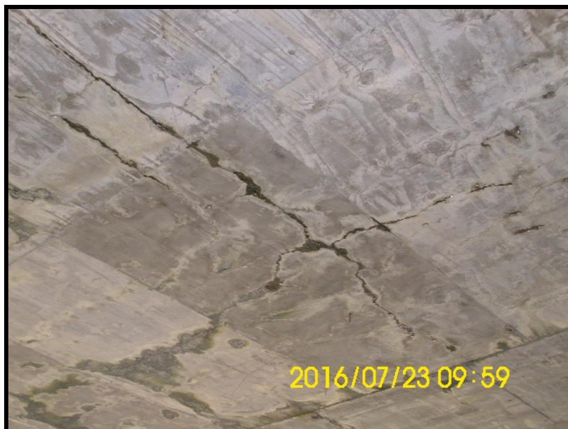
Foto 167 - 3º PAVIMENTO - Manchas de infiltrações em laje.
