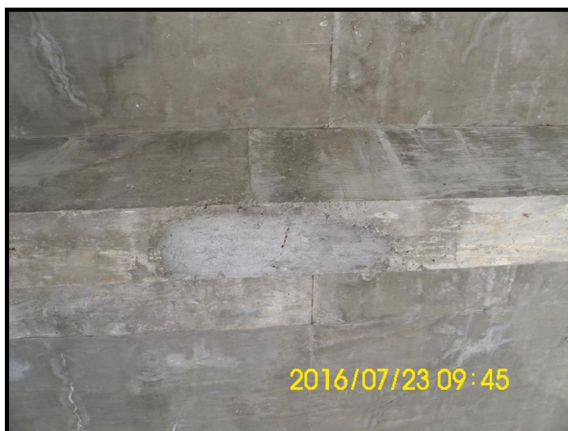
Foto 154 - 3º PAVIMENTO - Armadura exposta em reparo em viga.
