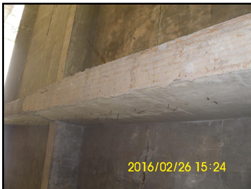
Foto 81 - 1º PAVIMENTO - Mapeamento de armadura devido pequeno cobrimento.
