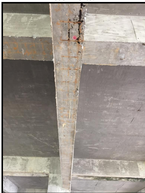
Foto 108 - 2º PAVIMENTO - Mapeamento de armadura devido pequeno cobrimento e nichos de concretagem.
