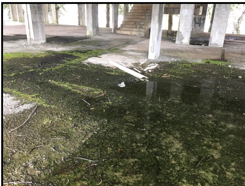
Foto 115 - 1º PAVIMENTO - Cultura de fungos e bolores na laje devido infiltração através da junta de dilatação da estrutura.
