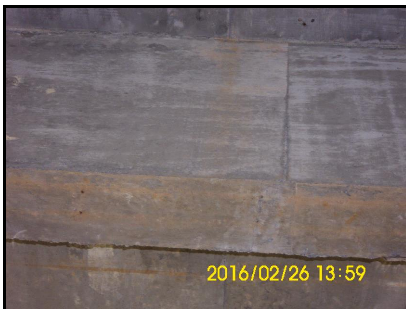
Foto 18 - 1º PAVIMENTO - Fissura transversal em viga.
