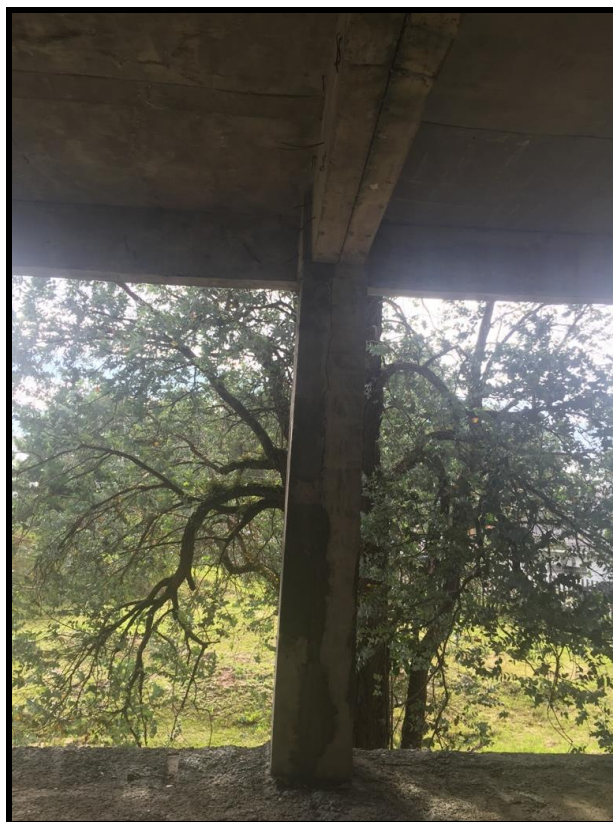
Foto 125 - Manchas de infiltração através da junta de dilatação da estrutura.
