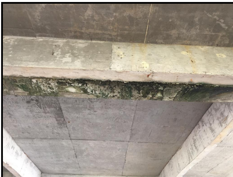
Foto 113 - 2º PAVIMENTO - Cultura de fungos e bolores devido infiltração através da junta de dilatação da estrutura.
