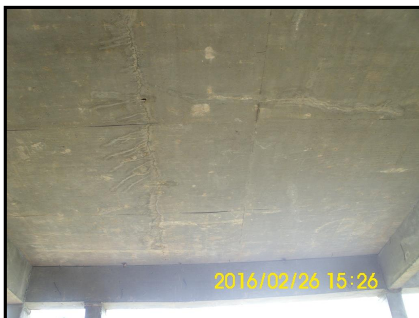
. Foto 84 - 1º PAVIMENTO - Trinca transversal em laje e manchas de infiltração.
