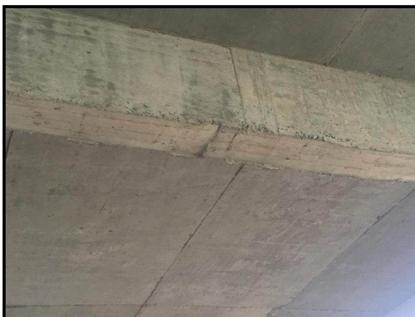
Foto 122 - 2º PAVIMENTO - Mapeamento de armadura devido pequeno cobrimento.
