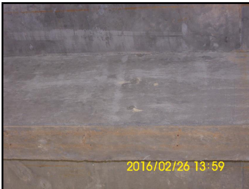
Foto 17 - 1º PAVIMENTO - Fissura transversal em viga.
