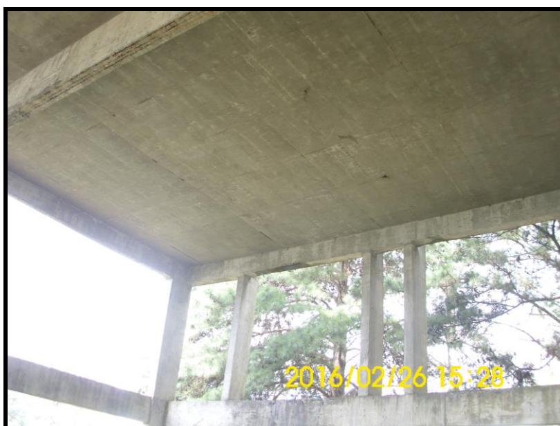
Foto 88 - 2º PAVIMENTO - Mapeamento de armadura devido pequeno cobrimento e peças fora de esquadro.
