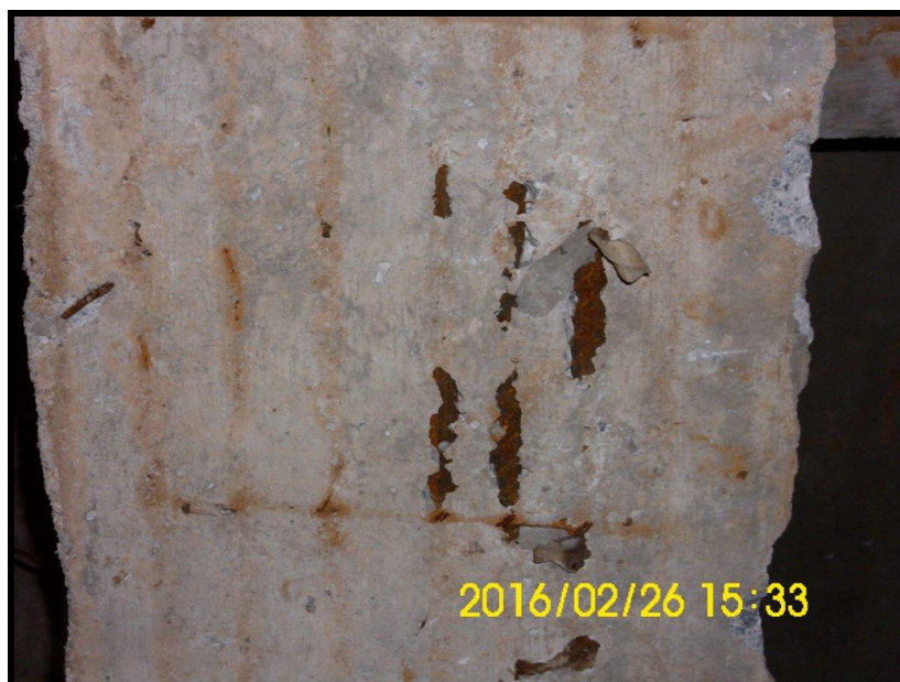
Foto 95 - 1º PAVIMENTO - Detalhe do pequeno cobrimento de viga.
