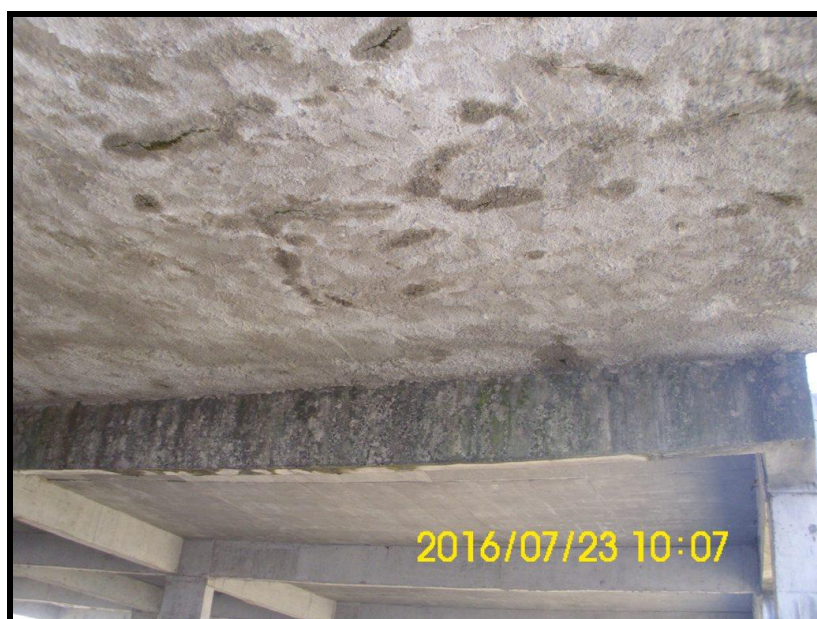
Foto 172 - 3º PAVIMENTO - Manchas de infiltrações em laje e trincas.
