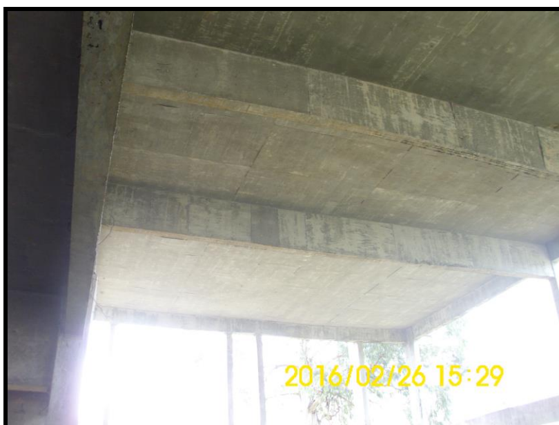
Foto 92 - 2º PAVIMENTO - Mapeamento de armadura devido pequeno cobrimento e peças fora de esquadro.
