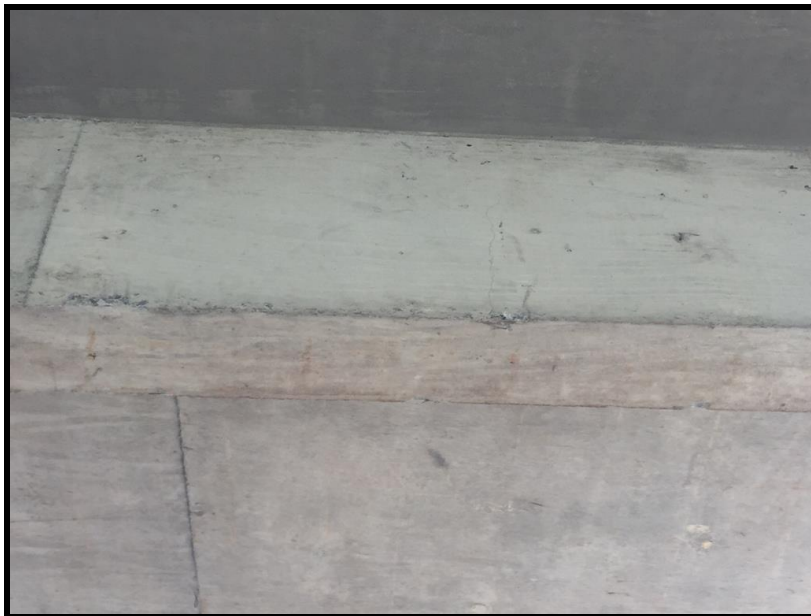
Foto 137 - 2º PAVIMENTO - Trinca transversal em viga.
