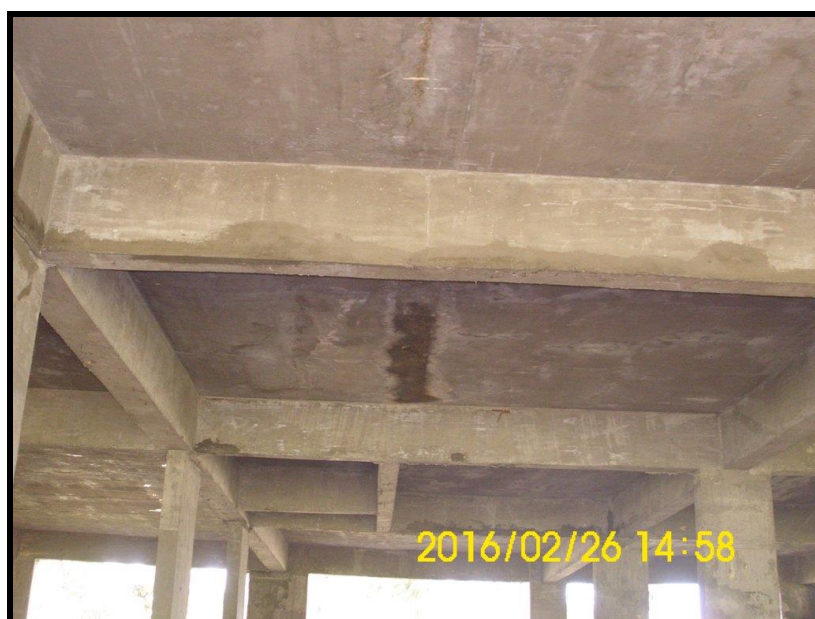
Foto 66 - 1º PAVIMENTO - Manchas em laje provenientes de infiltração.
