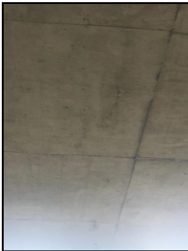
Foto 135 - 2º PAVIMENTO - Trinca transversal em laje e manchas de infiltração.
