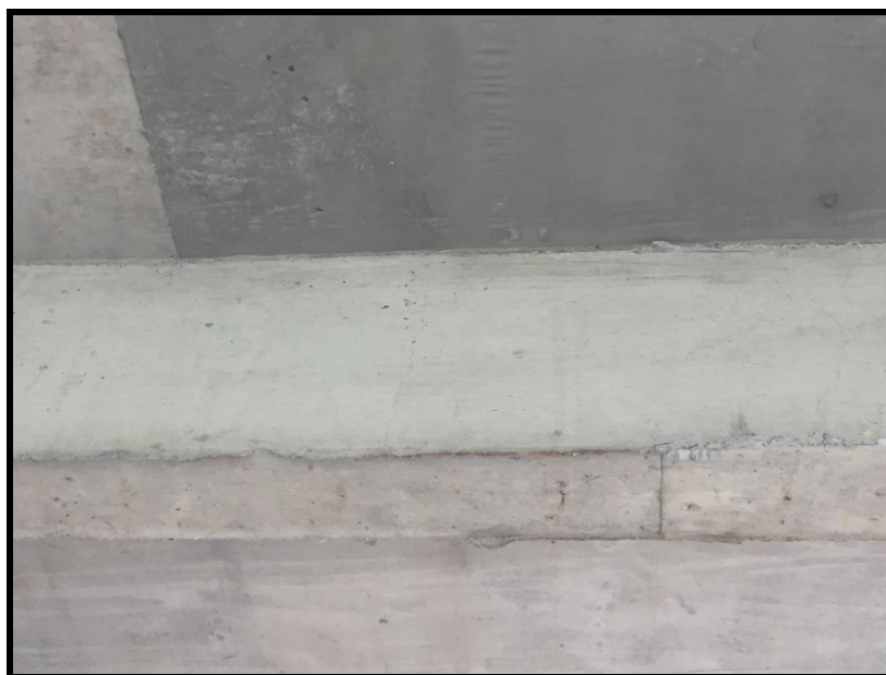
Foto 136 - 2º PAVIMENTO - Trinca transversal em viga.
