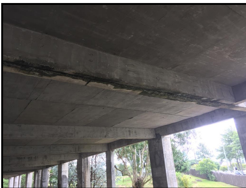
Foto 114 - 2º PAVIMENTO - Cultura de fungos e bolores devido infiltração através da junta de dilatação da estrutura.
