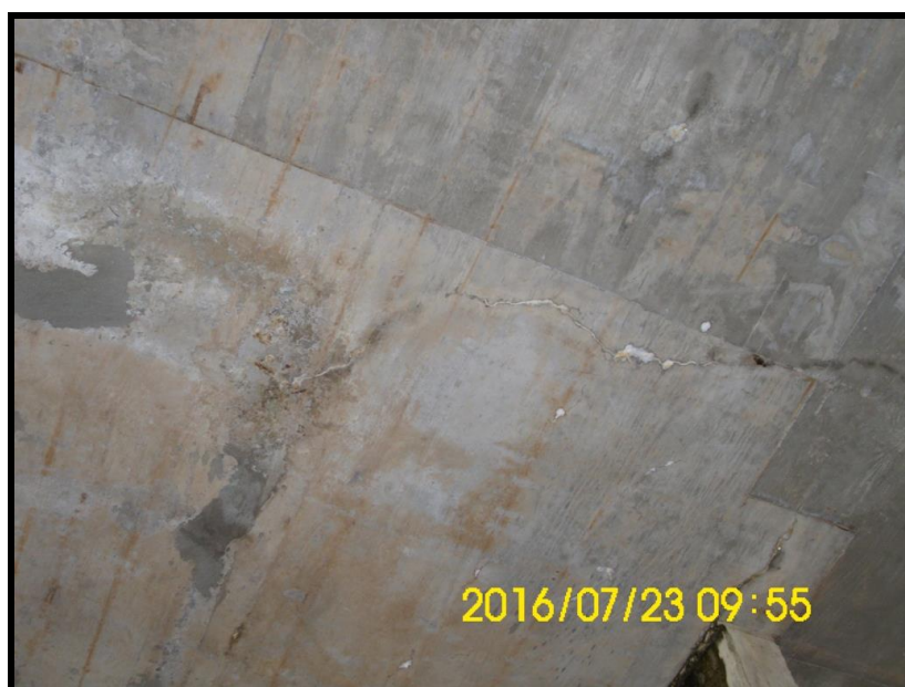
Foto 164 - 3º PAVIMENTO - Manchas de infiltrações em laje.
