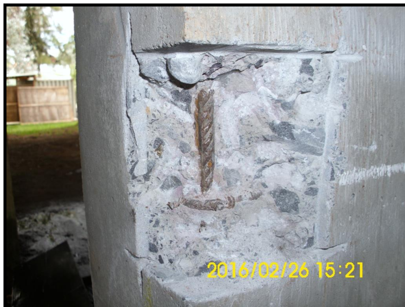
Foto 79 - TÉRREO/BALDRAMES - Testemunho retirado de trecho de pilar.
