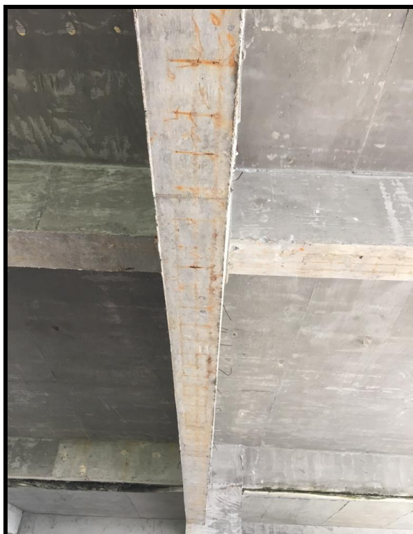
Foto 107 - 2º PAVIMENTO - Mapeamento de armadura devido pequeno cobrimento.
