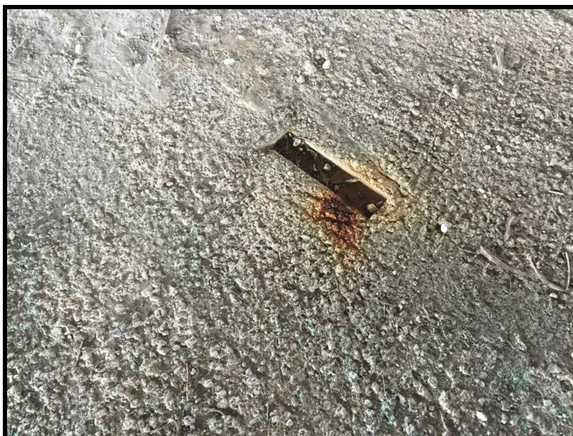
Foto 119 - 2º PAVIMENTO - Manchas na laje devido corrosão citada na foto anterior.
