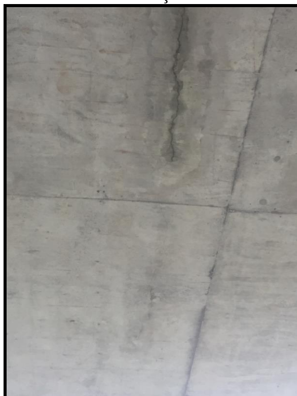
Foto 134 - 2º PAVIMENTO - Trinca transversal em laje e manchas de infiltração.
