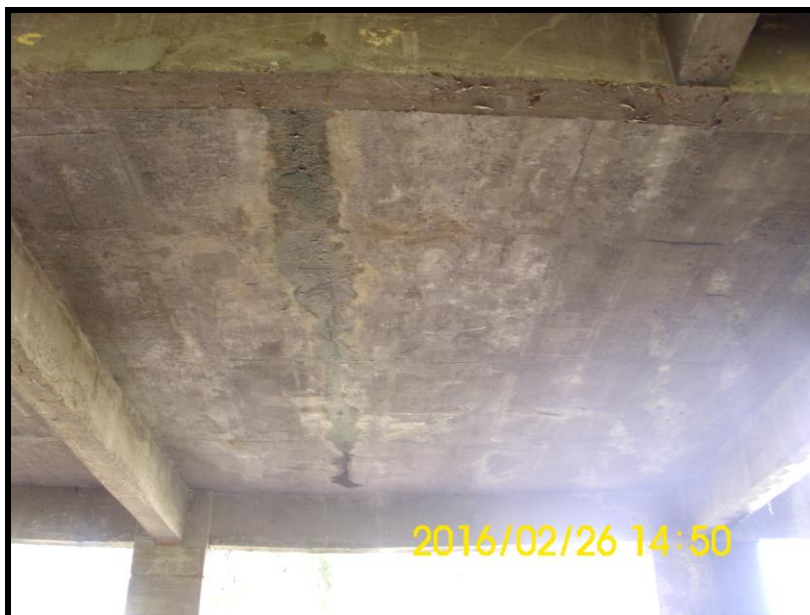
Foto 59 - 1º PAVIMENTO - Trinca transversal em laje e manchas de infiltração.
