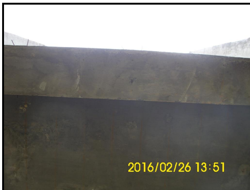
Foto 6 - 1º PAVIMENTO - Armadura exposta devido deslocamento de concreto. É possível notar pequeno cobrimento.
