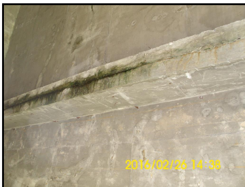
Foto 46 - 1º PAVIMENTO - Manchas provenientes de infiltração em junta de dilatação da estrutura.
