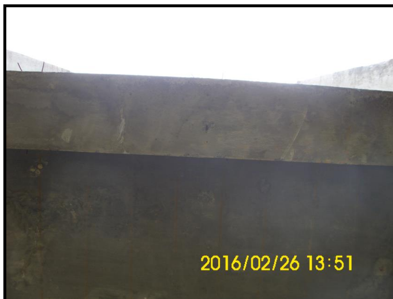
Foto 7 - 1º PAVIMENTO - Armadura exposta devido deslocamento de concreto. É possível notar pequeno cobrimento.
