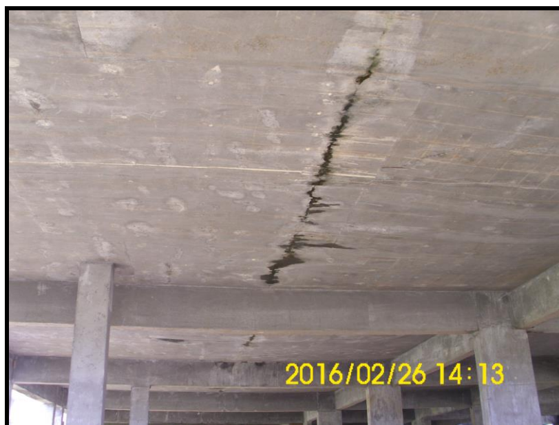
Foto 29 - 1º PAVIMENTO - Mapeamento de armadura e trinca longitudinal com manchas de infiltração.
