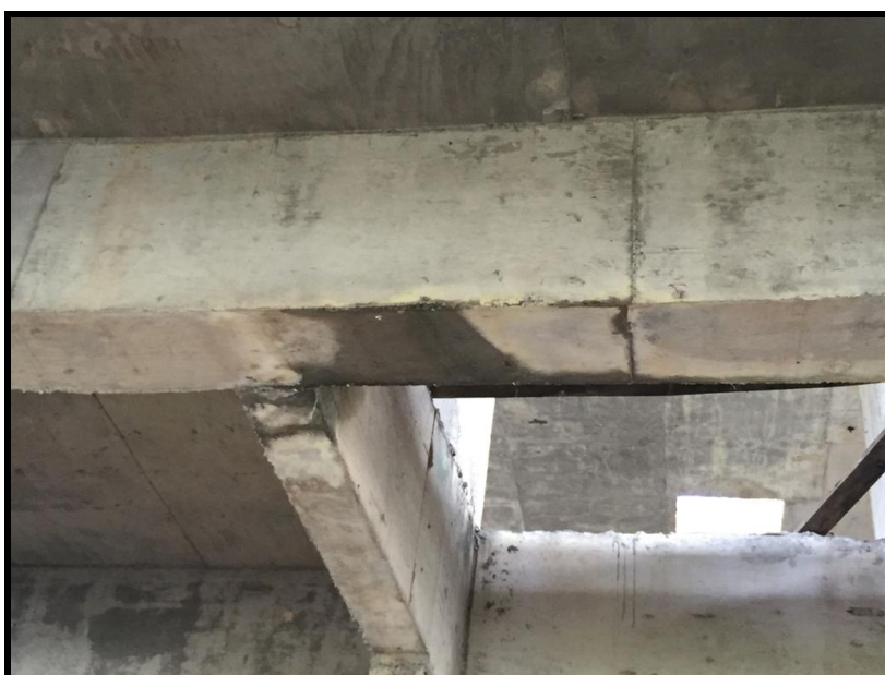
Foto 120 - 2º PAVIMENTO - Manchas de escoamento de água pela estrutura.
