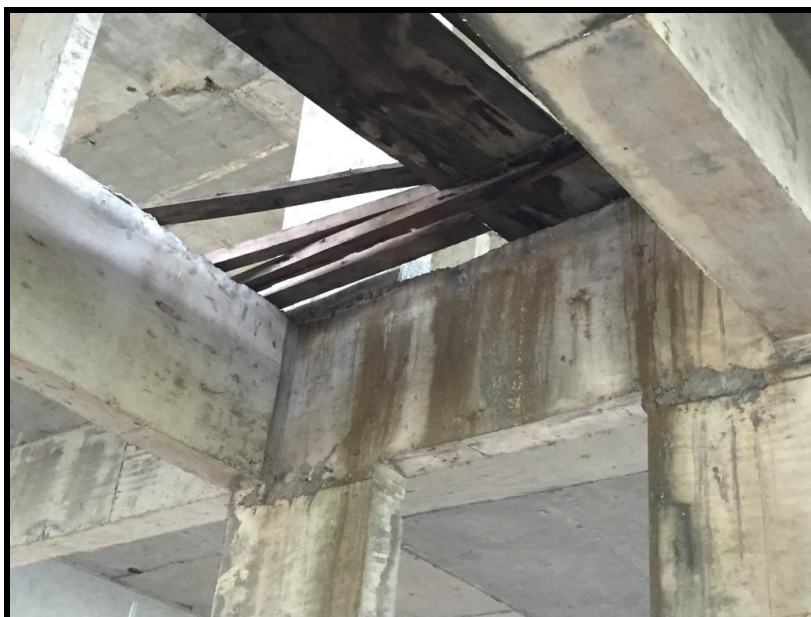
Foto 121 - 2º PAVIMENTO - Manchas de escoamento de água pela estrutura.
