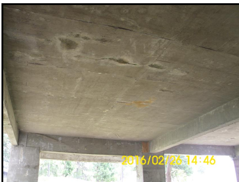
Foto 52 - 1º PAVIMENTO - Trinca em laje.
