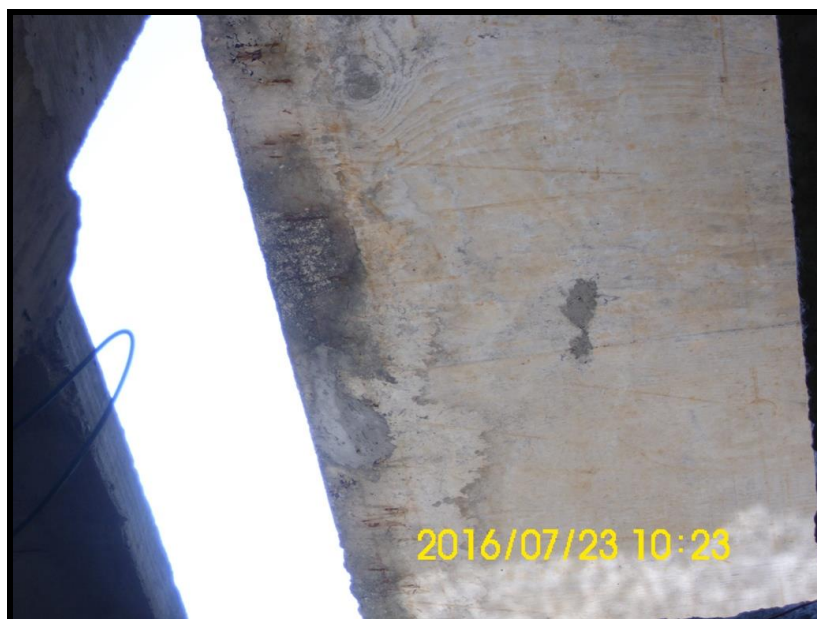
Foto 177 - 3º PAVIMENTO - Armadura exposta e manchas de infiltração em laje.
