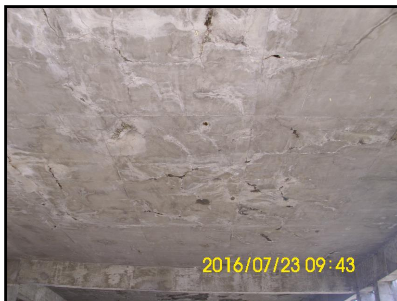
Foto 148 - 3º PAVIMENTO - Manchas de infiltrações em laje.
