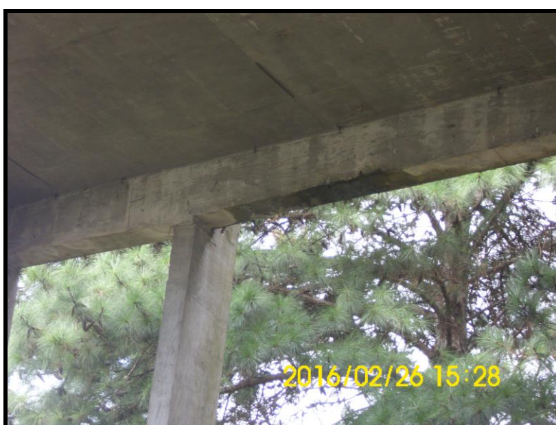
Foto 90 - 1º PAVIMENTO - Mapeamento de armadura devido pequeno cobrimento e peças fora de esquadro.
