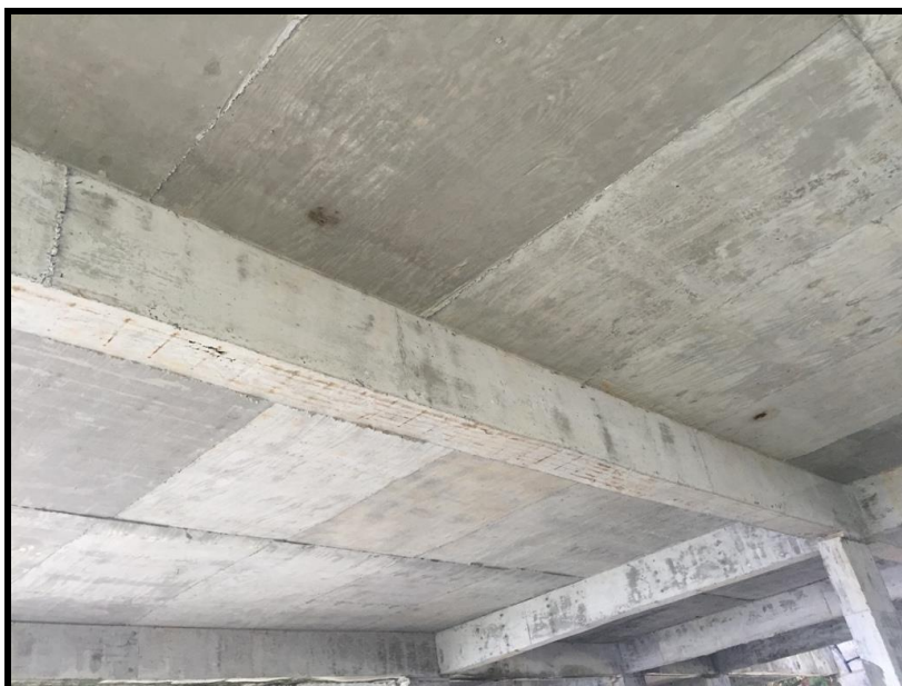
Foto 117 - 2º PAVIMENTO - Mapeamento de armadura devido pequeno cobrimento.
