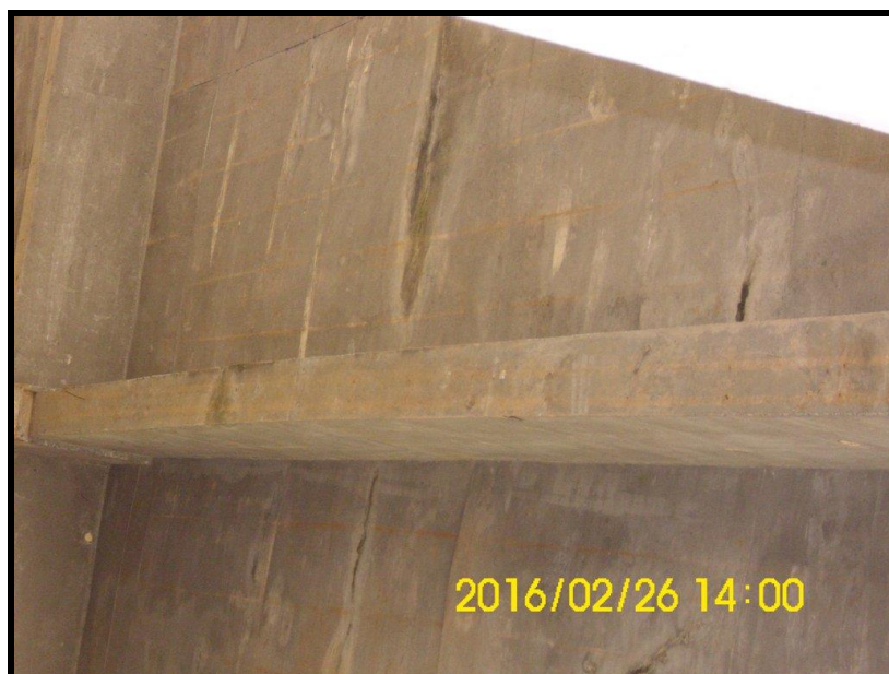
Foto 19 - 1º PAVIMENTO - Viga com fissuras transversais.
