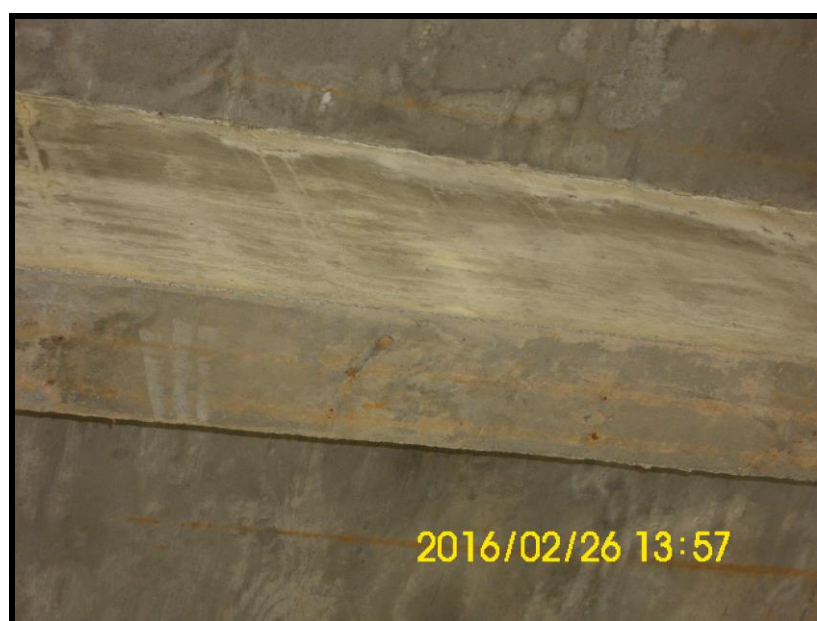
Foto 14 - 1º PAVIMENTO - Fissura transversal em viga.
