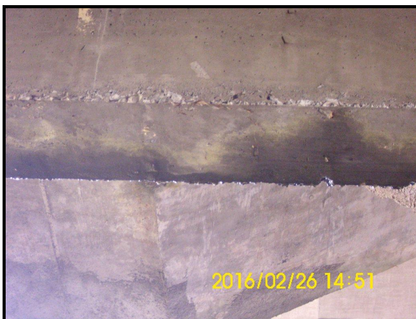
Foto 60 - 1º PAVIMENTO - Nichos de concretagem e manchas de infiltração.
