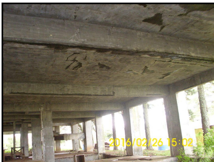
Foto 68 - 1º PAVIMENTO - Manchas em laje provenientes de infiltração.
