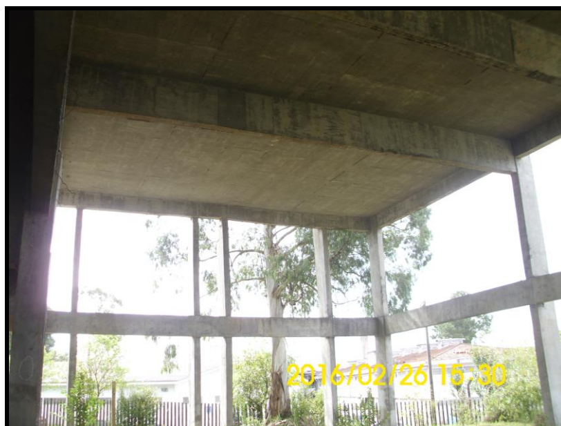
Foto 93 - 2º PAVIMENTO - Mapeamento de armadura devido pequeno cobrimento e peças fora de esquadro.
