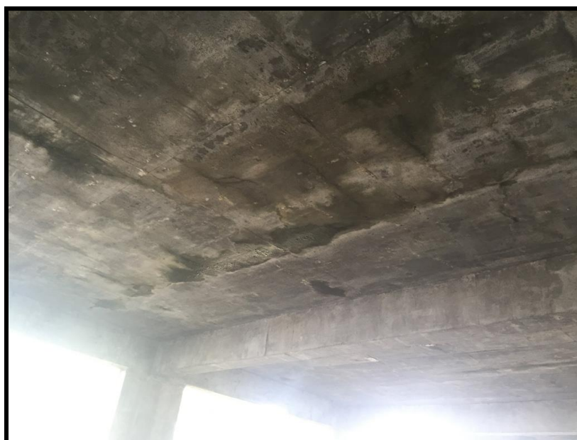
Foto 126 - 2º PAVIMENTO - Manchas de infiltração em laje.
