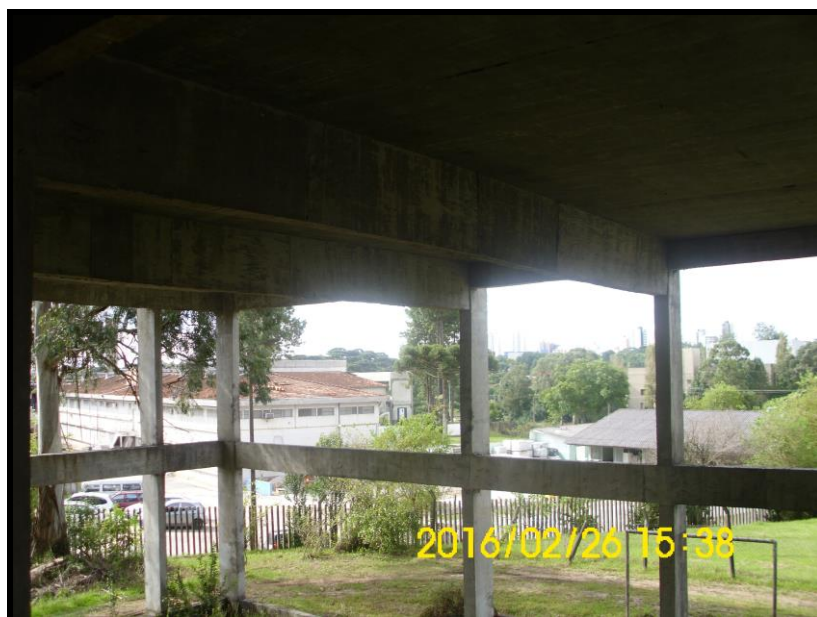
Foto 99 - 2º PAVIMENTO - Mapeamento de armadura devido pequeno cobrimento e peças fora de esquadro.
