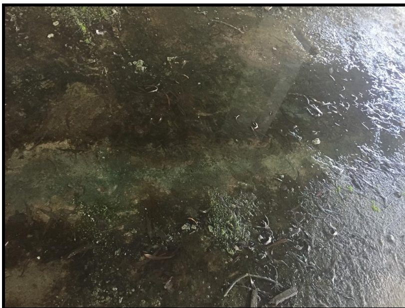
Foto 130 - 1º PAVIMENTO - Cultura de fungos e bolores em laje devido infiltração através da junta de dilatação da estrutura.
