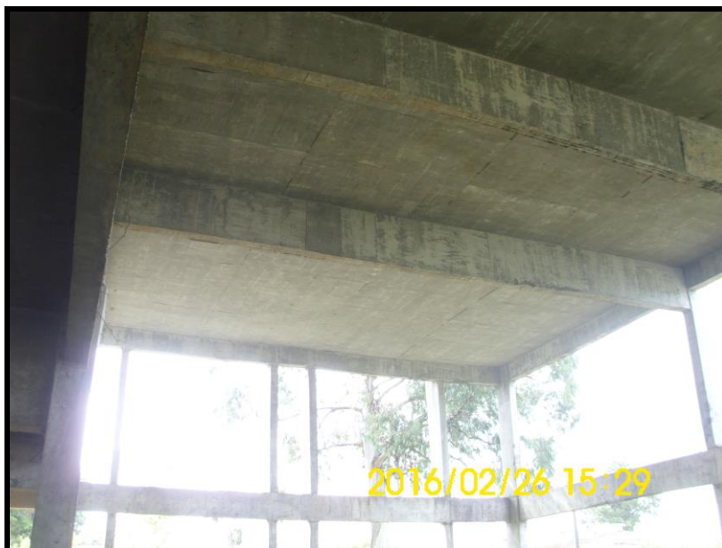
Foto 91 - 2º PAVIMENTO - Mapeamento de armadura devido pequeno cobrimento e peças fora de esquadro.
