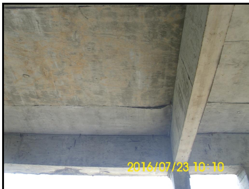
Foto 175 - 3º PAVIMENTO - Desaprumo em laje devido erro durante concretagem.
