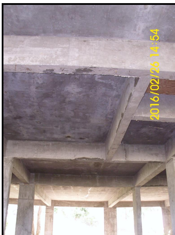
Foto 64 - 1º PAVIMENTO - Manchas em laje provenientes de infiltração.
