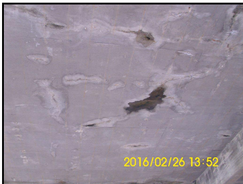
Foto 9 - 1º PAVIMENTO - Mapeamento de armadura, trincas e manchas de infiltração na laje.
