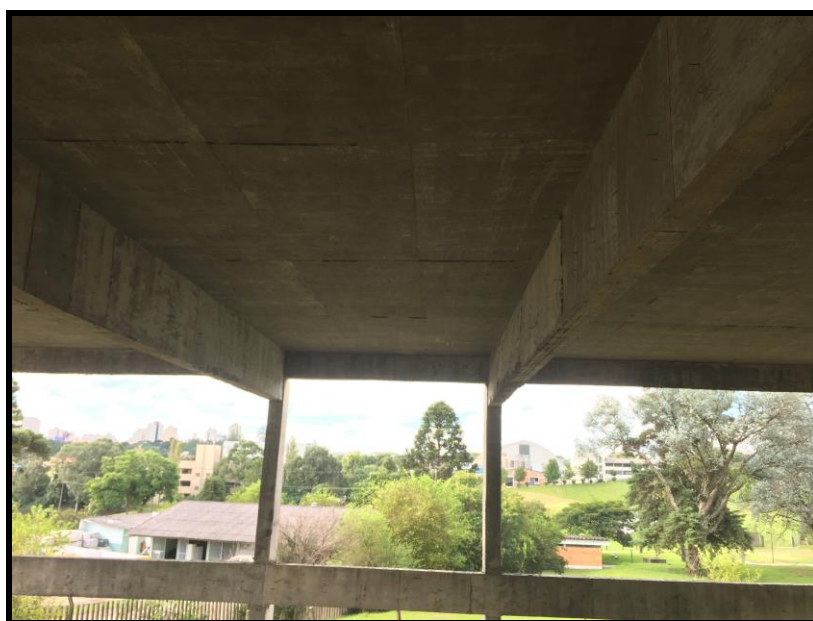
Foto 102 - 2º PAVIMENTO - Mapeamento de armadura devido pequeno cobrimento em vigas.
