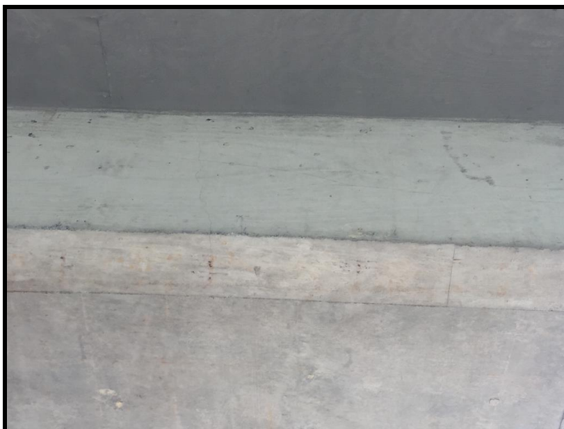
Foto 139 - 2º PAVIMENTO - Trinca transversal em viga.
