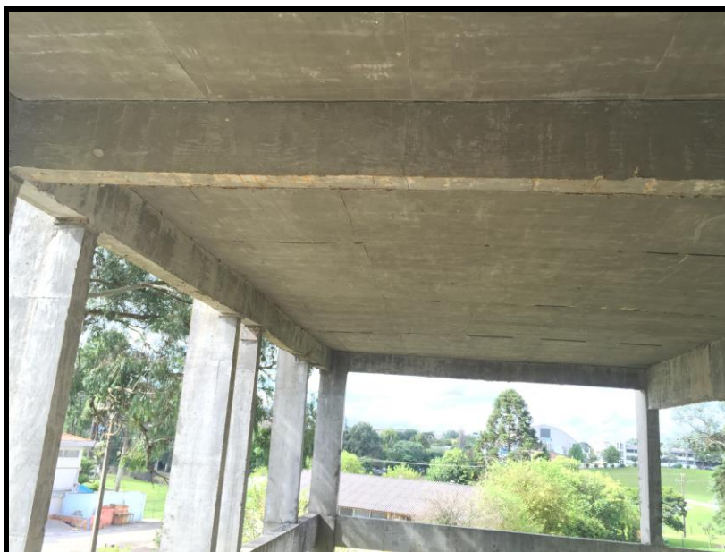
Foto 105 - 2º PAVIMENTO - Mapeamento de armadura devido pequeno cobrimento em vigas.
