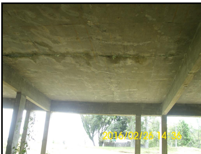
Foto 42 - 1º PAVIMENTO - Desaprumo em viga devido erro durante concretagem.
