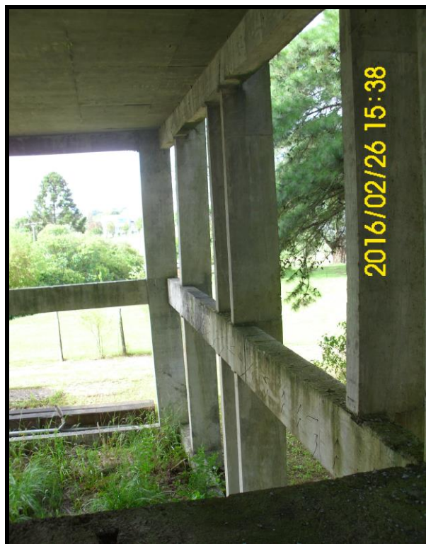
Foto 97 - 2º PAVIMENTO - Mapeamento de armadura devido pequeno cobrimento e peças fora de esquadro.
