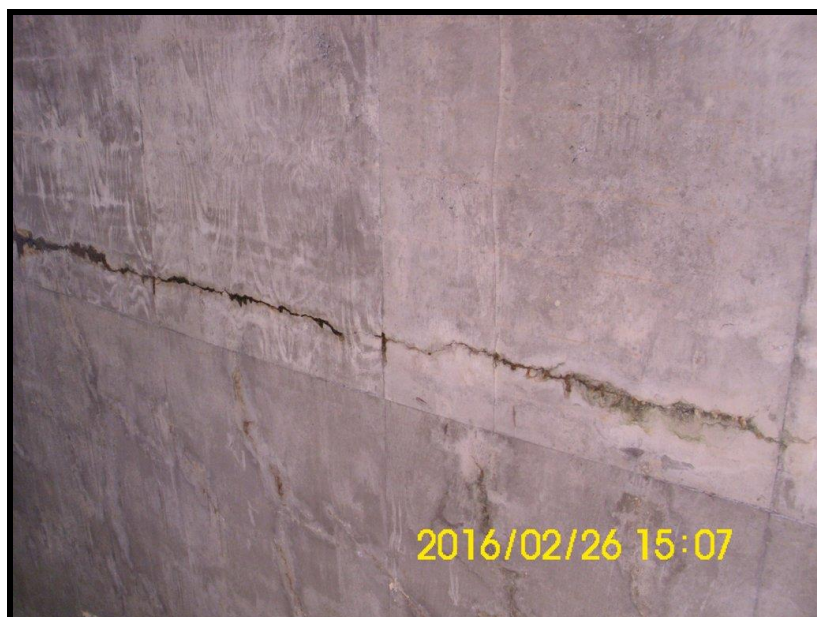
Foto 69 - 1º PAVIMENTO - Trinca transversal em laje e manchas de infiltração.
