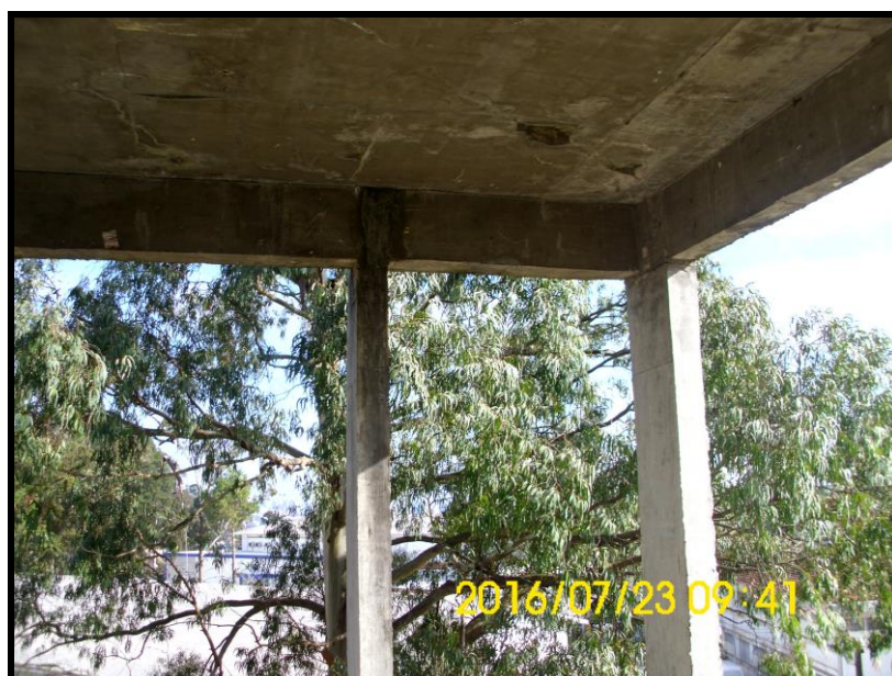
Foto 142 - 2º PAVIMENTO - Manchas de infiltrações em laje e pilar.
