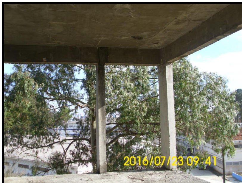
Foto 141 - 2º PAVIMENTO - Manchas de infiltrações em laje e pilar.
