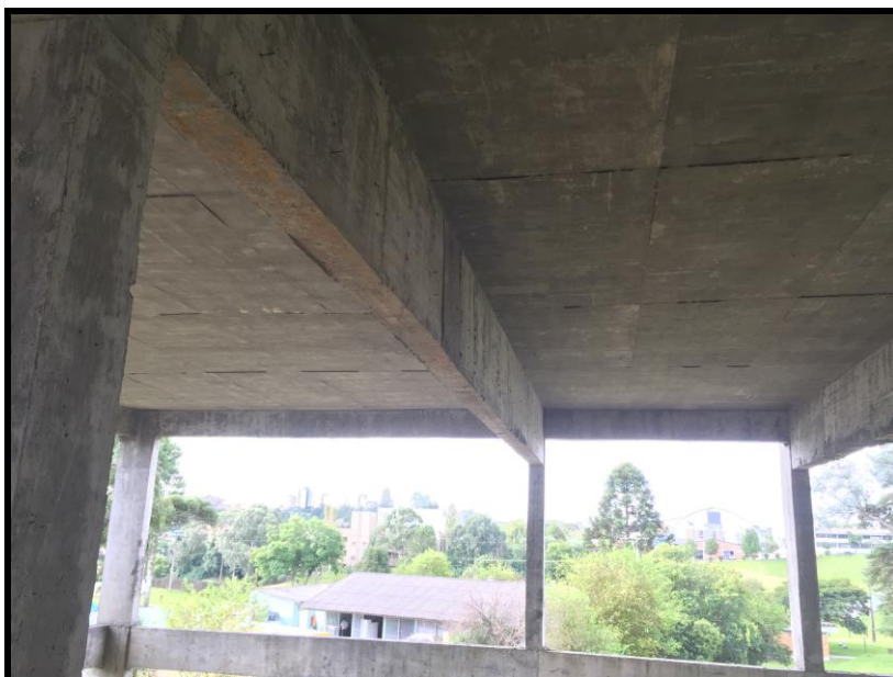
Foto 103 - 2º PAVIMENTO - Mapeamento de armadura devido pequeno cobrimento em vigas.
