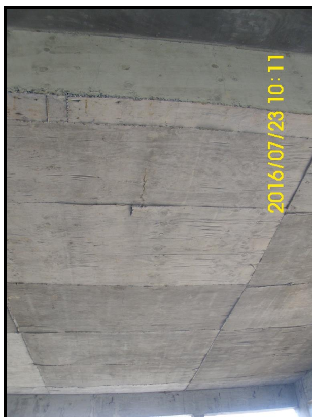
Foto 176 - 3º PAVIMENTO - Desaprumo em laje devido erro durante concretagem.
