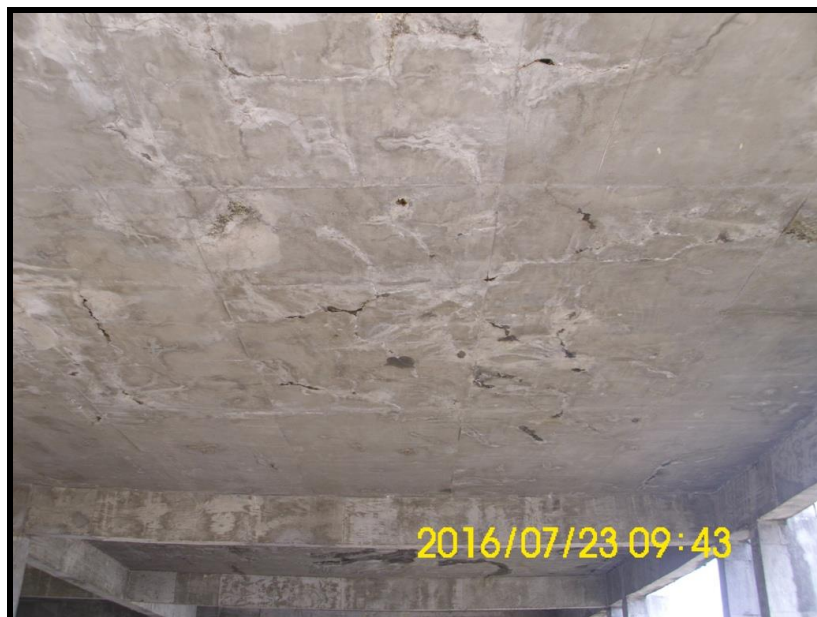
Foto 147 - 3º PAVIMENTO - Manchas de infiltrações em laje.
