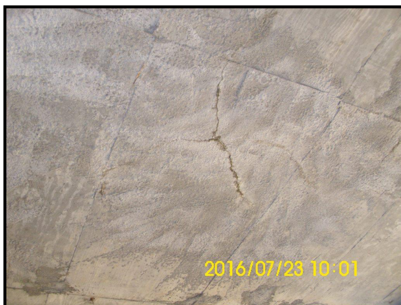
Foto 168 - 3º PAVIMENTO - Manchas de infiltrações em laje.
