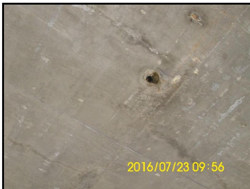
Foto 165 - 3º PAVIMENTO - Manchas de infiltrações em laje.
