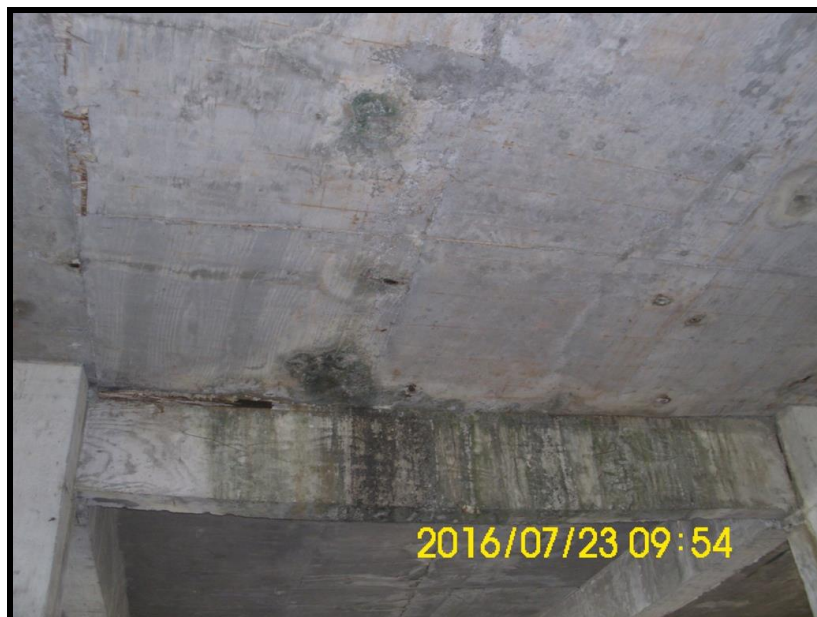
Foto 163 - 3º PAVIMENTO - Manchas provenientes de infiltração em laje e viga.
