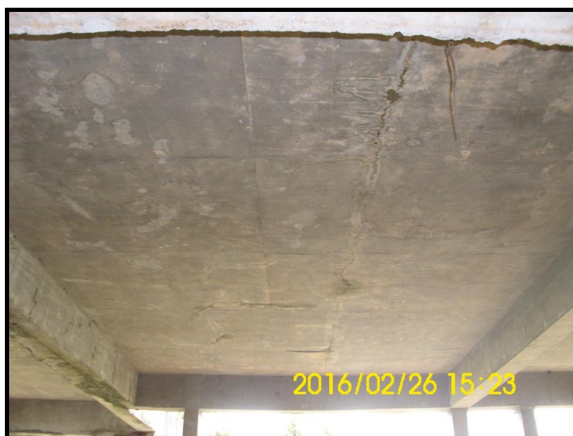
Foto 80 - 1º PAVIMENTO - Trinca transversal em laje e manchas de infiltração.
