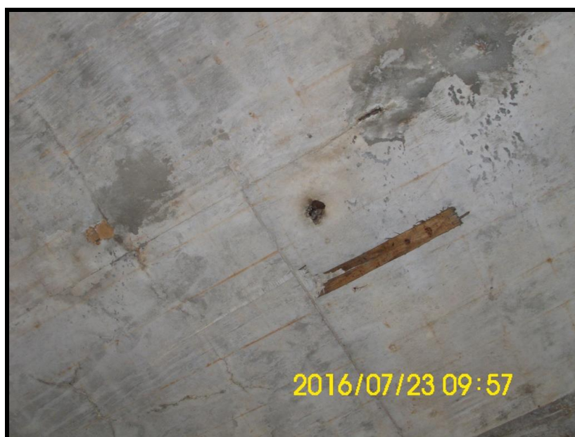
Foto 166 - 3º PAVIMENTO - Manchas de infiltrações em laje.
