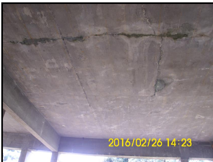
Foto 33 - 1º PAVIMENTO - Mapeamento de armadura e trinca longitudinal com manchas de infiltração.
