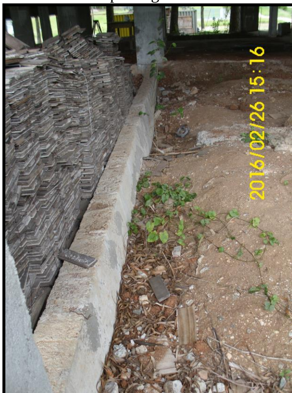
Foto 76 - TÉRREO/BALDRAMES – Viga baldrame fora de esquadro.
