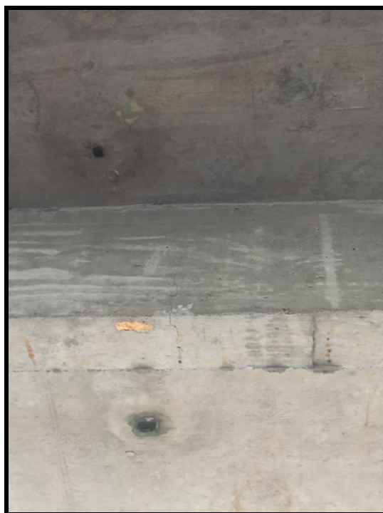
Foto 132 - 2º PAVIMENTO - Trinca transversal em viga.
