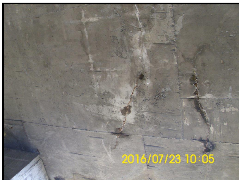
Foto 171 - 3º PAVIMENTO - Manchas de infiltrações em laje e trincas.
