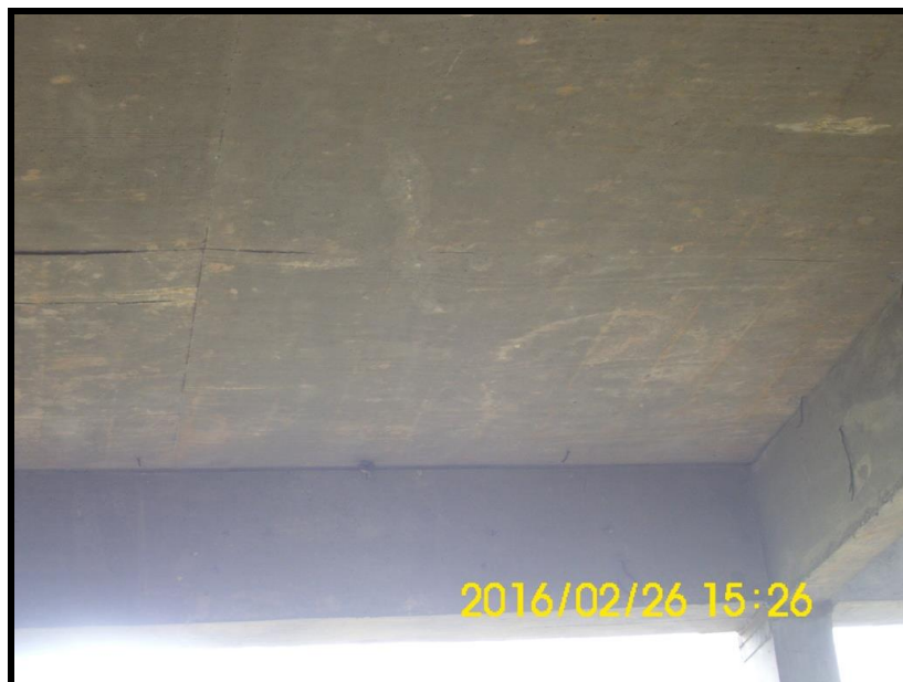
Foto 85 - 1º PAVIMENTO - Mapeamento de armadura devido pequeno cobrimento
