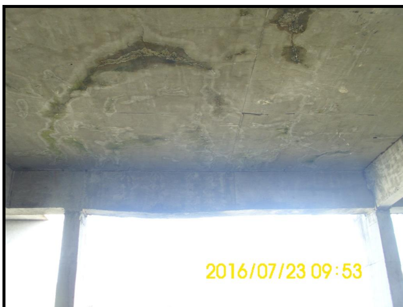
Foto 162 - 3º PAVIMENTO - Desaprumo em viga devido erro durante concretagem.
