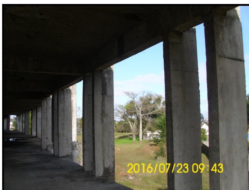
Foto 146 – 2º PAVIMENTO - Pilares fora de prumo.
