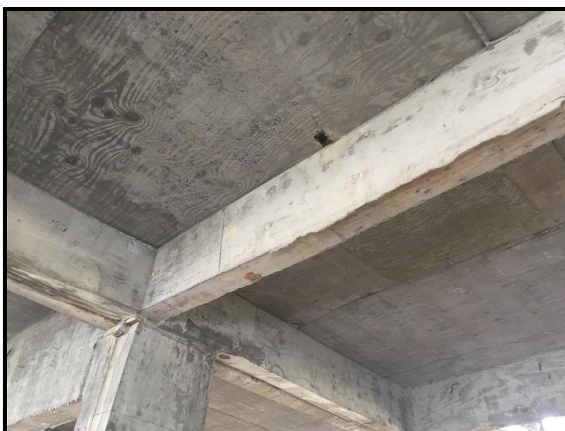
Foto 118 - 2º PAVIMENTO - Mapeamento de armadura devido pequeno cobrimento, bem como escoamento de produtos de corrosão.
