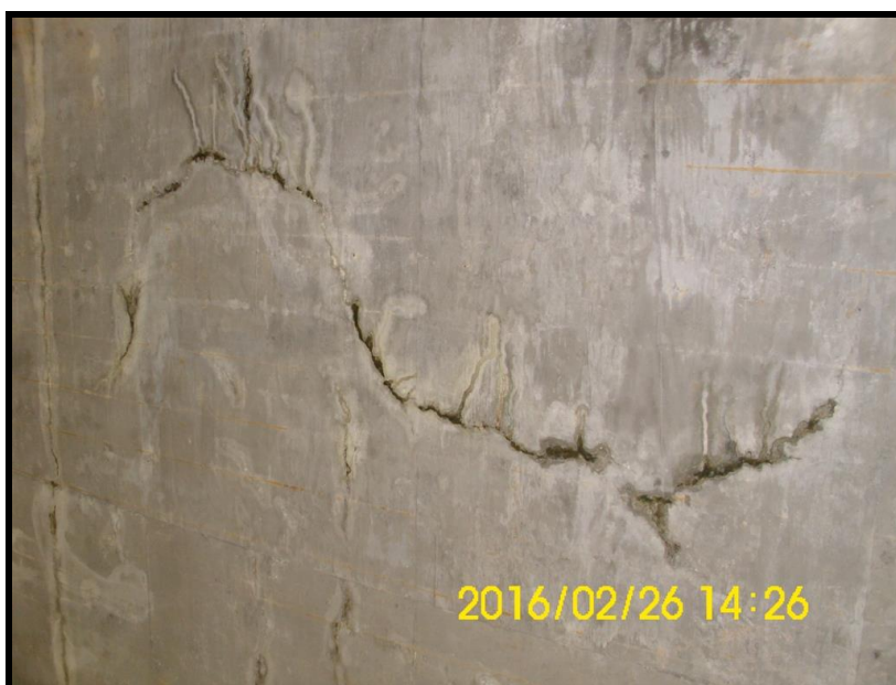
Foto 36 - 1º PAVIMENTO - Mapeamento de armadura e trinca longitudinal com manchas de infiltração.
