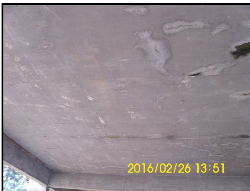
Foto 8 - 1º PAVIMENTO - Mapeamento de armadura devido pequeno cobrimento.
