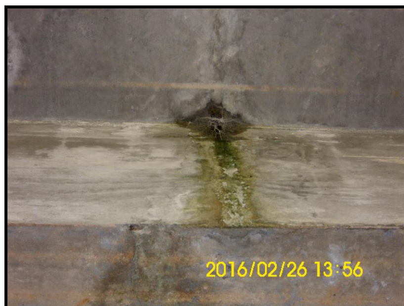
Foto 10 - 1º PAVIMENTO - Fissura e mancha de infiltração em viga.
