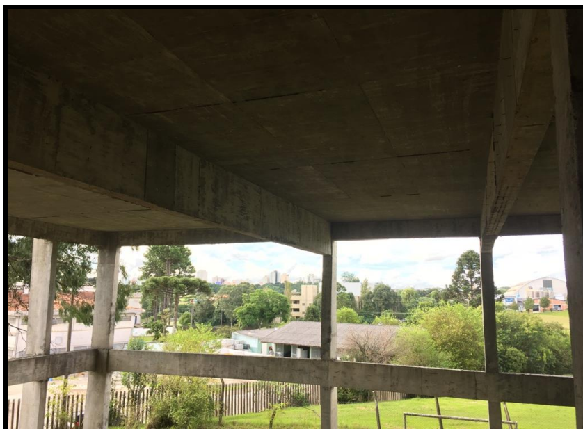
Foto 101 - 2º PAVIMENTO - Mapeamento de armadura devido pequeno cobrimento em vigas.
