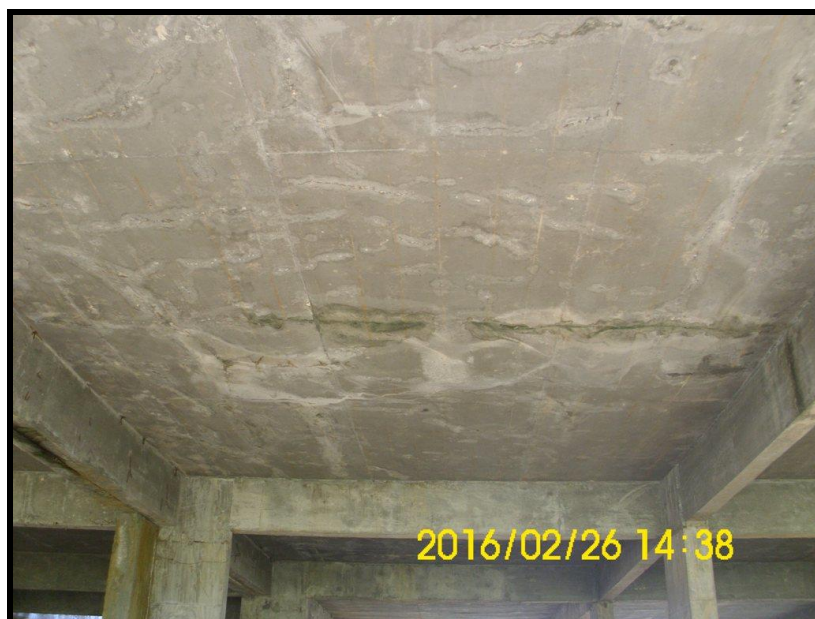
Foto 45 - 1º PAVIMENTO - Mapeamento de armadura e trinca longitudinal com manchas de infiltração.
