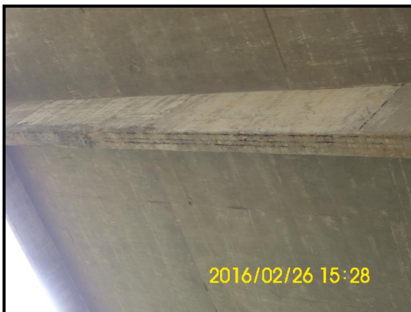
Foto 89 - 2º PAVIMENTO - Mapeamento de armadura devido pequeno cobrimento e peças fora de esquadro.
