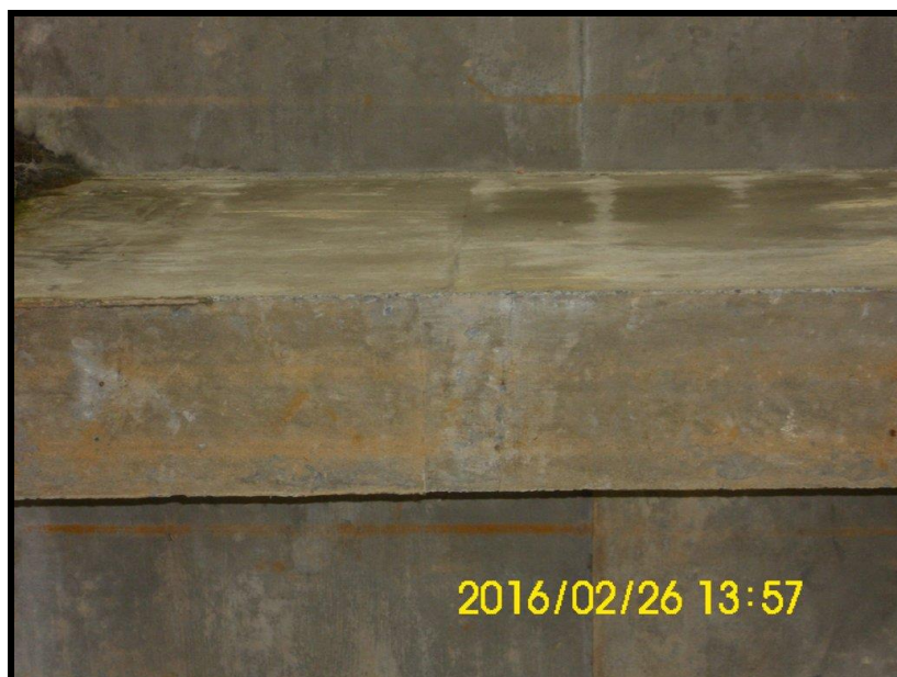
Foto 13 - 1º PAVIMENTO - Fissura transversal em viga.
