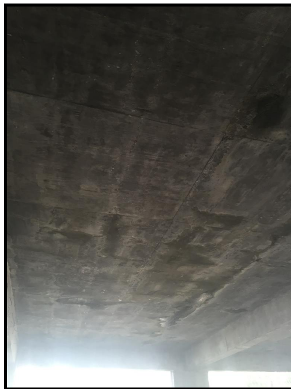
Foto 128 - 2º PAVIMENTO - Manchas de infiltração em laje.
