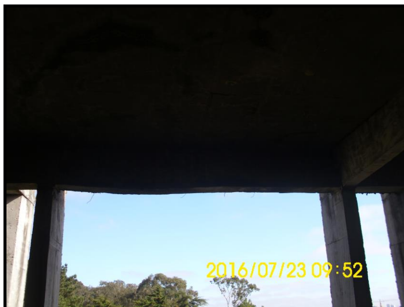
Foto 161 - 3º PAVIMENTO - Desaprumo em viga devido erro durante concretagem.
