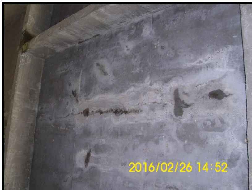
Foto 63 - 1º PAVIMENTO - Trinca transversal em laje e manchas de infiltração.
