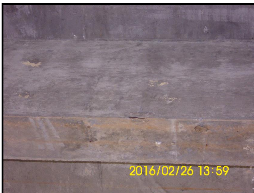
Foto 16 - 1º PAVIMENTO - Fissura transversal em viga.
