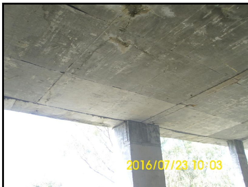
Foto 169 - 3º PAVIMENTO - Manchas de infiltrações em laje.
