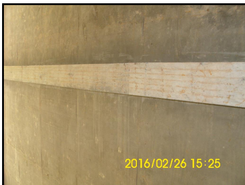
Foto 82 - 1º PAVIMENTO - Mapeamento de armadura devido pequeno cobrimento.
