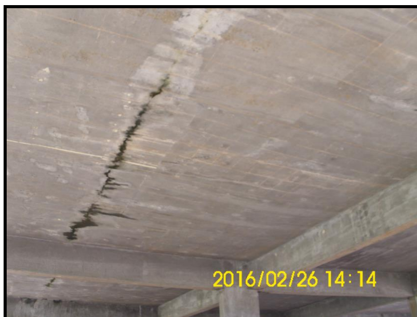
Foto 30 - 1º PAVIMENTO - Mapeamento de armadura e trinca longitudinal com manchas de infiltração.
