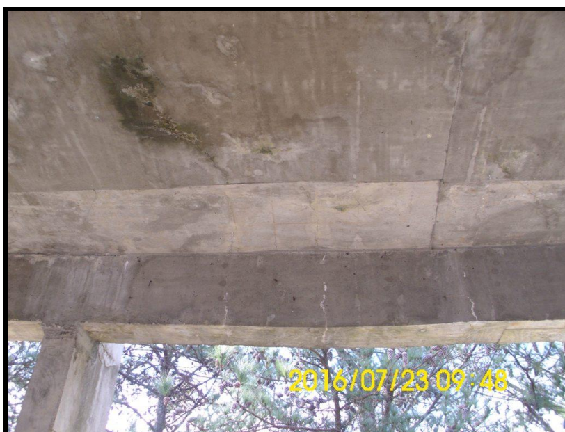
Foto 156 - 3º PAVIMENTO - Trincas em viga e manchas de infiltração em laje.
