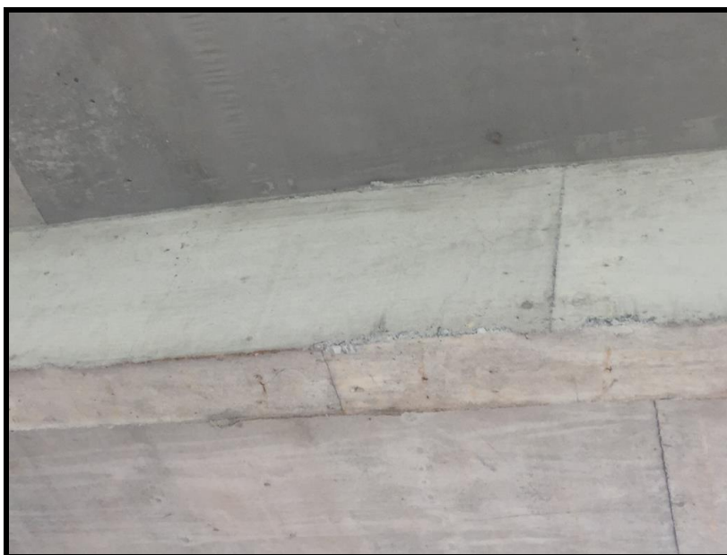
Foto 138 - 2º PAVIMENTO - Trinca transversal em viga.
