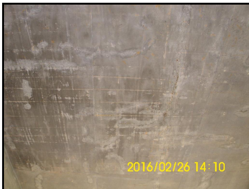
Foto 27 - 1º PAVIMENTO - Mapeamento de armadura devido pequeno cobrimento.
