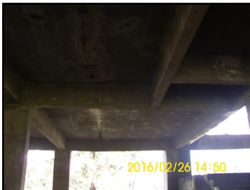
Foto 57 - 1º PAVIMENTO - Trinca transversal em laje e manchas de infiltração.
