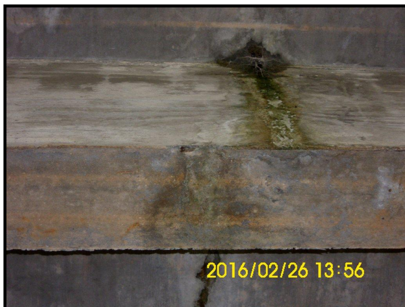
Foto 11 - 1º PAVIMENTO - Fissura e mancha de infiltração em viga.
