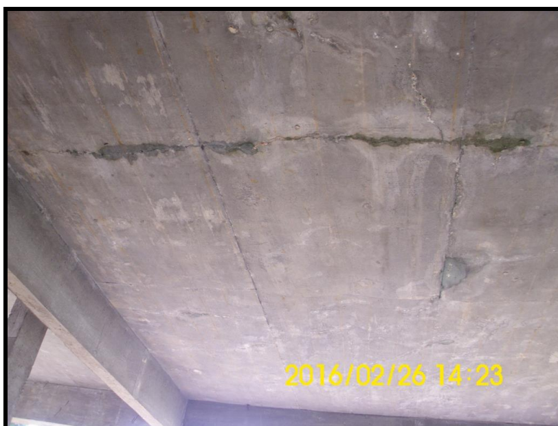
Foto 34 - 1º PAVIMENTO - Mapeamento de armadura e trinca longitudinal com manchas de infiltração.
