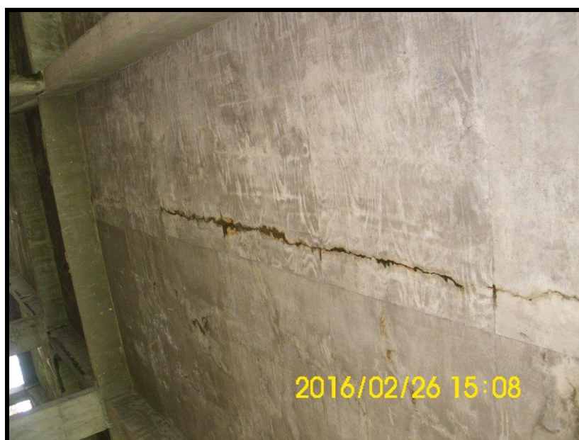
Foto 70 - 1º PAVIMENTO - Trinca transversal em laje e manchas de infiltração.
