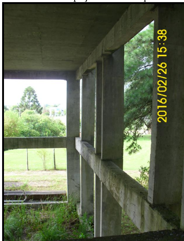
Foto 98 - 2º PAVIMENTO - Mapeamento de armadura devido pequeno cobrimento e peças fora de esquadro.
