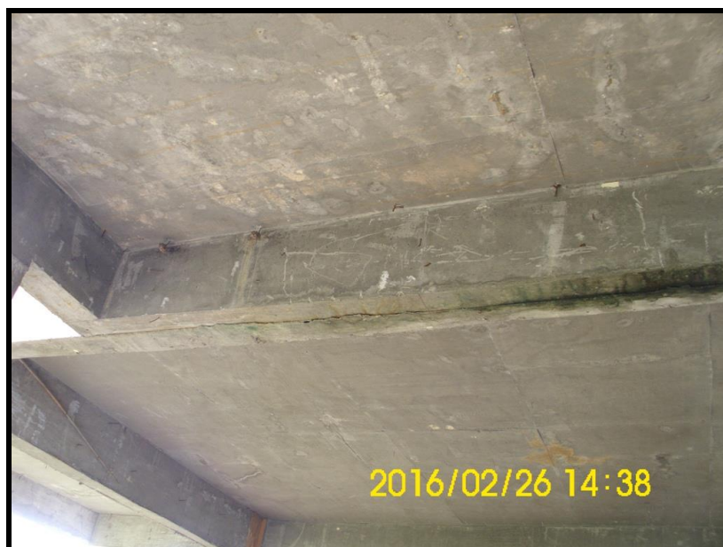
Foto 47 - 1º PAVIMENTO - Manchas provenientes de infiltração em junta de dilatação da estrutura.
