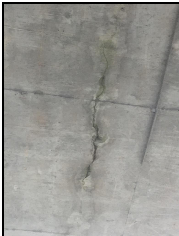
Foto 133 - 2º PAVIMENTO - Trinca transversal em laje e manchas de infiltração.
