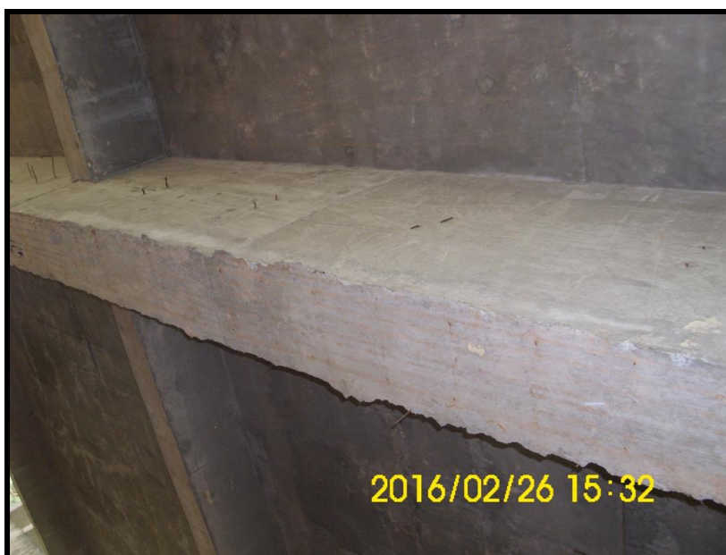
Foto 94 - 1º PAVIMENTO - Mapeamento de armadura devido pequeno cobrimento.
