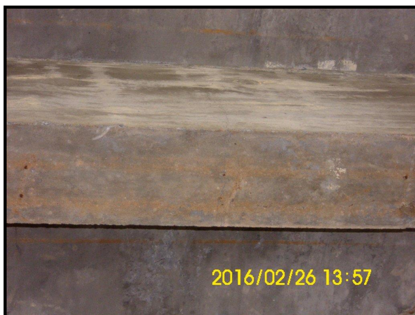
Foto 12 - 1º PAVIMENTO - Fissura transversal em viga.
