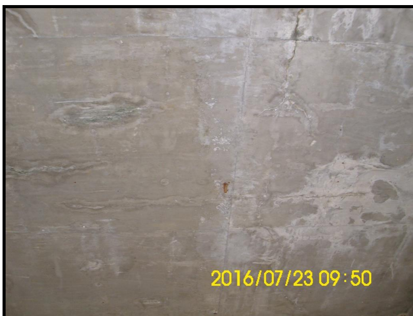
Foto 160 - 3º PAVIMENTO - Manchas de infiltrações em laje.
