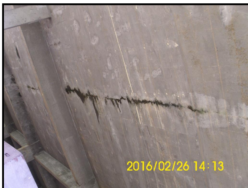
Foto 28 - 1º PAVIMENTO - Mapeamento de armadura e trinca longitudinal com manchas de infiltração.
