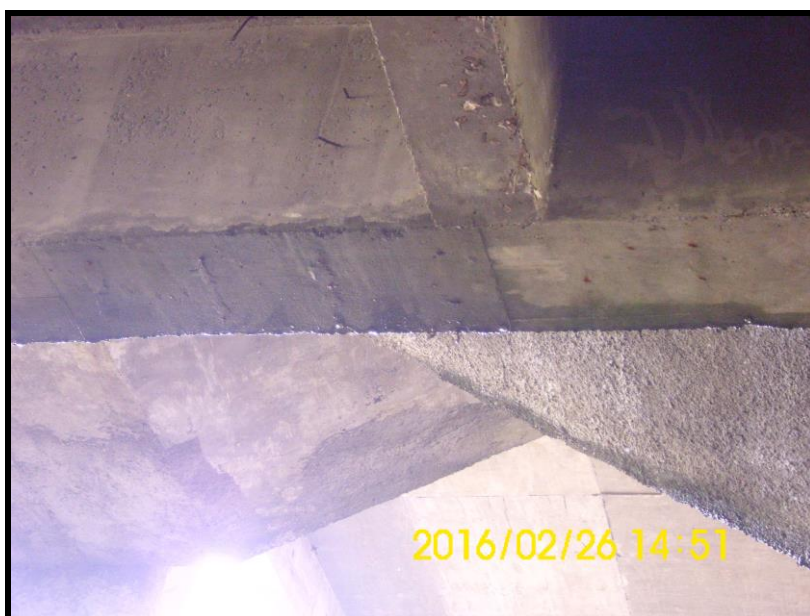
Foto 62 - 1º PAVIMENTO - Nichos de concretagem e manchas de infiltração.
