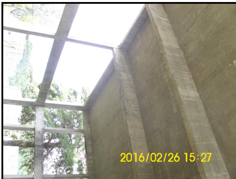
Foto 87 - 2º PAVIMENTO - Mapeamento de armadura devido pequeno cobrimento e peças fora de esquadro.
