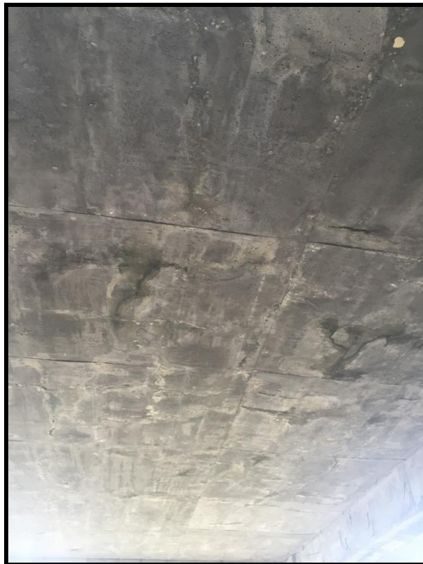
Foto 127 - 2º PAVIMENTO - Manchas de infiltração em laje.
