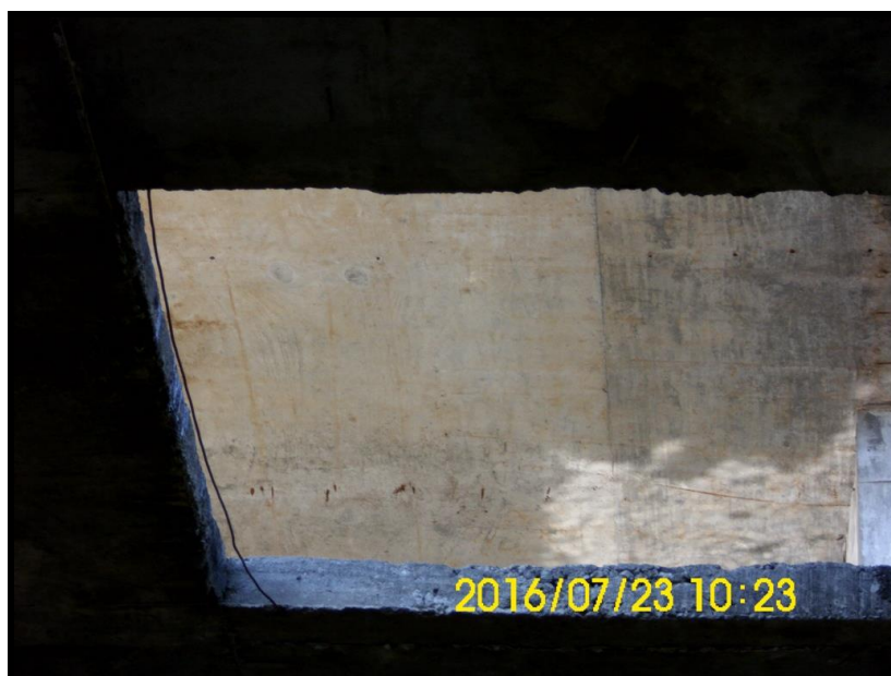
Foto 178 - 3º PAVIMENTO - Mapeamento de armadura devido pequeno cobrimento.
