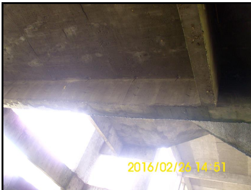
Foto 61 - 1º PAVIMENTO - Nichos de concretagem e manchas de infiltração.
