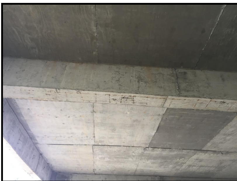
Foto 116 - 2º PAVIMENTO - Mapeamento de armadura devido pequeno cobrimento.
