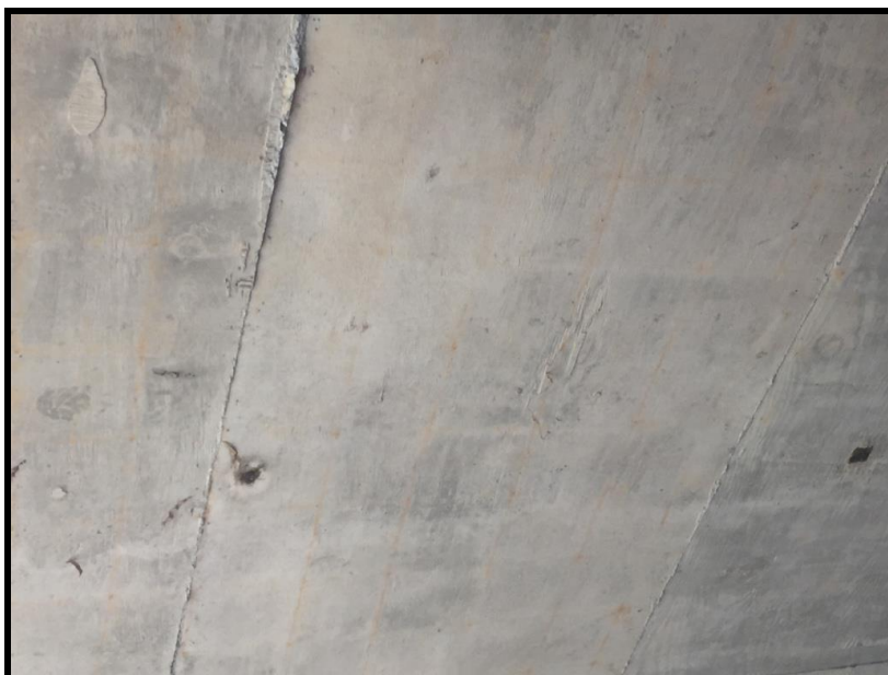
Foto 123 - 2º PAVIMENTO - Mapeamento de armadura devido pequeno cobrimento.
