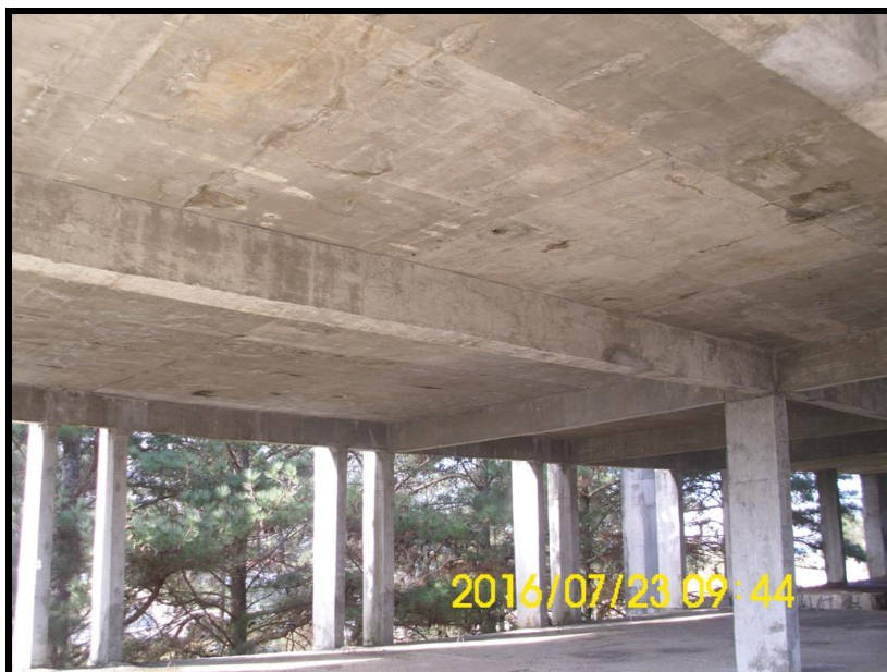
Foto 151 - 3º PAVIMENTO - Manchas de infiltrações em laje.
