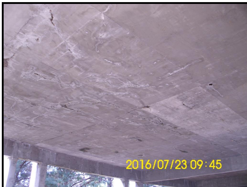
Foto 153 - 3º PAVIMENTO - Manchas de infiltrações em laje.
