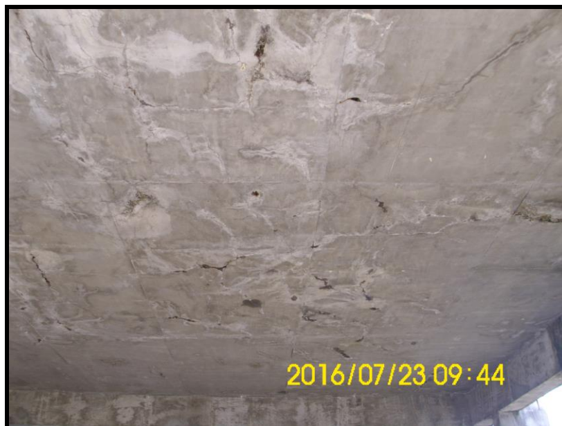
Foto 149 - 3º PAVIMENTO - Manchas de infiltrações em laje.
