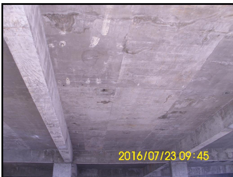
Foto 152 - 3º PAVIMENTO - Manchas de infiltrações em laje.
