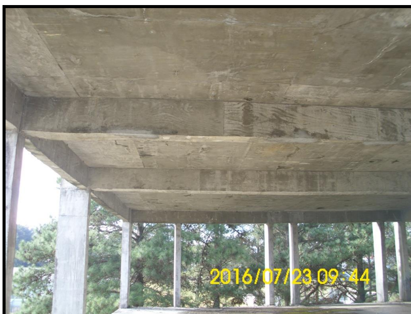
Foto 150 - 3º PAVIMENTO - Manchas de infiltrações em laje.
