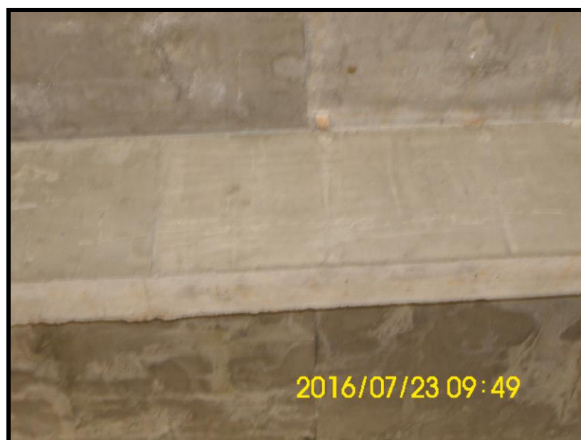
Foto 158 - 3º PAVIMENTO - Fissuras em viga.
