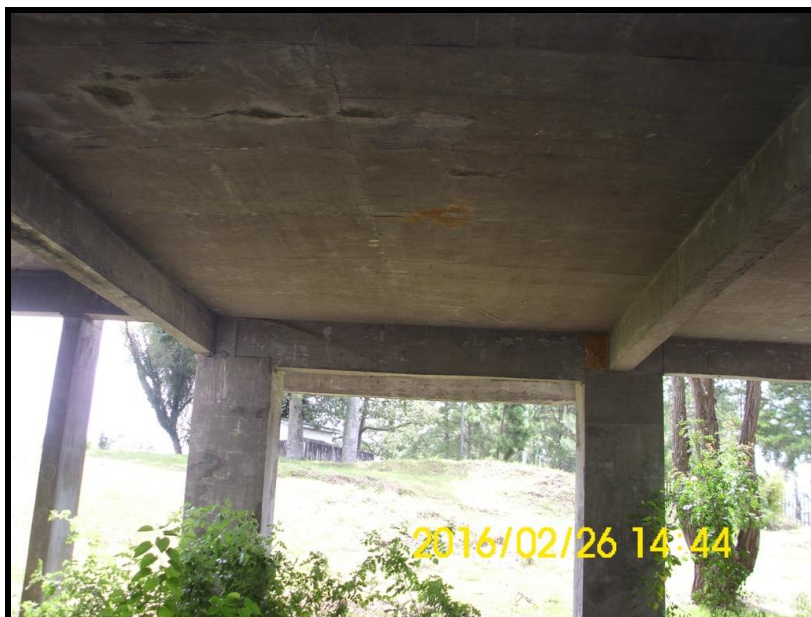
Foto 51 - 1º PAVIMENTO - Trinca em laje.
