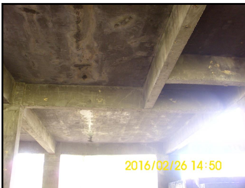
Foto 58 - 1º PAVIMENTO - Trinca transversal em laje e manchas de infiltração.
