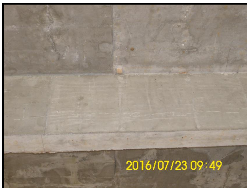
Foto 159 – 3º PAVIMENTO - Fissuras em viga.
