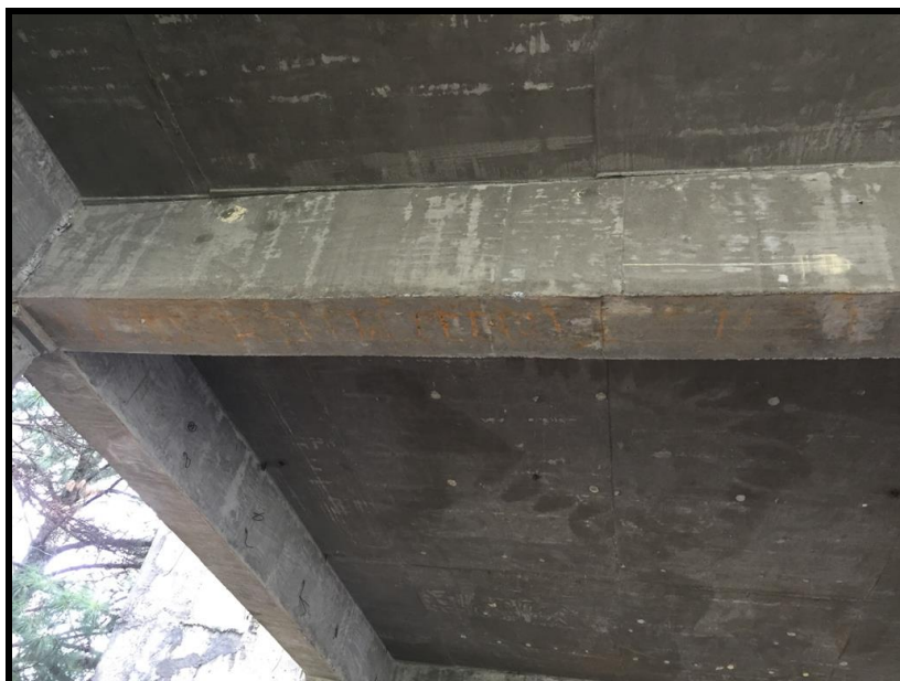
Foto 111 - 2º PAVIMENTO - Mapeamento de armadura devido pequeno cobrimento.
