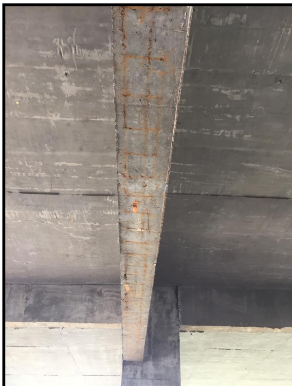
Foto 110 - 2º PAVIMENTO - Mapeamento de armadura devido pequeno cobrimento.
