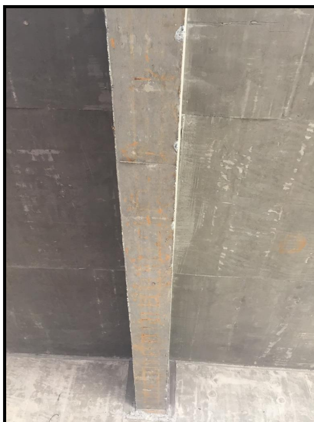
Foto 112 - 2º PAVIMENTO - Mapeamento de armadura devido pequeno cobrimento.
