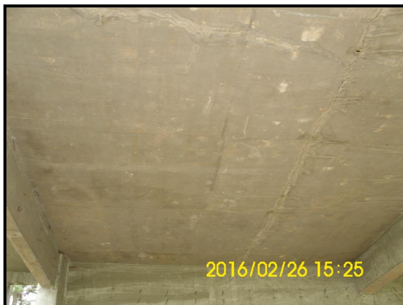
Foto 83 - 1º PAVIMENTO - Mapeamento de armadura devido pequeno cobrimento.
