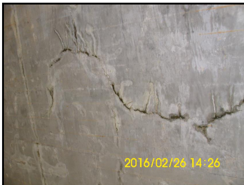
Foto 35 - 1º PAVIMENTO - Mapeamento de armadura e trinca longitudinal com manchas de infiltração.
