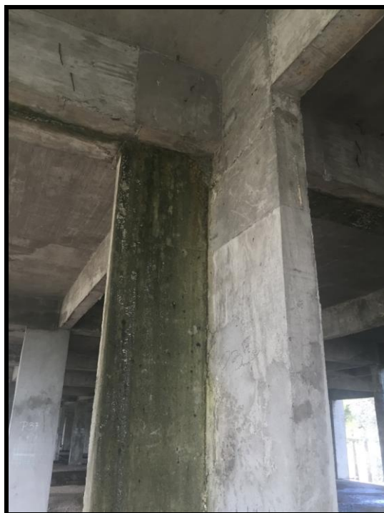
Foto 131 - 2º PAVIMENTO - Cultura de fungos e bolores em pilar devido infiltração através da junta de dilatação da estrutura.
