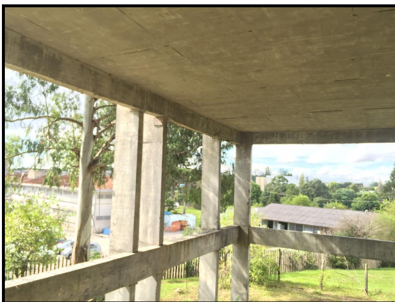
Foto 104 - 2º PAVIMENTO - Desaprumo em viga devido erro durante concretagem.
