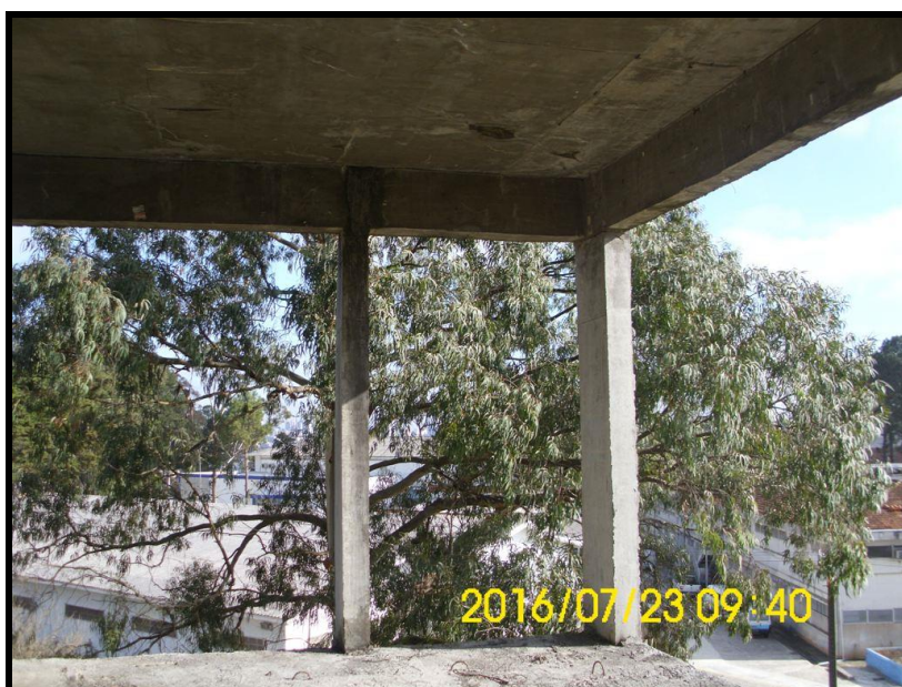
Foto 140 - 2º PAVIMENTO - Manchas de infiltrações em laje e pilar.
