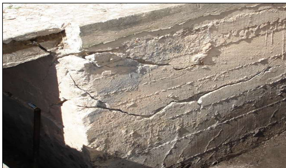
Figura 6. Expansão por reação álcali- agregado
