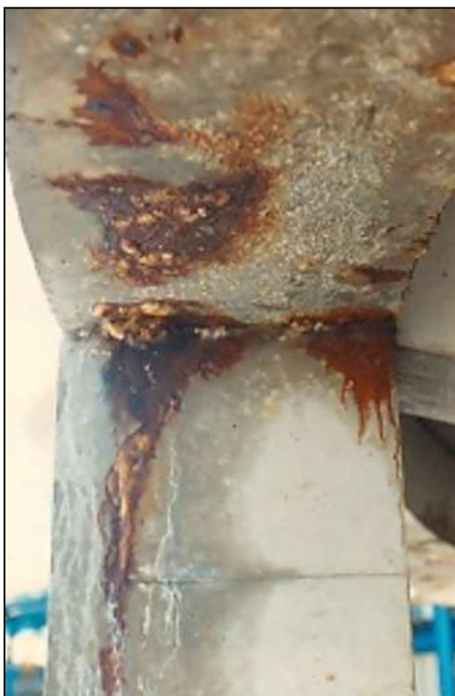
Figura 5. Corrosão de armadura, despassivação por cloreto Fonte: ( http://www.ibracon.org.br/eventos/55cbc/PDFS/phd.pdf ).
