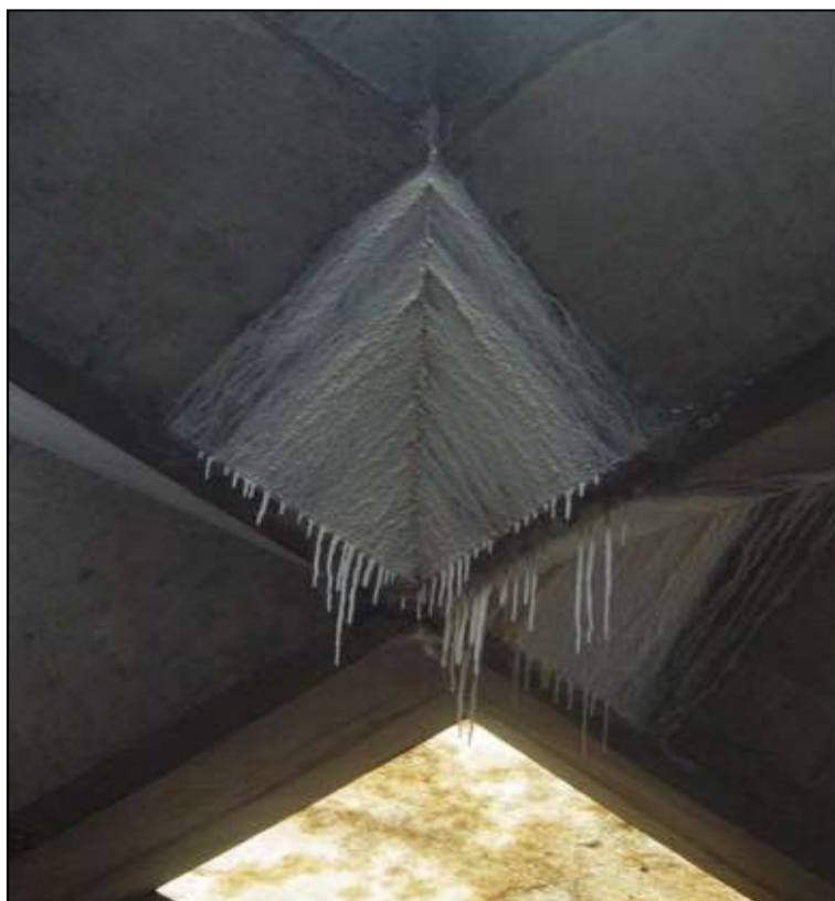
Figura 2: Lixiviação em estrutura de concreto, com formação de estalactite
