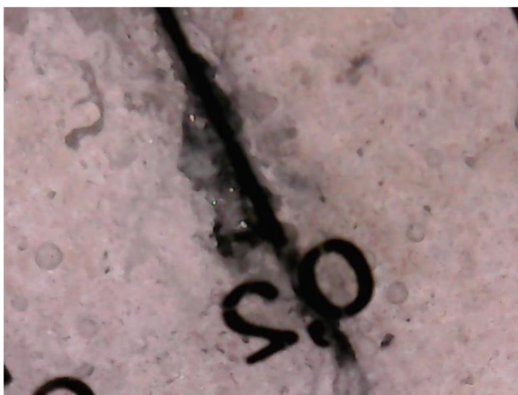
Figura 39 - Medida da fissura pelo fissurometro (acervo pessoal).
