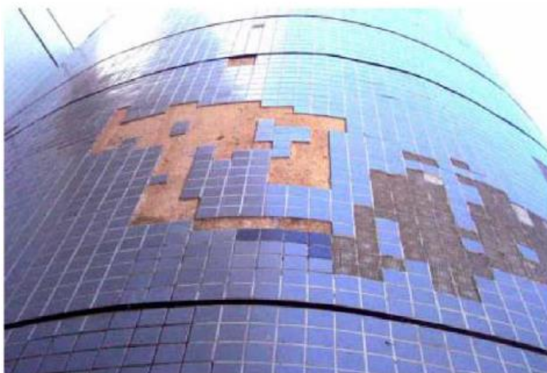
Figura 4. Destacamento do revestimento cerâmico da fachada (COMUNIDADE DA CONSTRUÇÃO, 2004 apud BRANDÃO, 2007)
