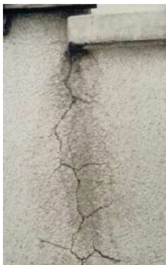
Figura 6 – Fissura por movimentação higroscopia.
