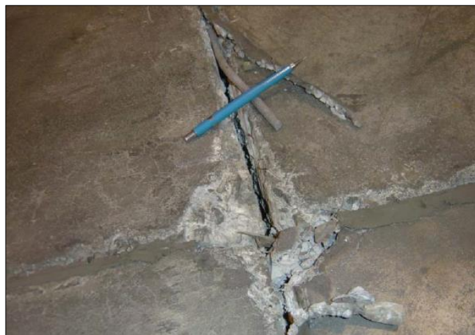
Figura 10. Esborcinamento de juntas em piso de concreto (CHODOUNSKY, 2010).
