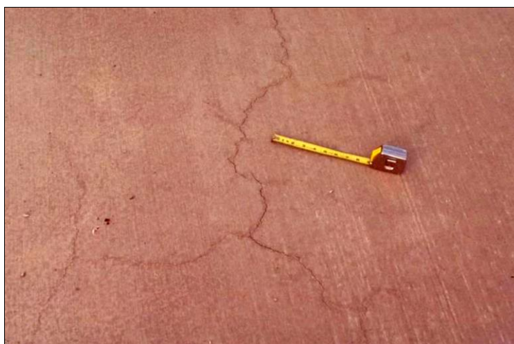
Figura 21. Fissuração por contração e retração térmica (GRANATO, 2014).
