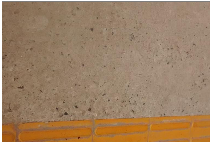
Figura 11. Desgaste por abrasão em piso de concreto (ROMERO, 2016).
