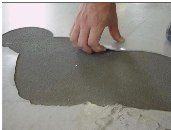
Figura 12. Manifestação patológica relacionada à umidade ascendente em piso de concreto (CHODOUNSKY, 2010).
