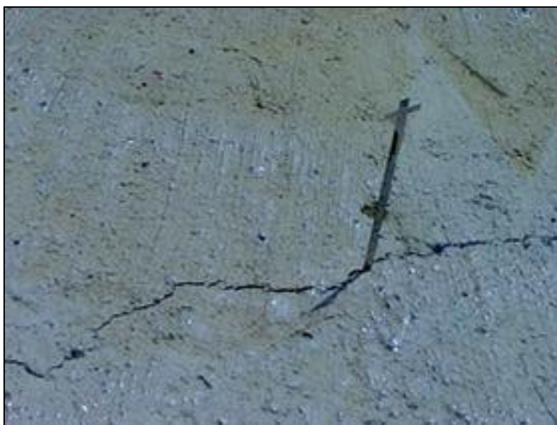
Figura 18. Fissuração tipicamente causada por retração plástica em um concreto recém-lançado em uma laje (ABCP, 2003).
