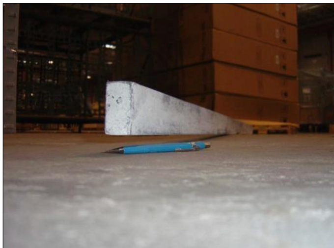
Figura 13. Empenamento de bordas em piso de concreto (CHODOUNSKY, 2010).
