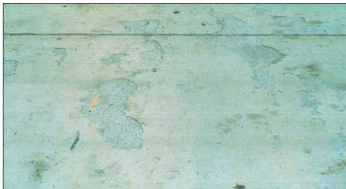
Figura 14. Delaminação em piso de concreto (CHODOUNSKY, 2010).
