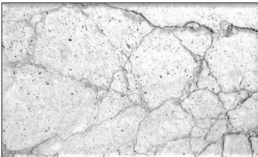
Figura 19. Fissuras de retração por secagem (ANAPRE, 2016).
