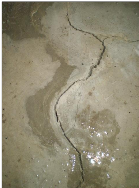
Figura 9. Fissura no concreto por retração (GRANATO, 2014).
