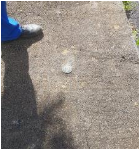
Figura 16 - Marco instalado em calçada sobre a barragem.
