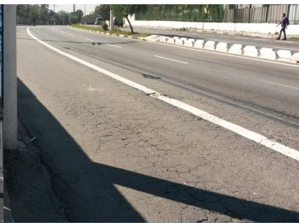
Foto 2 - Trincas interligadas tipo couro de jacaré, próximo à estaca 1.023+0,00
