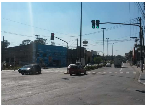
Foto 1 - Trecho inicial próximo ao cruzamento com a Rua General Florêncio, com alguns remendos e desgaste do revestimento
