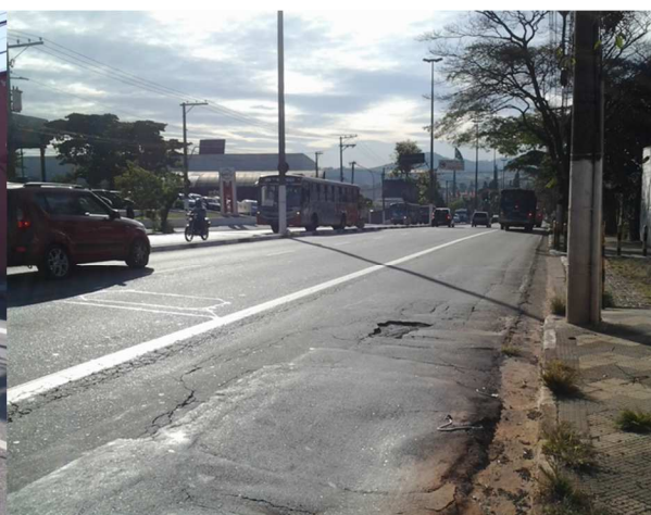
Foto 6 - Remendos e afundamentos plásticos na atual faixa de ônibus - próximo à estaca 1.146+0,00
