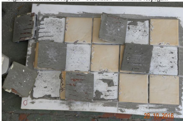
Figura 38: forma de ruptura – base latex – nenhuma raspagem
