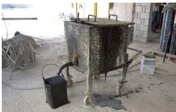
Figura 5: Caldeira para aquecimento do asfalto
