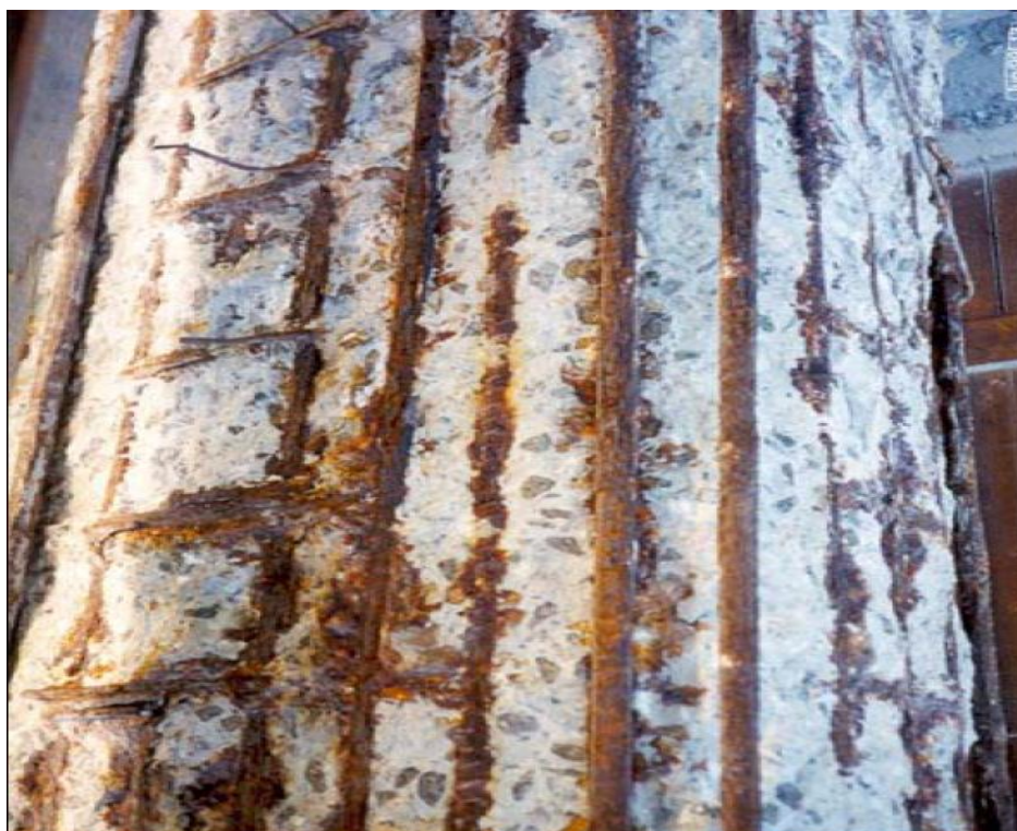
Figura 7 - Pilar sobre o mar após 10 anos de construção, deteriorado devido aos efeitos da interação da carbonatação com íons cloretos (AGUIAR, 2006)
