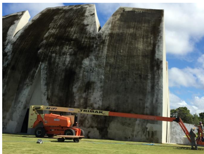
Figura 21: Vista da fachada principal (Anfiteatro) com manchas enegrecidas – Fonte: Arquivos de obra do Teatro L Occitane.
