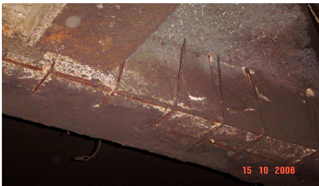
Figura 8 -Armação da viga com corrosão generalizada por carbonatação
