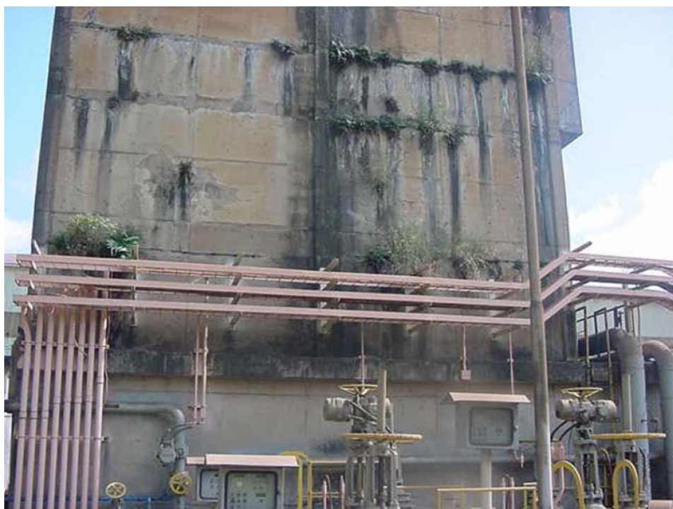
Figura 9 -Crescimento de raízes de plantas em fendas do concreto que deterioram a estrutura (AGUIAR, 2006)
