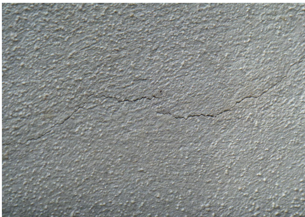
Figura 2 - Fissura no concreto devido à falta de cura.
