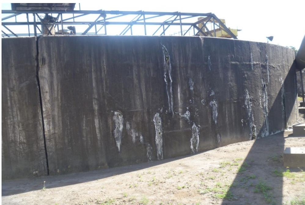
Figura 5 - Tanque com pontos de infiltração e pontos de eflorescência devido à lixiviação.
