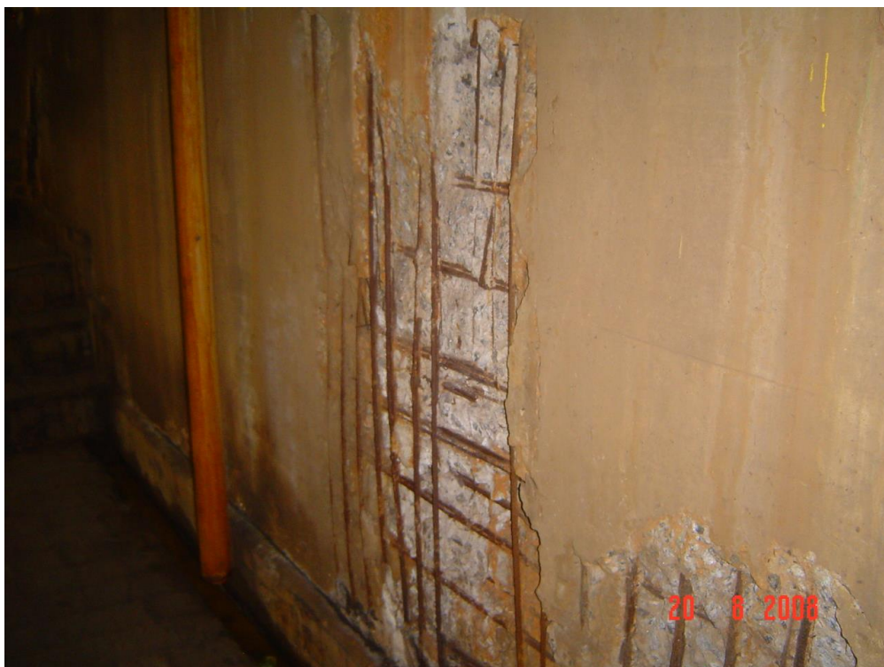
Figura 6 - Parede de concreto deteriorado pelo ácido clorídrico usado no processo industrial
