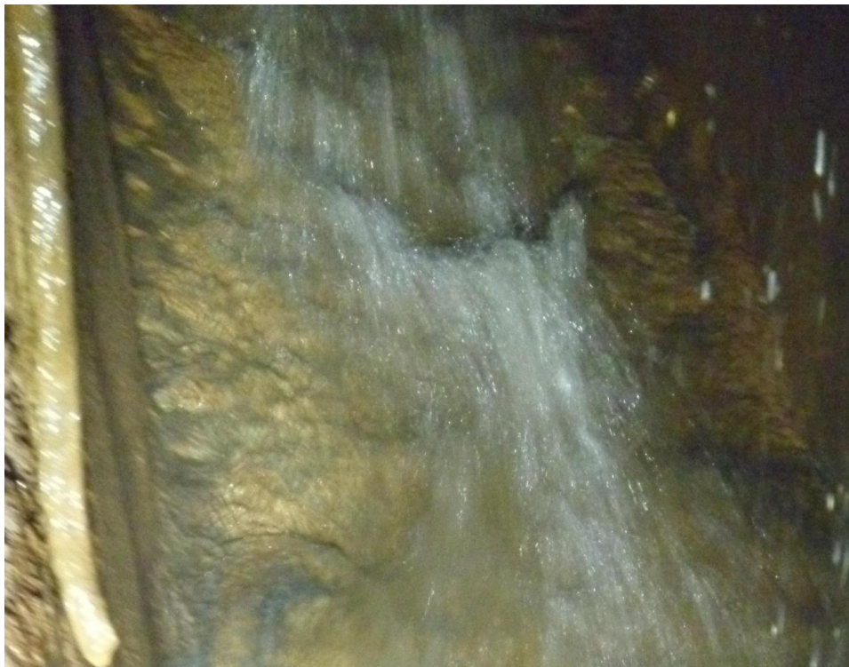
Figura 3 - Canal de escoamento de carepas de aço com o concreto desgastado.
