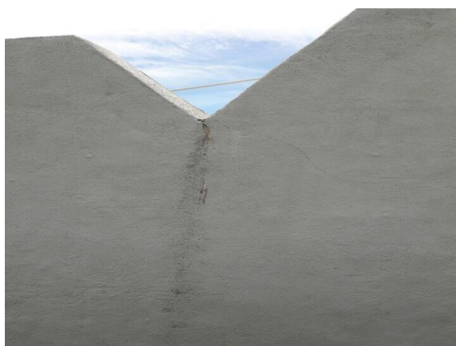
Figura 22: Vista da fachada principal (Anfiteatro) com manchas enegrecidas – Fonte: Arquivos de obra do Teatro L Occitane.
