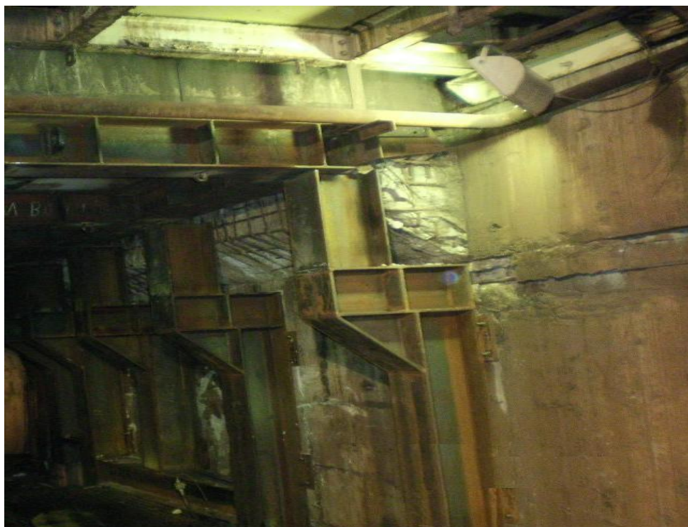
Figura 4 - Camada de cobrimento do console de apoio da laje totalmente destacado devido à passagem de material siderúrgico em alta temperatura.
