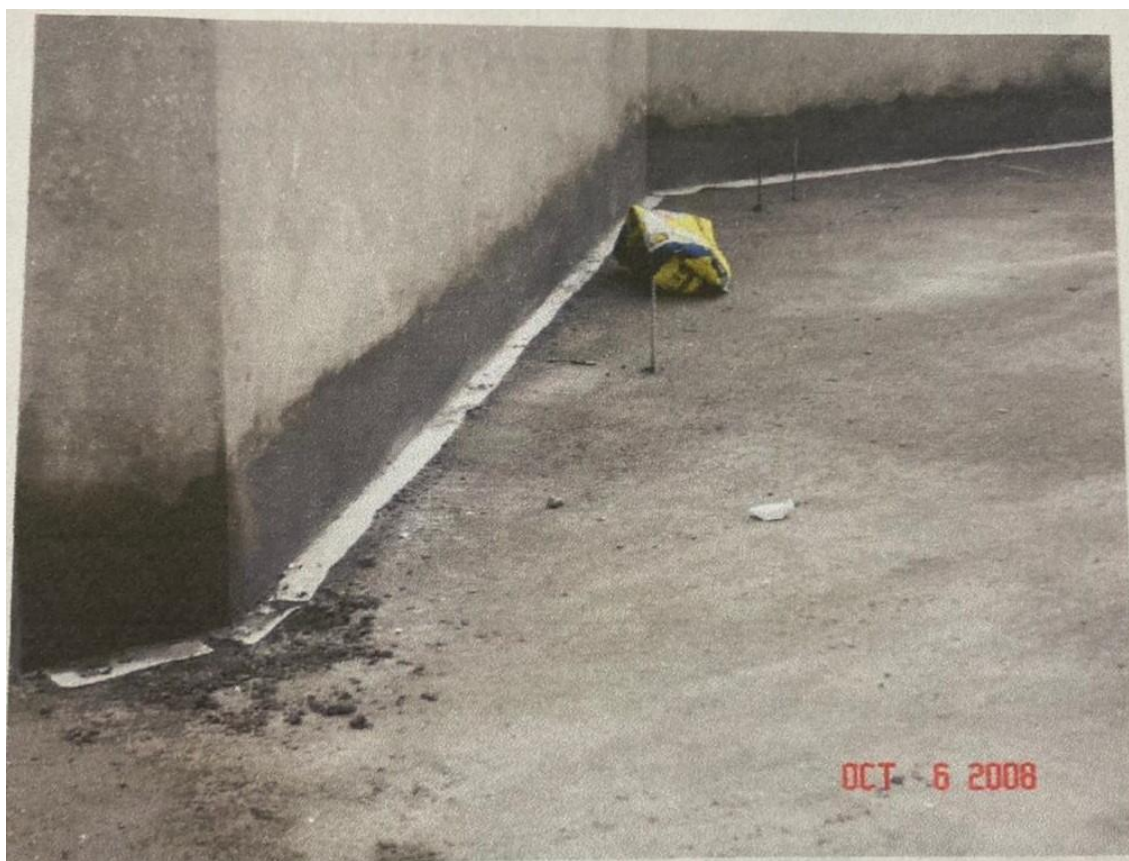
Figura 6: Detalhe de dilatação no reboco
