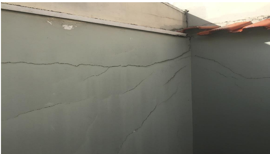
Figura 47. Fissuras horizontais e diagonais no revestimento argamassado (O autor, 2017)
