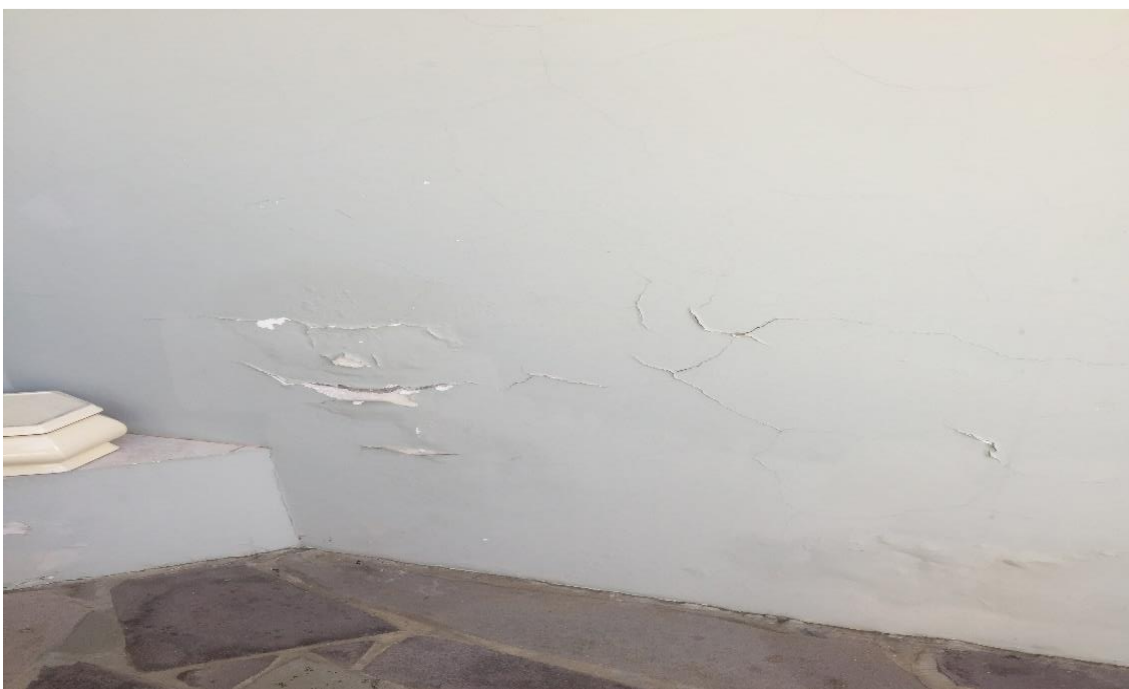
Figura 51. Má aderência, fissuras mapeadas e empolamento (O autor, 2017)
