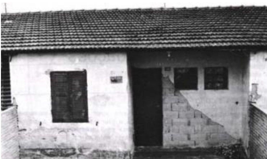
Figura 7. Descolamento em placas (CINCOTTO, 1988)
