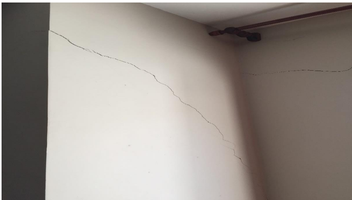
Figura 39. Trinca diagonal devido deformações diferenciadas (O autor, 2017)
