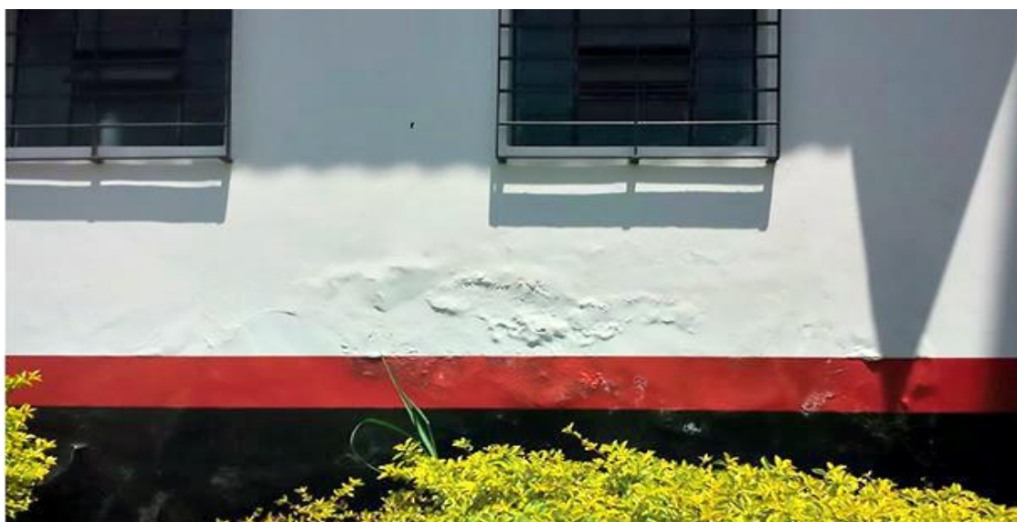
Figura 6. Descolamento com Empolamento (Caporrino - 2016)
