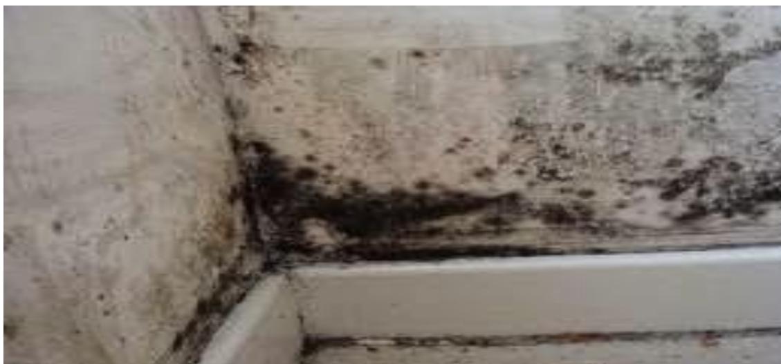
Figura 4. Proliferação de fungos (Construtora Vion)
