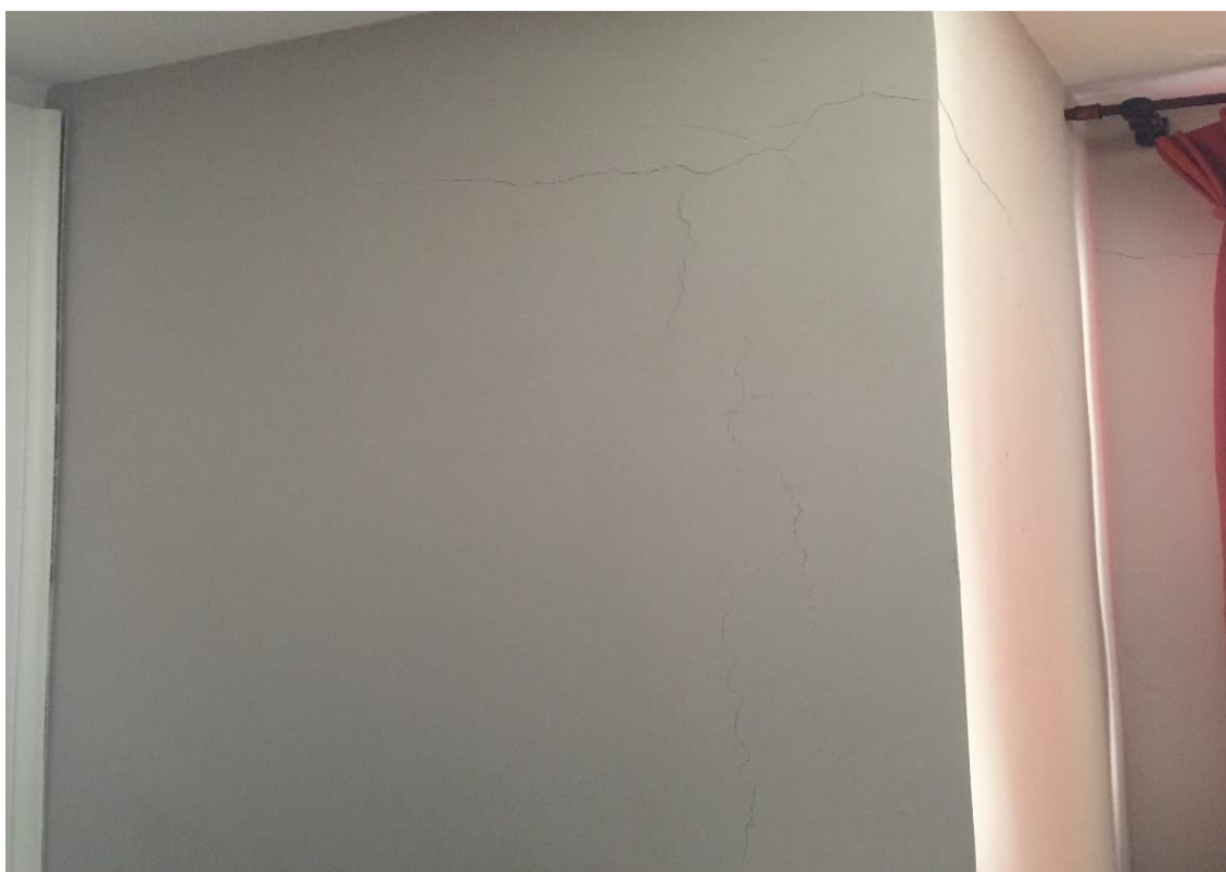
Figura 38. Fissuras horizontais devido deformações diferenciadas (O autor, 2017)
