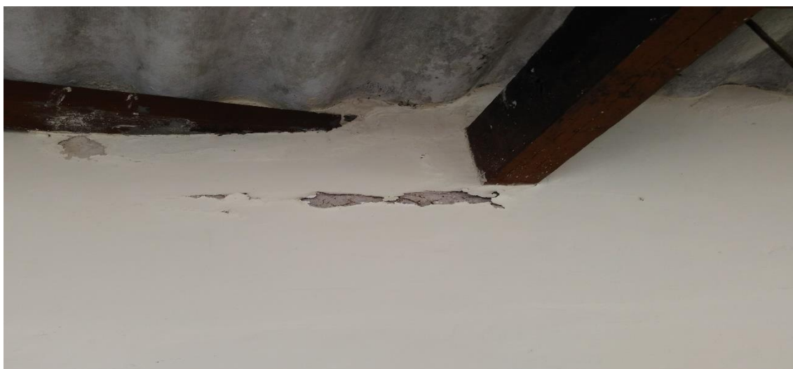
Figura 8. Descolamento com Pulverulência (O autor, 2017)
