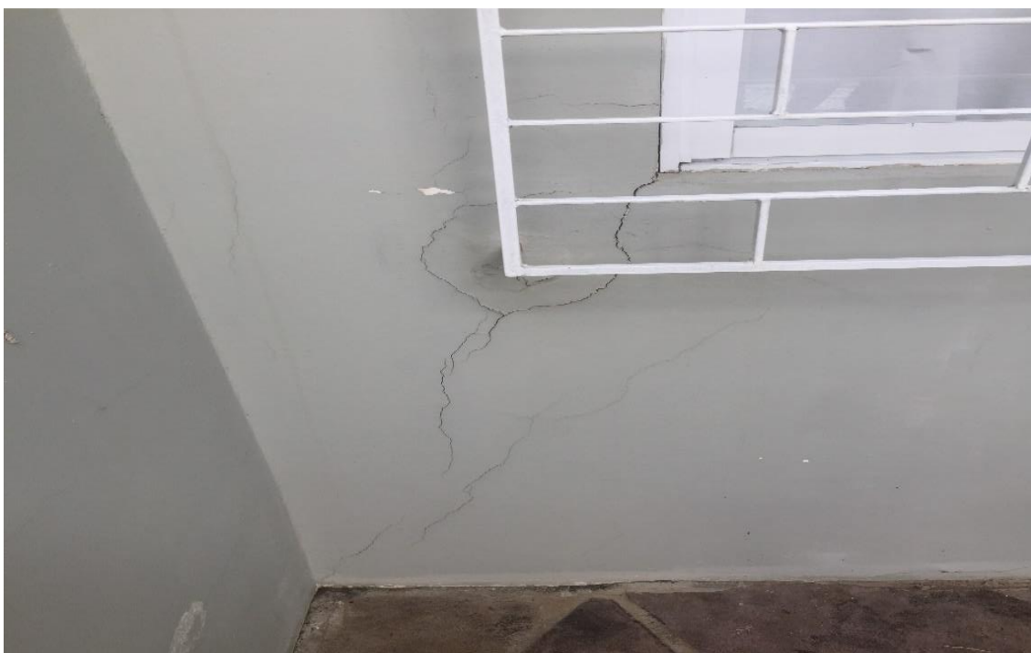
Figura 43. Trinca diagonal próximo a parte inferior da janela (O autor, 2017)
