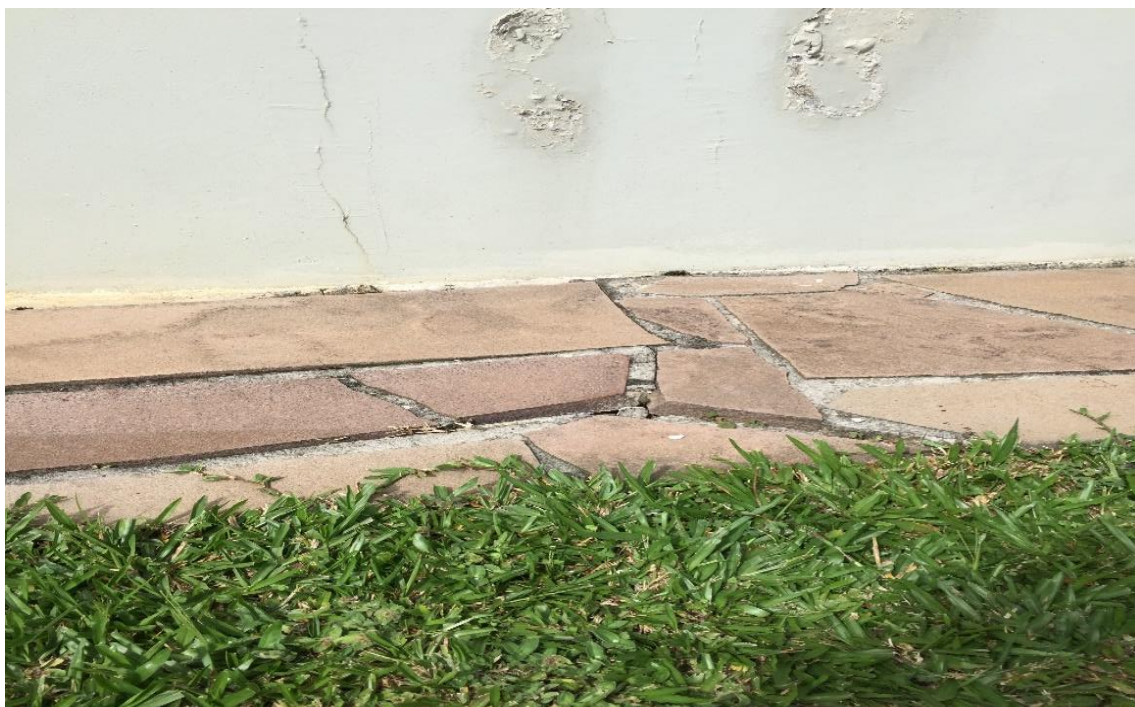
Figura 46. Dilatação térmica em piso devido a variação de temperatura (O autor, 2017)
