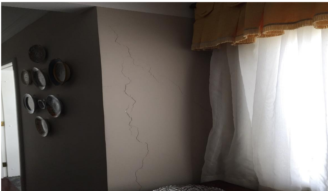
Figura 32. Trincas em alvenaria provocadas por recalque da fundação (O autor, 2017)
