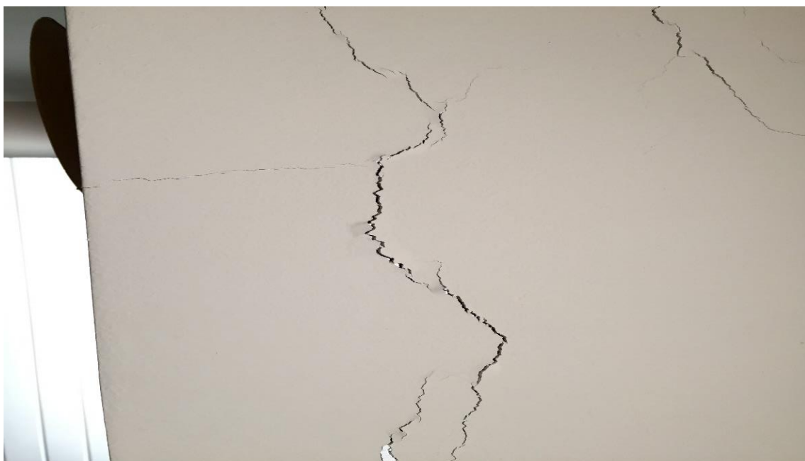
Figura 34. Trincas em alvenaria provocadas por recalque da fundação (O autor, 2017)
