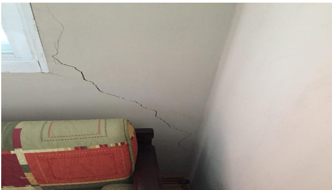
Figura 41. Rachadura diagonal próximo a parte inferior da janela (O autor, 2017)
