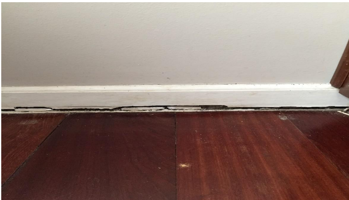
Figura 35. Descolamento em rodapé provocadas por recalque da fundação (O autor, 2017)
