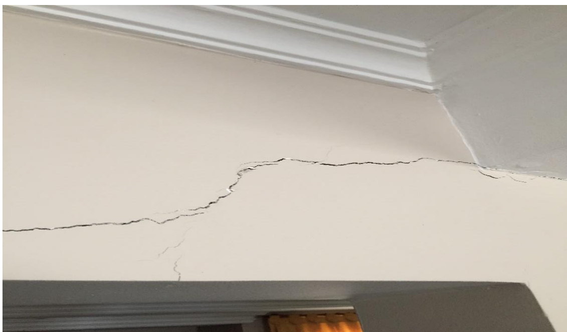
Figura 37. Trinca em alvenaria provocada por ação do peso da laje influenciando na viga (O autor, 2017)
