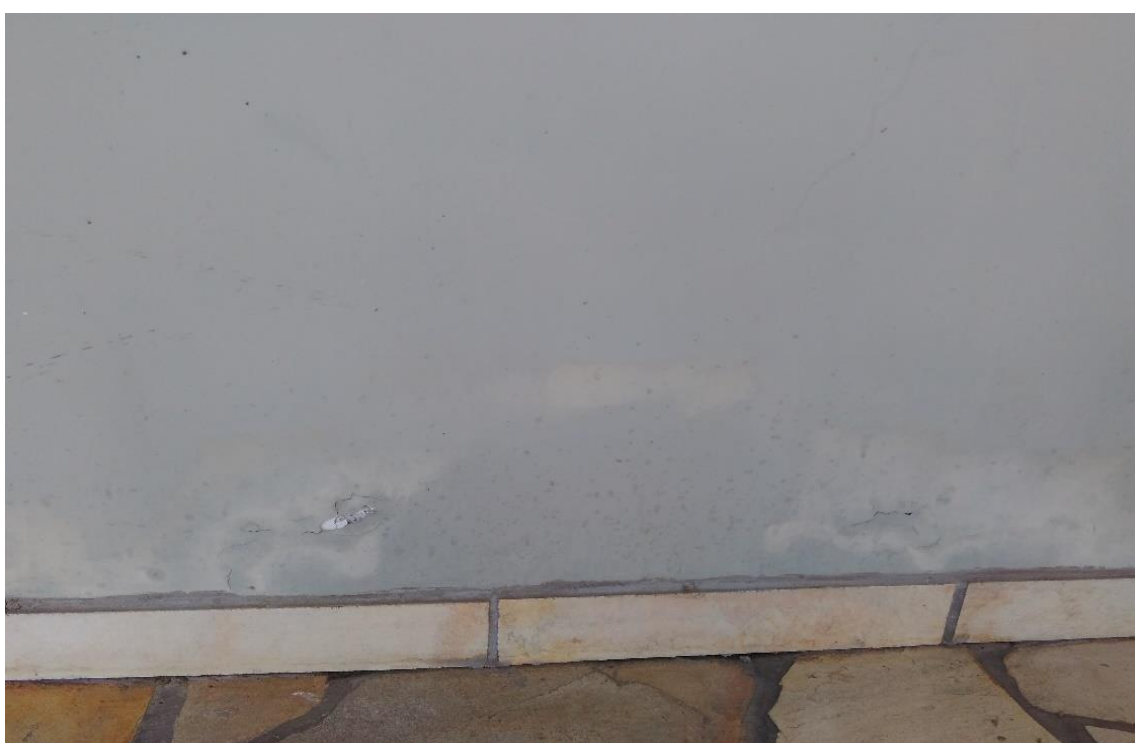
Figura 52. Manchas de umidade na base da parede em estágio inicial (O autor, 2017)
