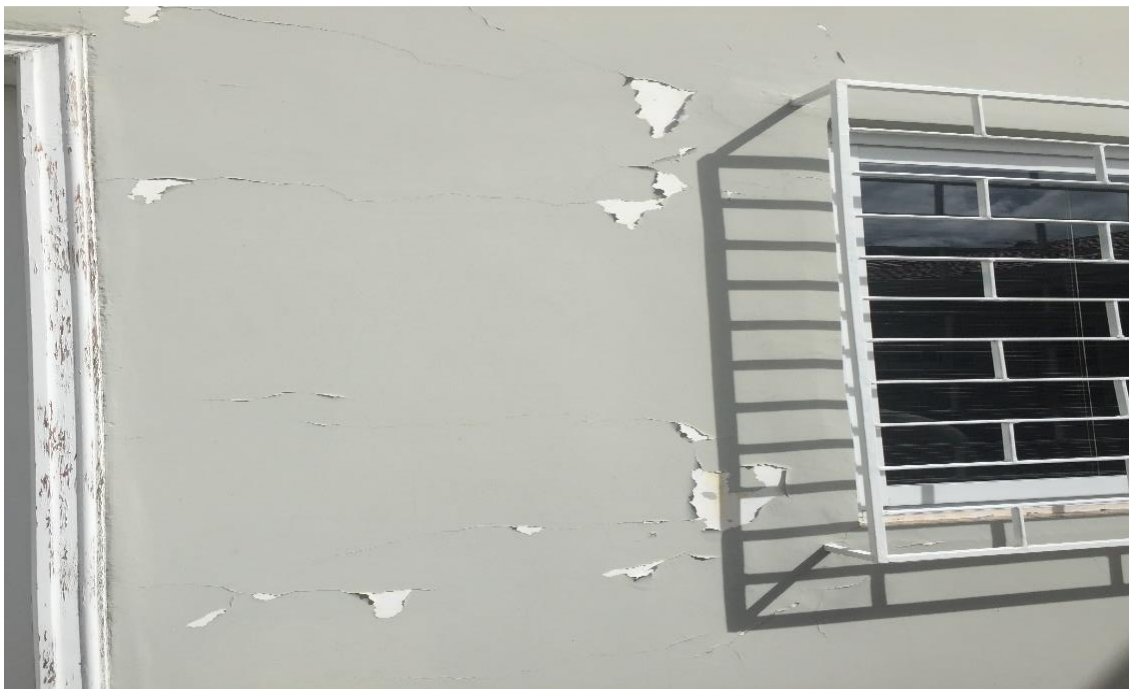
Figura 50. Má aderência da pintura em alvenaria (O autor, 2017)
