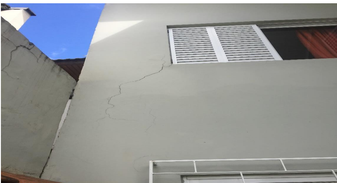
Figura 42. Trinca diagonal próximo a parte inferior da janela na parte externa (O autor, 2017)
