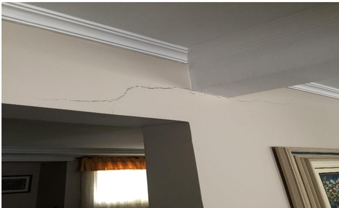
Figura 36. Trinca em alvenaria provocada por ação do peso da laje influenciando na viga (O autor, 2017)
