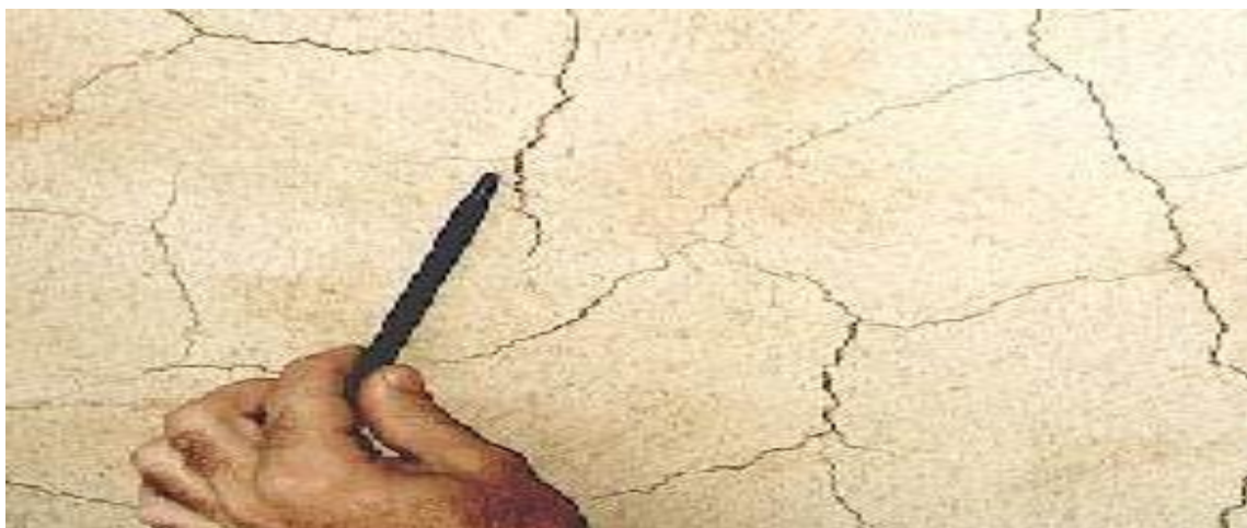
Figura 10. Fissuras mapeadas (IBDA, 2017)
