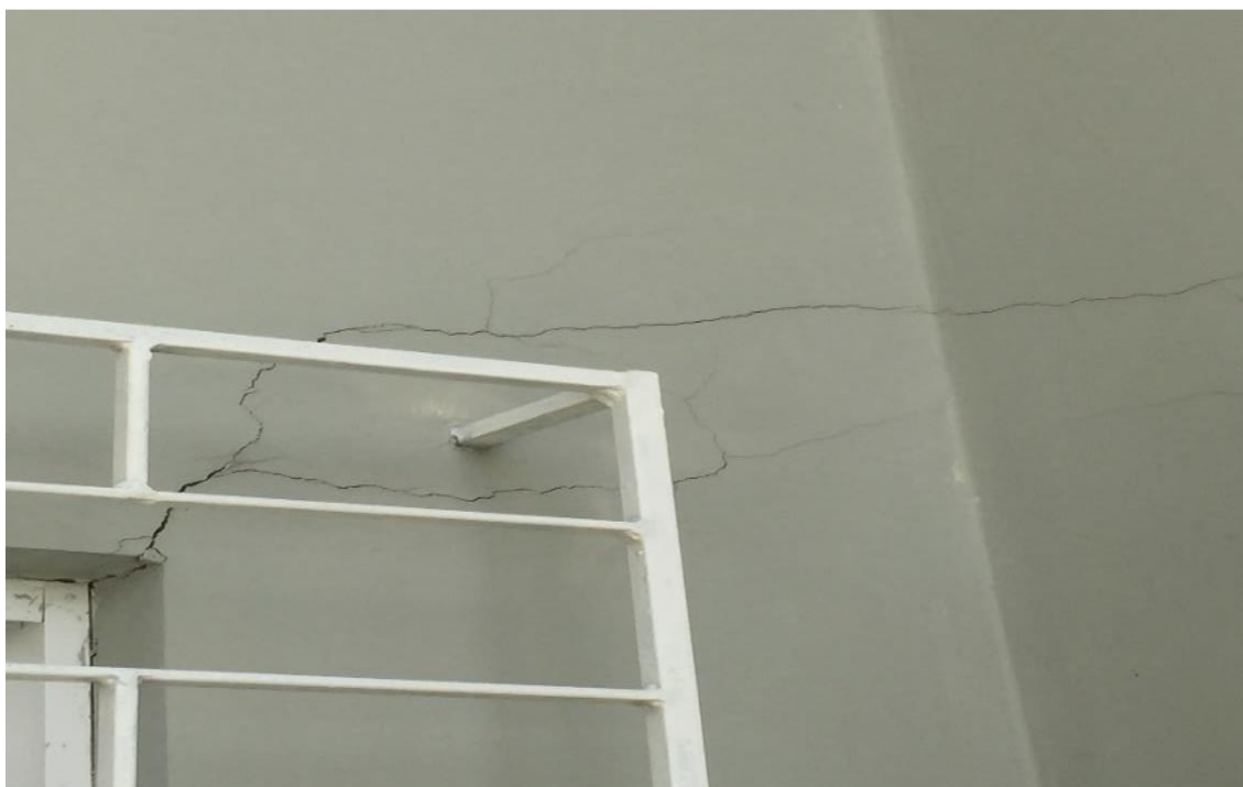
Figura 44. Trinca diagonal próximo a parte superior da janela (O autor, 2017)
