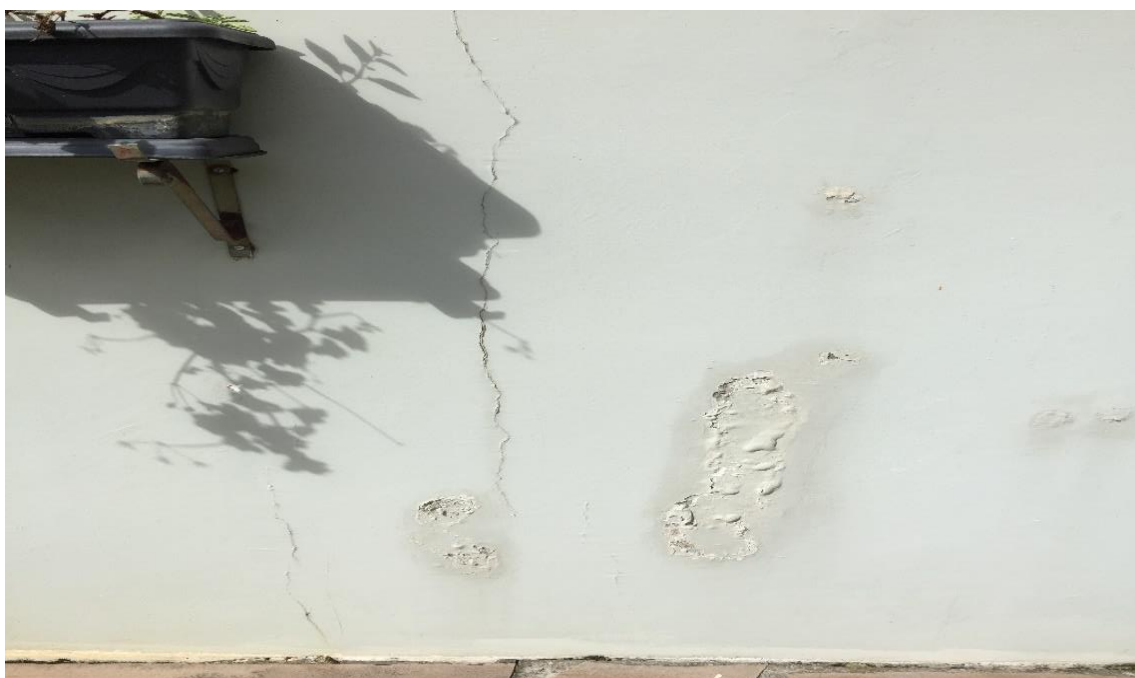
Figura 45. Fissura vertical e deslocamentos por empolamento (O autor, 2017)
