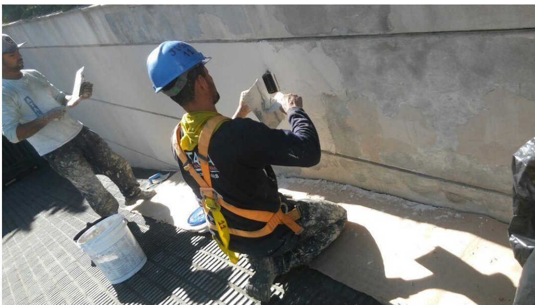
Figure 15 - Aplicação de revestimento sintético como massa niveladora, provavelmente irá gerar transparência - Fonte: autores
