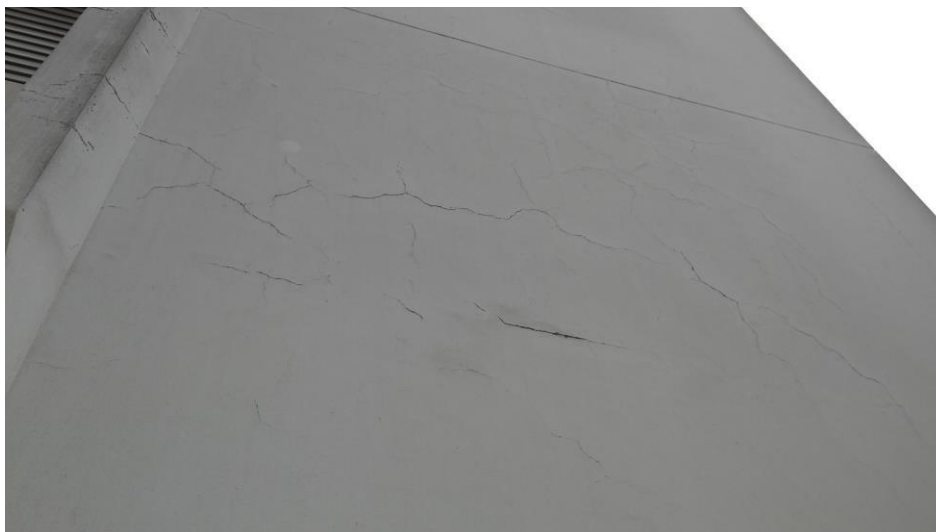
Figure 13 - Fissuras - Fonte: autores
