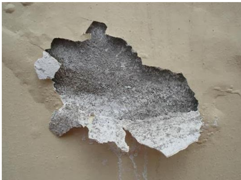
Figure 12 - Efflorescência - Fonte: autores
