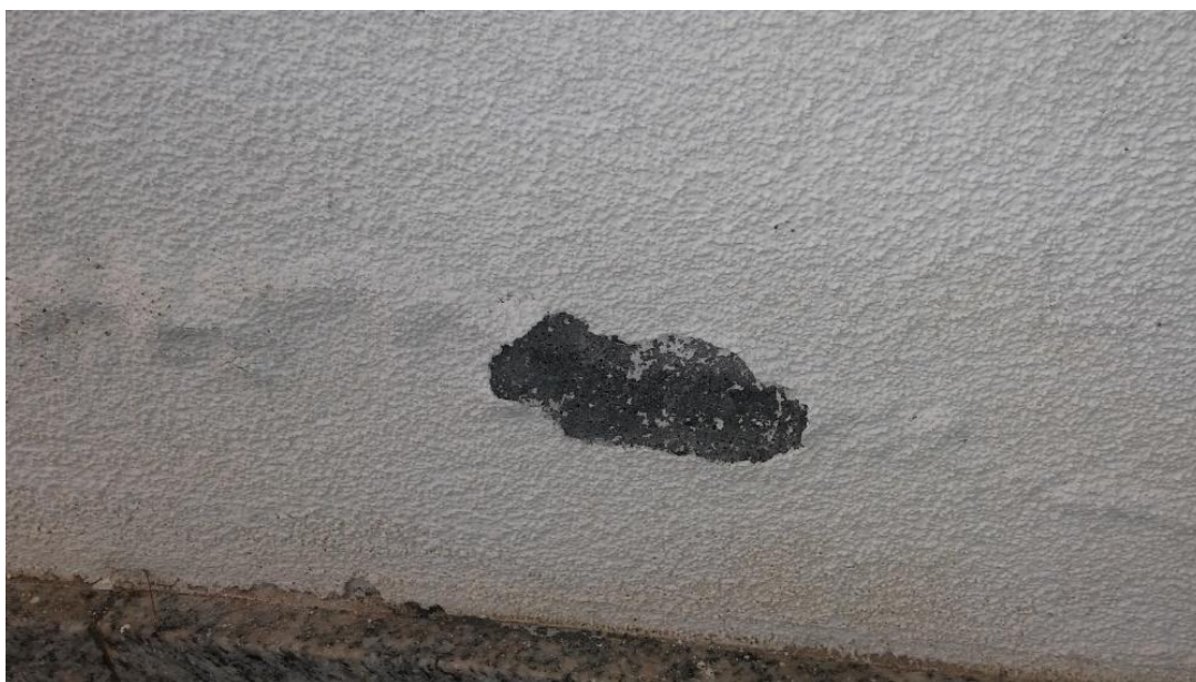
Figure 7 - Descolamento - Fonte: autores
