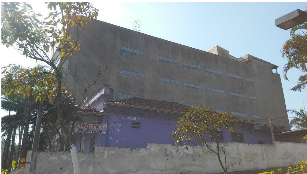
Figure 16 - Escurecimento do revestimento
