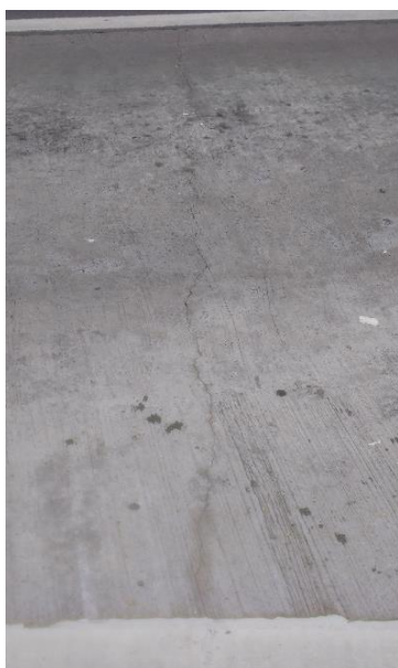
Figura 11 – Fissura transversal – Grau de severidade baixo – Placa 2A
