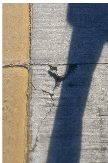
Figura 18 – Quebra de canto – Grau de severidade baixo – Placa 30B
