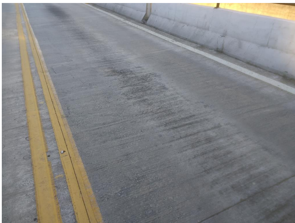
Figura 21 – Desgaste superficial – Grau de severidade único – Placa 9B
