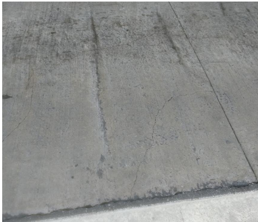
Figura 19 – Fissura de canto – Grau de severidade baixo – Placa 2A
