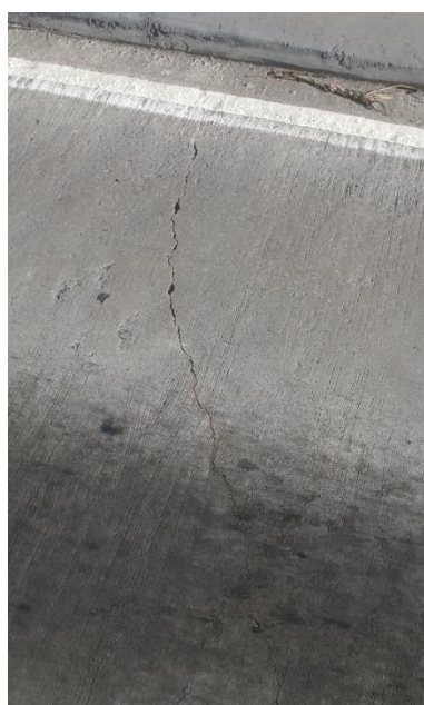
Figura 12 – Fissura transversal – Grau de severidade moderado – Placa 34B
