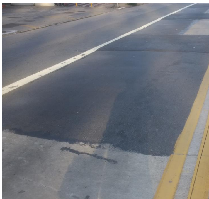
Figura 23 – Grande reparo – Grau de severidade baixo – 14A
