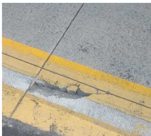
Figura 16 – Quebra de canto – Grau de severidade baixo – placa 12A
