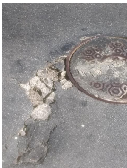
Figura 26- -Quebra localizada – Grau de severidade moderado – Placa 79A
