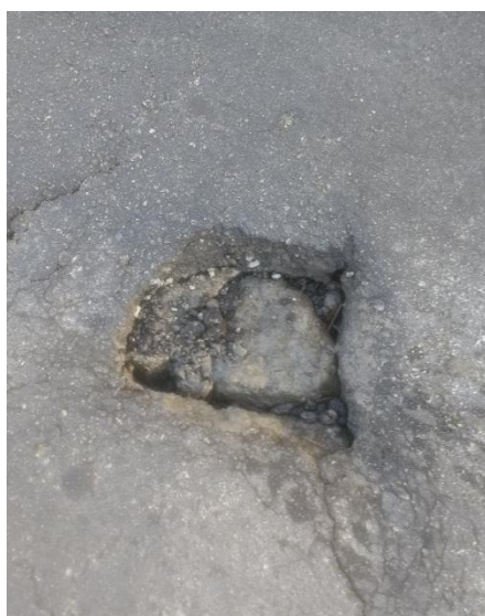
Figura 25 – Quebra localizada – Grau de severidade moderada – Placa 13A
