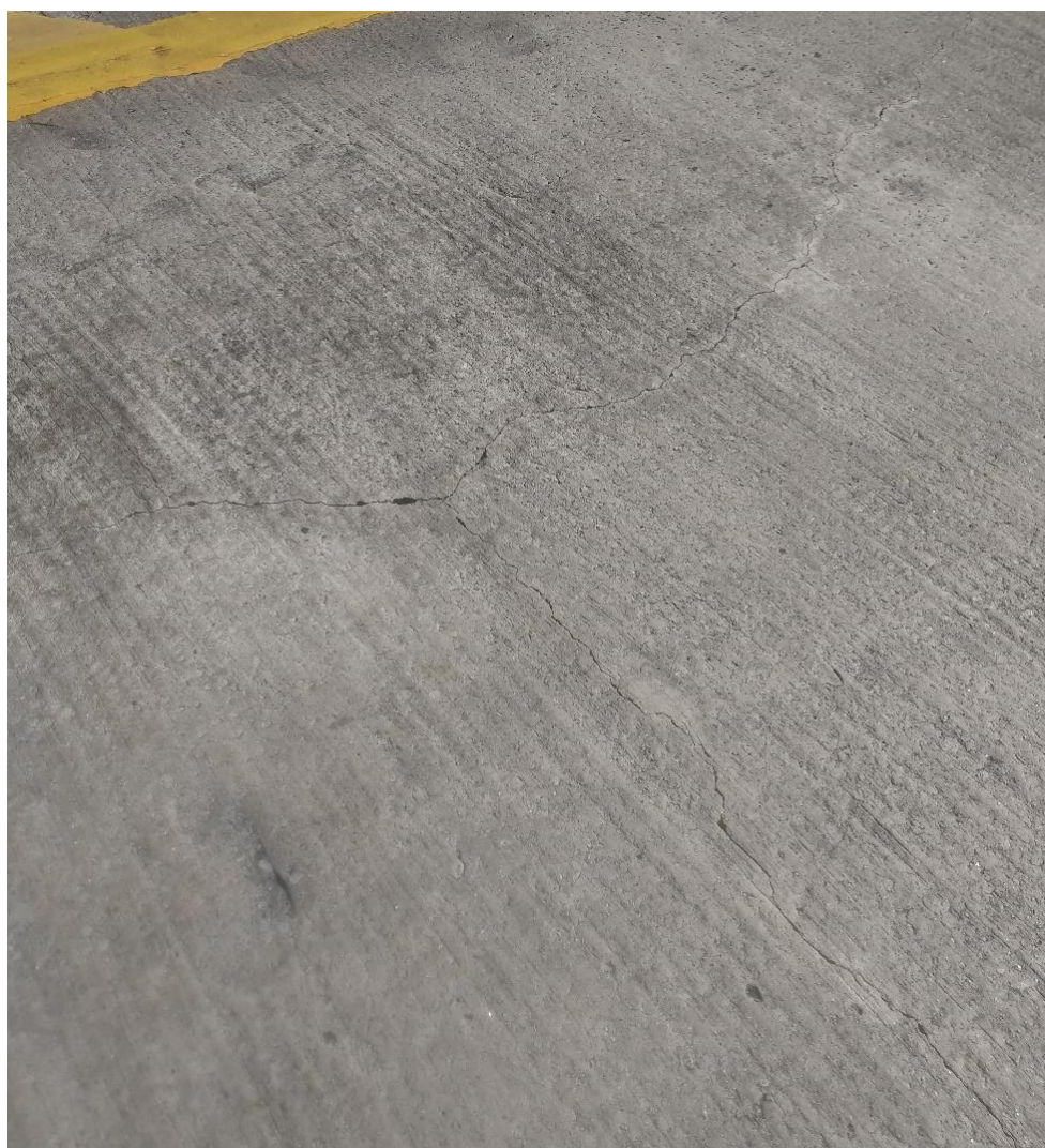
Figura 29 – Placa dividida – Grau de severidade baixo – Placa 35A
