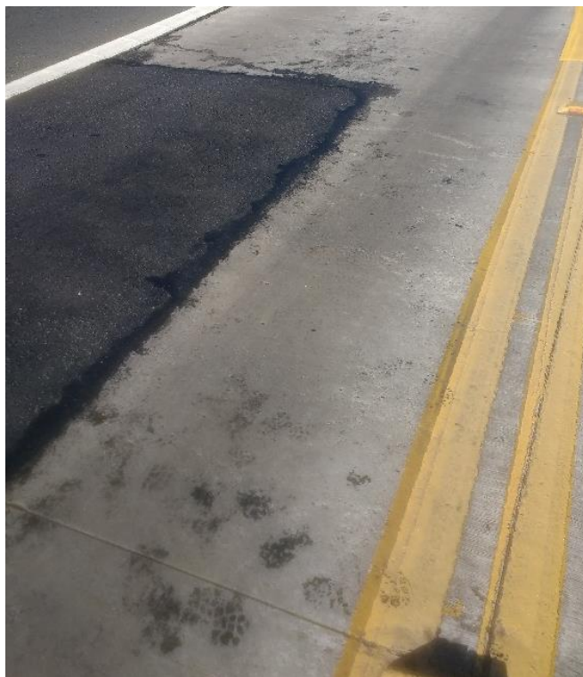
Figura 24 – Pequenos reparos – Grau de severidade baixo – Placa 18A
