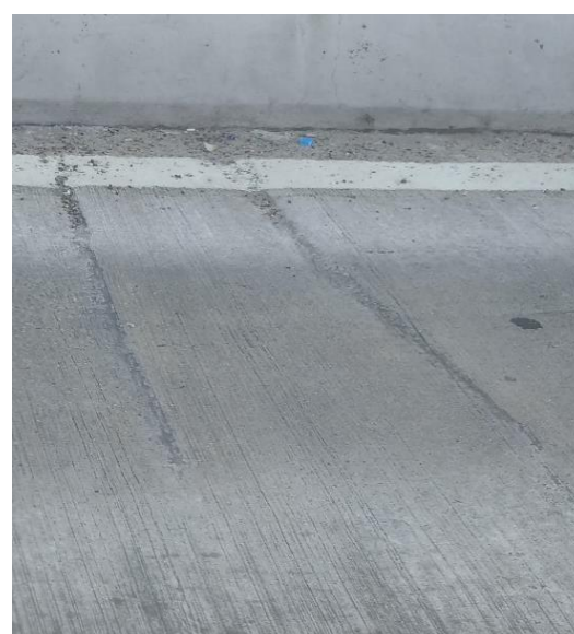
Figura 14 – Fissuras transversais paralelas – Grau de severidade moderado – Placa 12B
