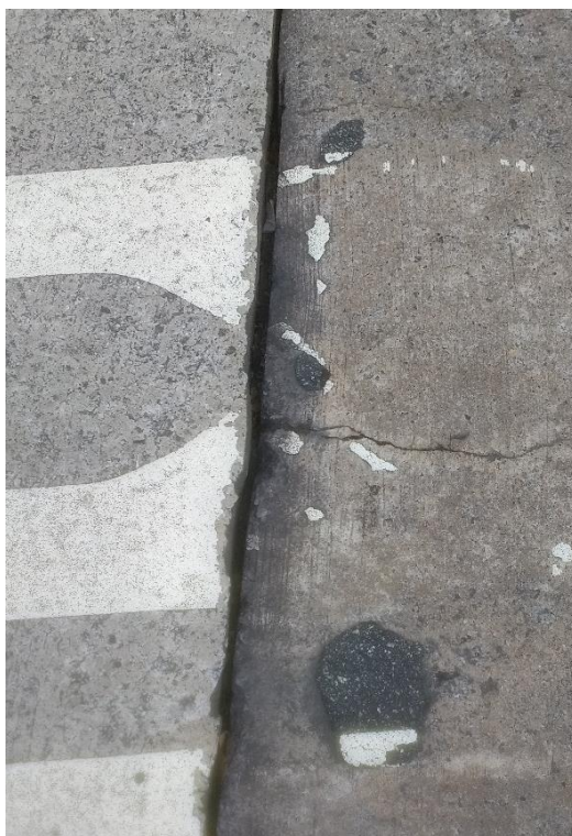
Figura 10 – Degrau na junta – Grau de severidade moderado – Placa 1B
