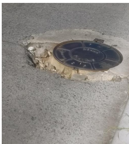
Figura 28 – Quebra localizada – Grau de severidade alto – Placa 69A
