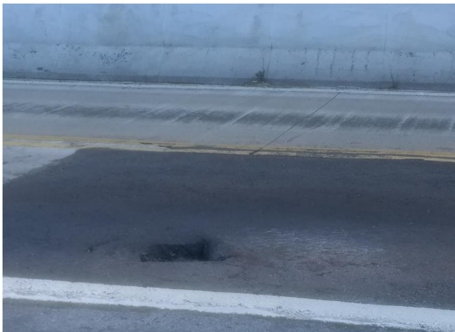
Figura 22 – Grandes reparos – Grau de severidade alto – Placa 13A
