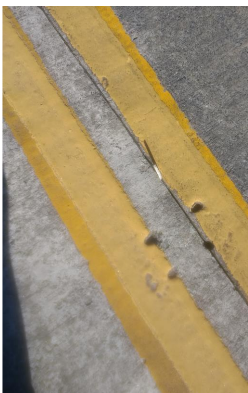
Figura 33 – Falha na selagem das juntas – Grau de severidade alto – Ruptura do selante
