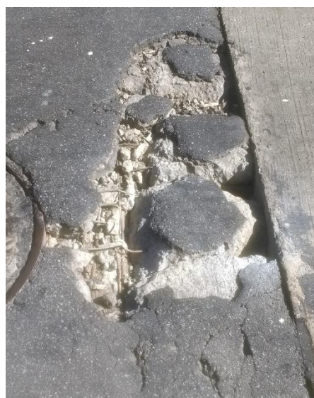
Figura 27 – Quebra localizada – Grau de severidade alto – Placa 83B
