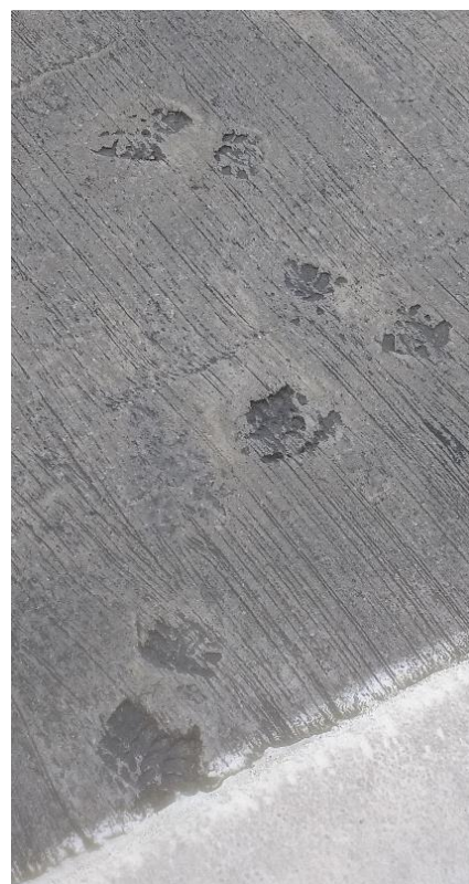
Figura 36 – Marcas sobre a superfície do pavimento – Placa 7B
