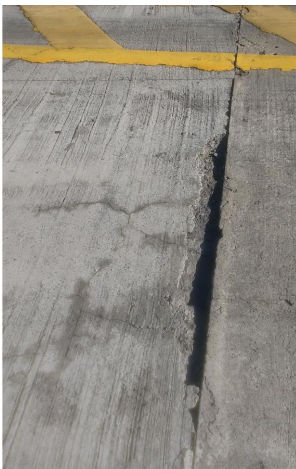
Figura 32 – Esborcinamento das juntas – Grau de severidade alto – Placa 39B
