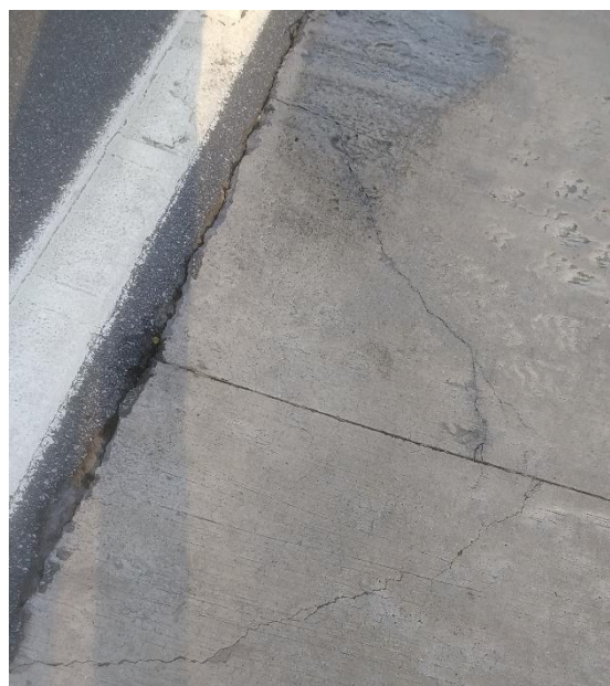
Figura 20 - -Fissura de canto – Grau de severidade moderado – Placa 10 a
