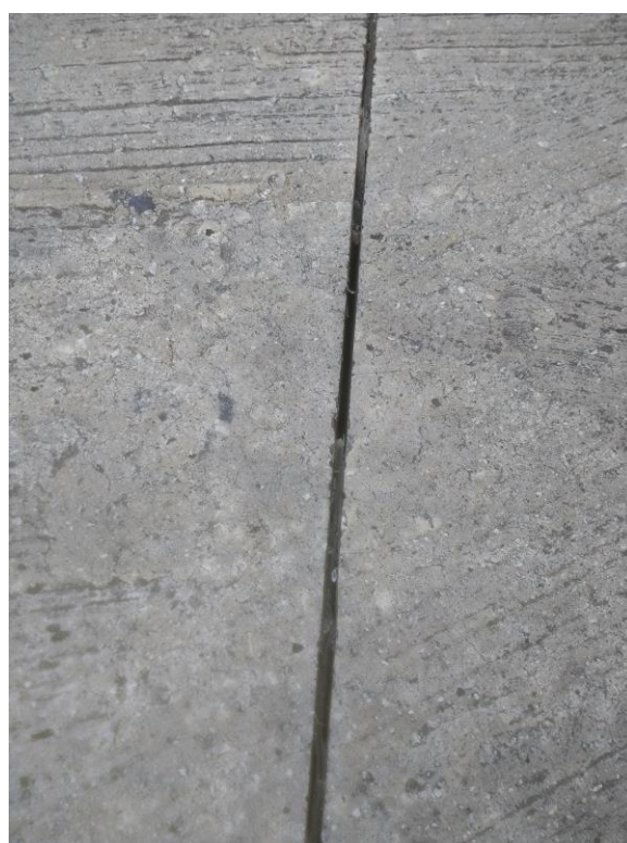
Figura 34 – Falha na selagem das juntas – Grau de severidade alto – Ausência de selante
