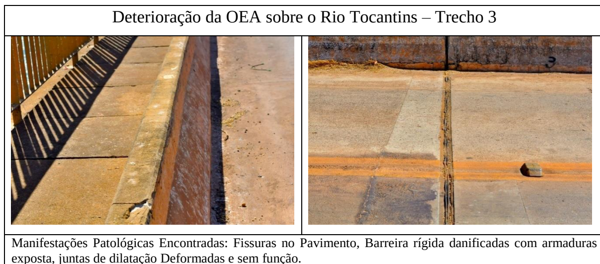
Quadro 5 - Deterioração do Trecho 3
