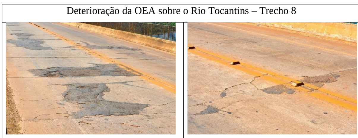
Quadro 10 - Deterioração do Trecho 8
