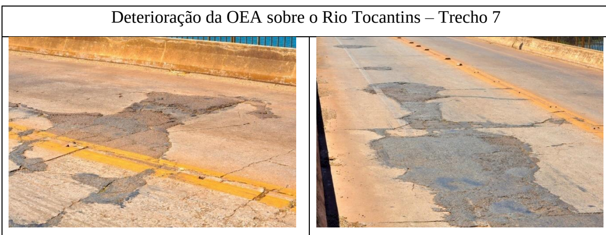
Quadro 9 - Deterioração do Trecho 7
