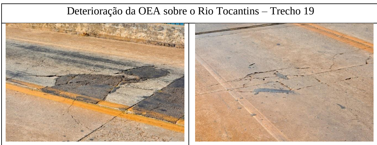
Quadro 21 - Deterioração do Trecho 19
