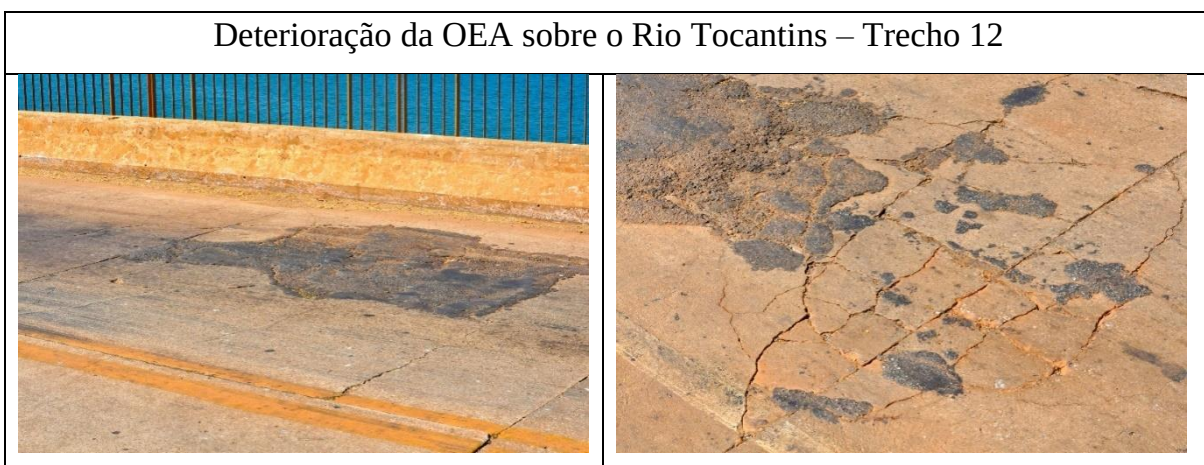
Quadro 14 - Deterioração do Trecho 12
