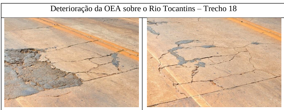
Quadro 20 - Deterioração do Trecho 18
