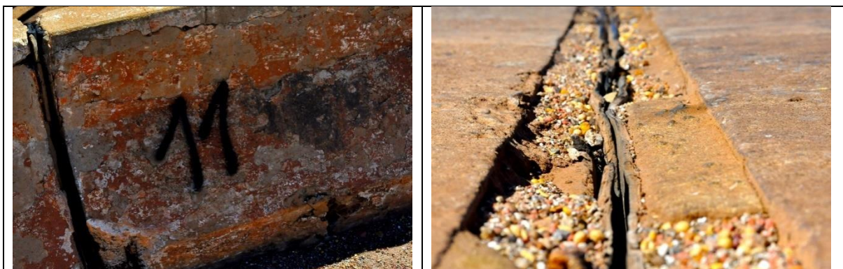
Manifestações Patológicas Encontradas: Fissuras no Pavimento, Barreira rígida danificadas com armaduras exposta, juntas de dilatação Deformadas e sem função.
