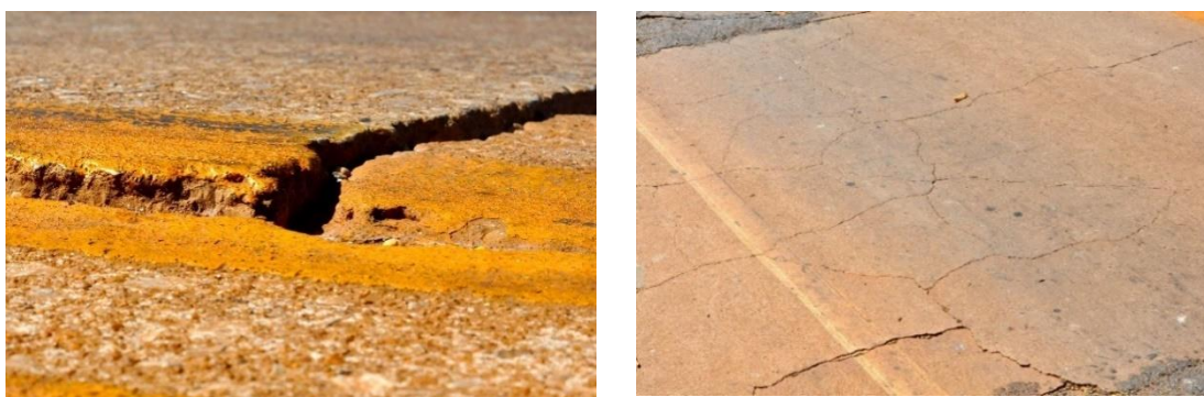
Figura 8 – Fendas e Fissuras, pavimento em concreto
