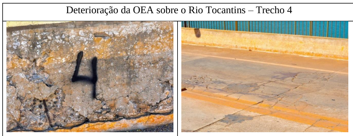
Quadro 6 - Deterioração do Trecho 4
