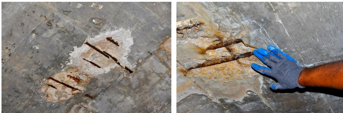
Figura 9 –Desplacamento do concreto por corrosão
