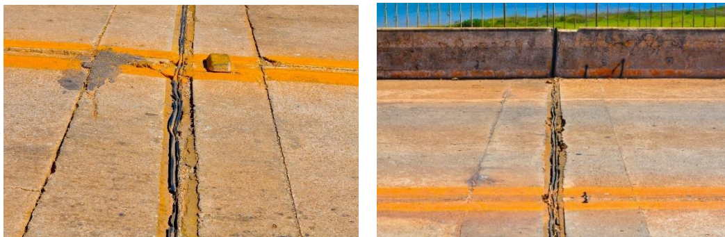
Figura 10 - Desgastes das Juntas de Movimentação, falta de manutenção
