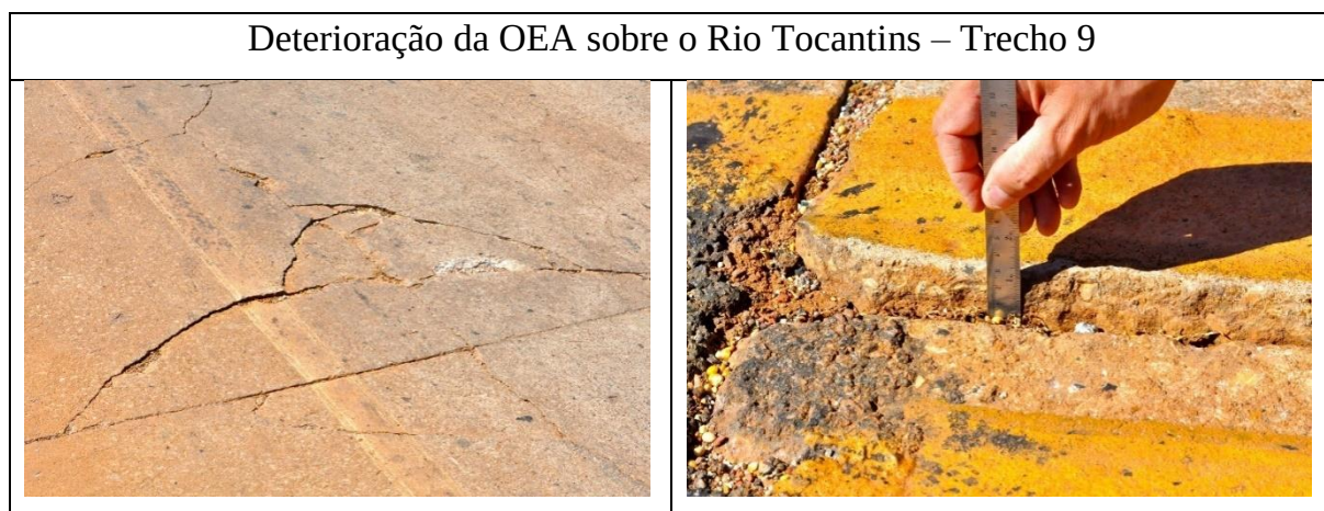
Quadro 11 - Deterioração do Trecho 9
