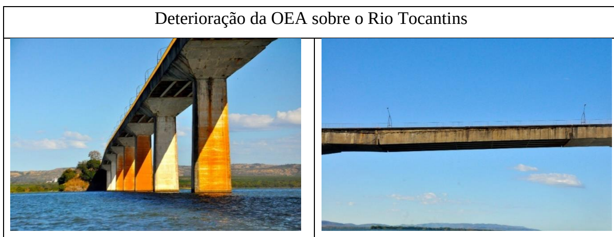
Quadro 32 - Manifestações Patológicas Estruturais
