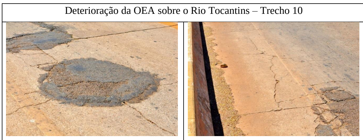
Quadro 12 - Deterioração do Trecho 10
