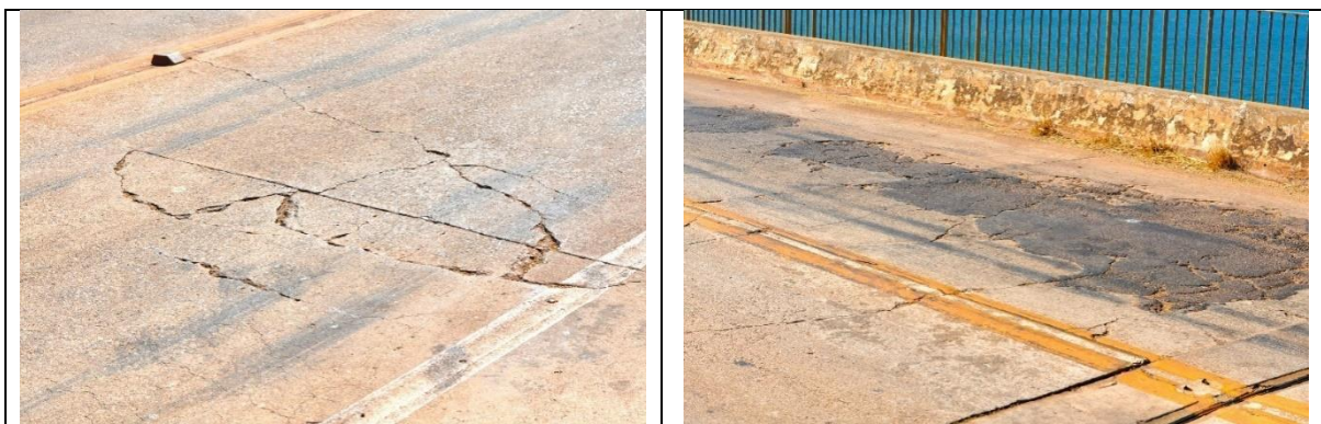
Manifestações Patológicas Encontradas: Fissuras no Pavimento, juntas de dilatação Deformadas e sem função.
