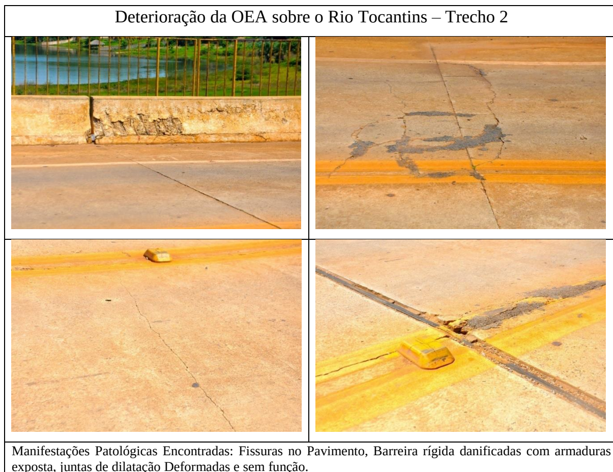
Quadro 4 - Deterioração do Trecho 2
