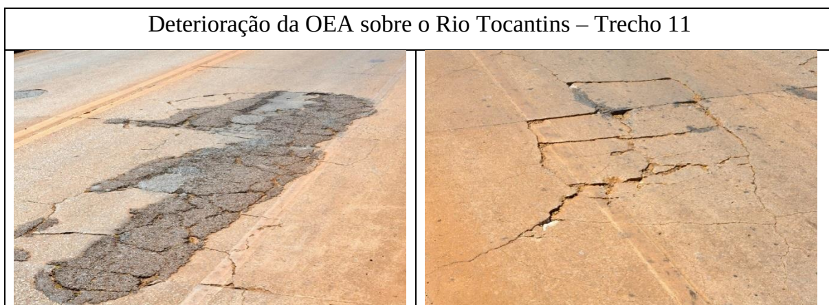
Quadro 13 - Deterioração do Trecho 11
