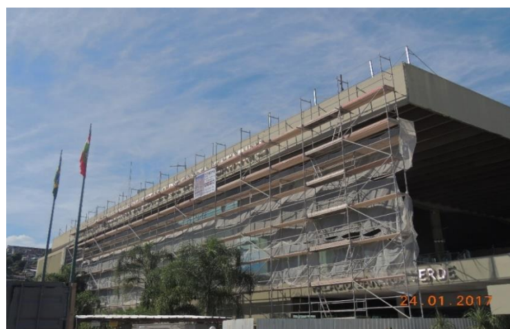
Figura 15. Infraestrutura montada na platibanda nordeste (AUTORES, 2017)
