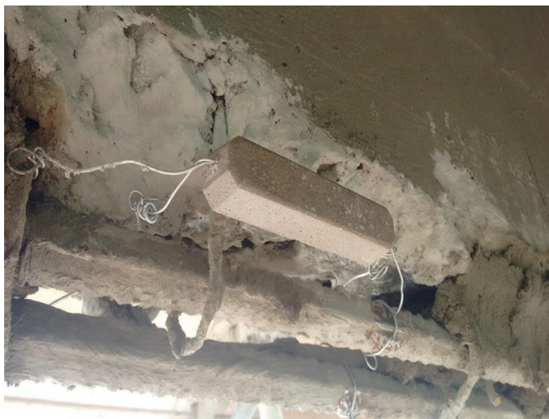
Figura 41. Anodo de sacrifício instalado na estrutura (AUTORES, 2017)
