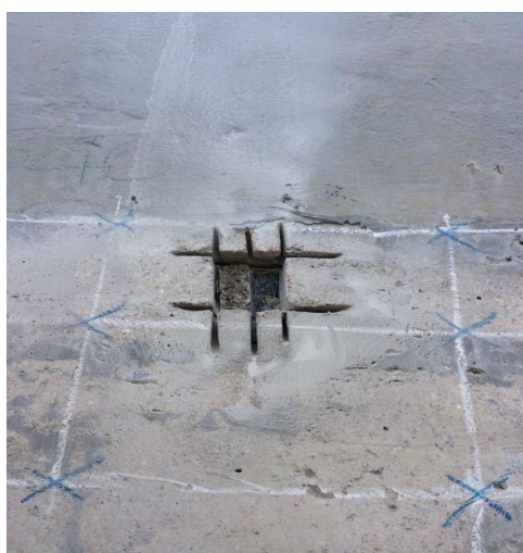
Figura 24. Ensaio de Carbonatação (AUTORES, 2017)
